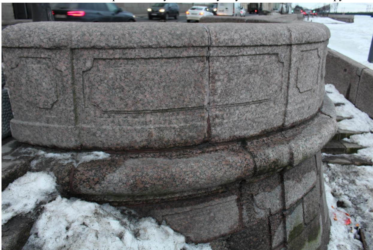
Фото 10. Вид на северо-восточную сторону парапета террасы-балкона.
