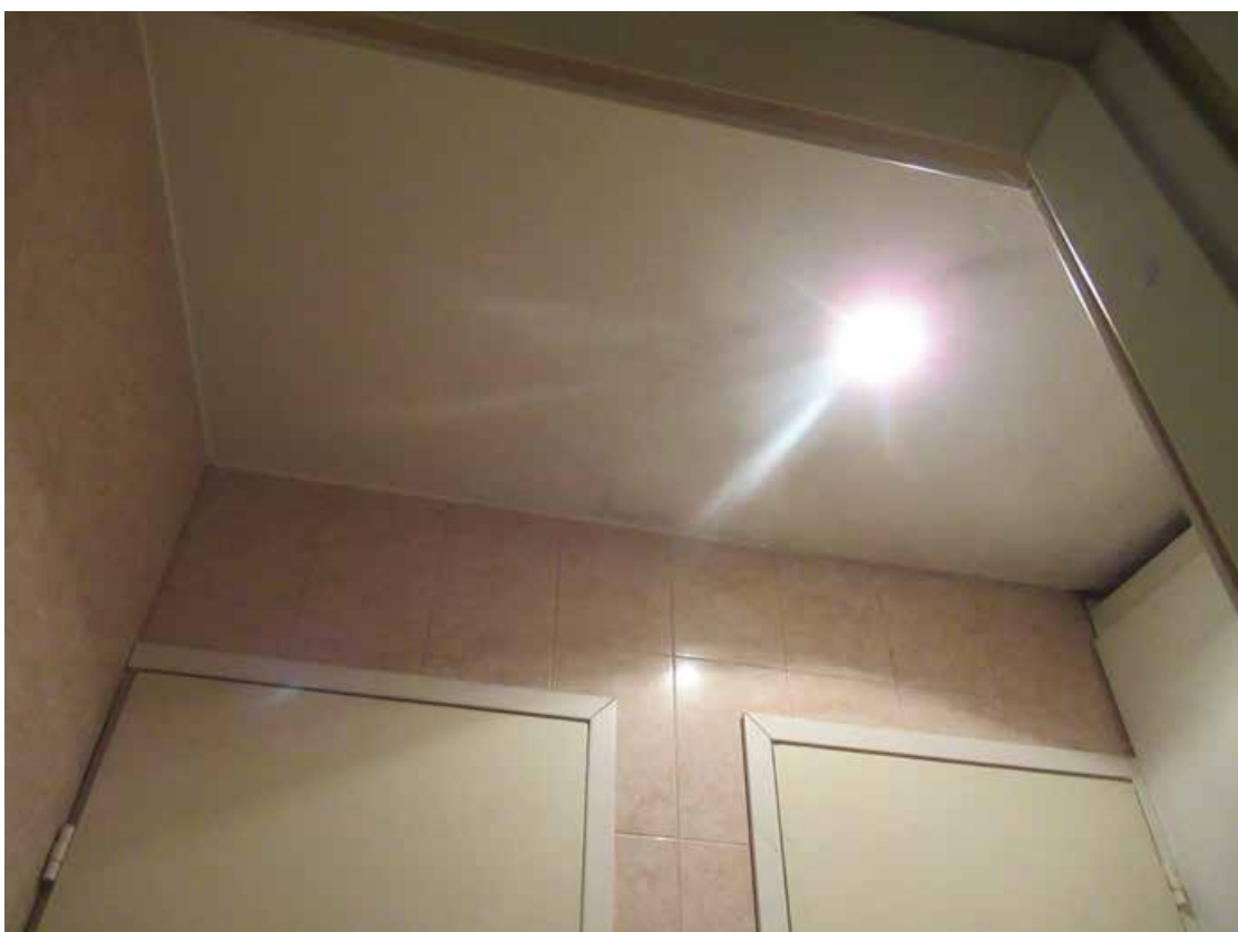
Фото 13. Фойе. Потолок санузла.
