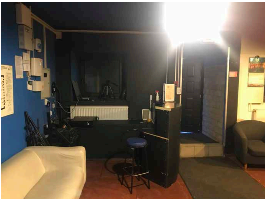
Фото 5. Фойе. Входная зона. Главный вход в помещение. Эл.щит и прочие системы управления инженерными сетями.
