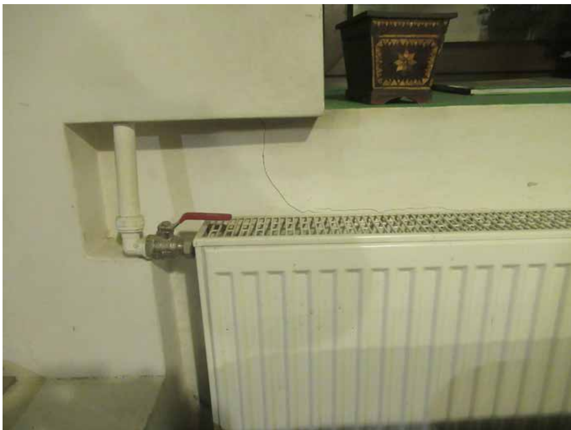
Фото 8. Фойе. Радиатор отопления. Зашивка стены по оси А конструкциями из плит ГСП.
