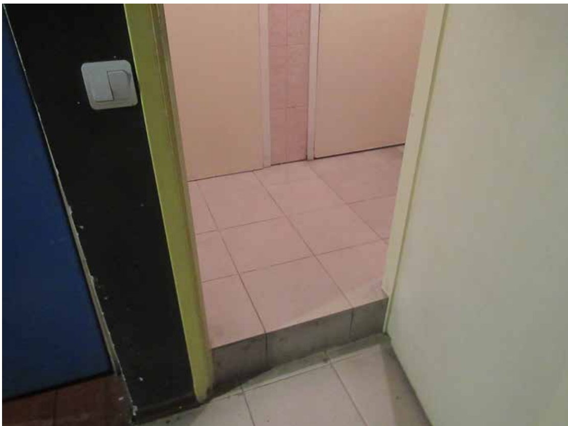
Фото 12. Фойе. Ступень при входе в санузел.
