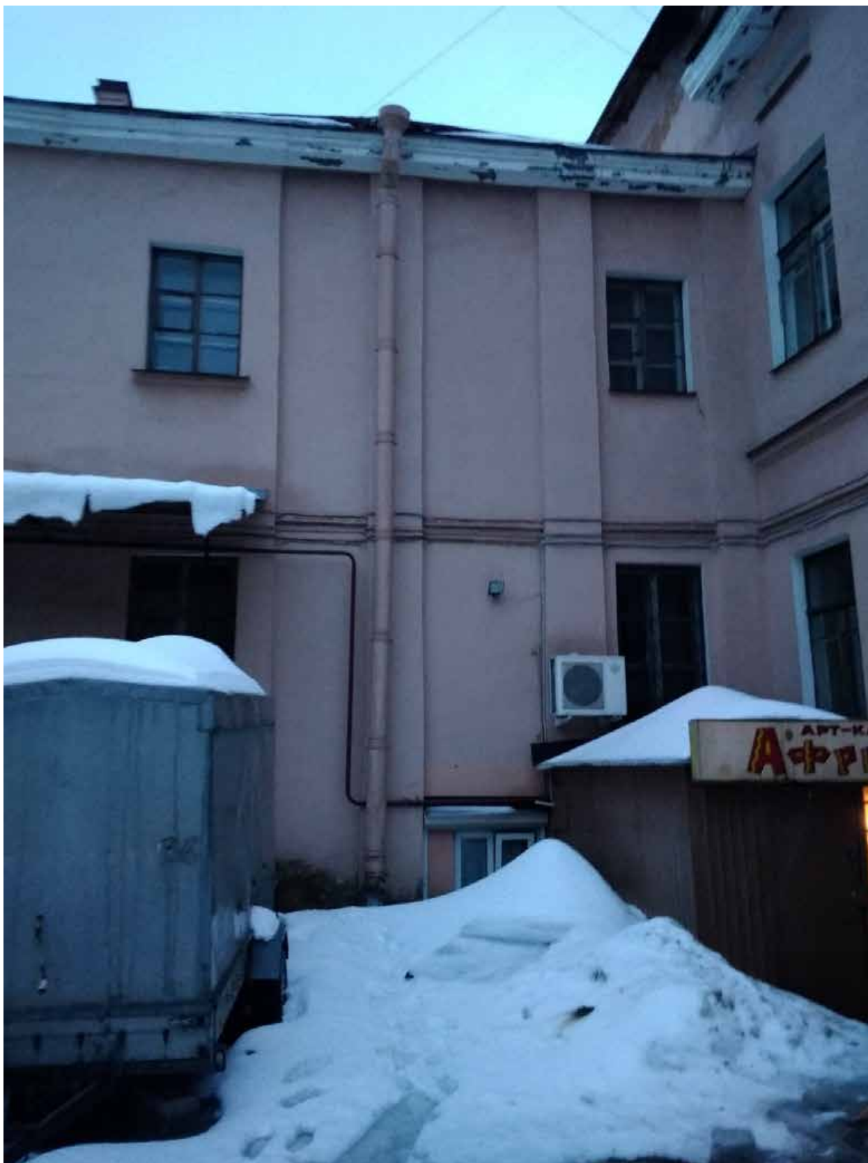
Фото 12. ВОКН «Особняк П.А. Поповой (с флигелями)», расположенный по адресу: г. Санкт-Петербург, наб. реки Фонтанки, д. 130, лит. А. Вид со двора на лицевой фасад флигеля, расположенного в западной границе участка.
