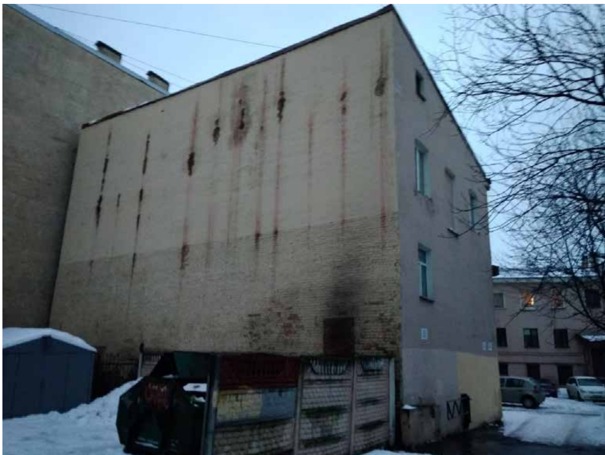
Фото 20. ВОКН «Особняк П.А. Поповой (с флигелями)», расположенный по адресу: г. Санкт-Петербург, наб. реки Фонтанки, д. 130, лит. А. Вид на бран-мауэр флигеля, расположенного в восточной границе участка.
