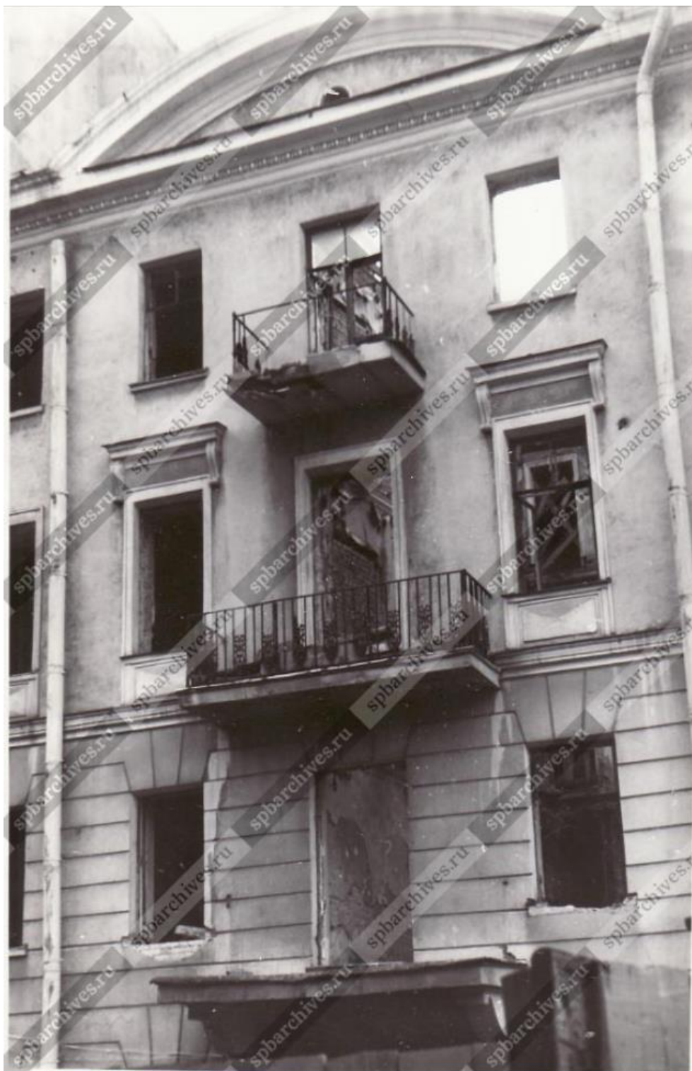
15. Вид части фасада дома № 7 по Измайловскому проспекту во время капитального ремонта (архитекторы М.Ф. Петерсон, 1876 -1877 гг. и А.С. Пронин, 1901-1902 гг.).1984 г. ЦГАКФФД СПб. Шифр: Ар 217711.
