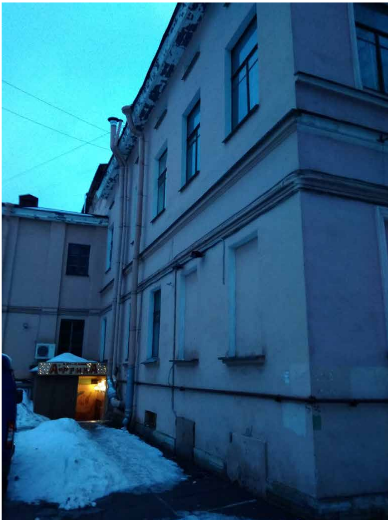
Фото 08. ВОКН «Особняк П.А. Поповой (с флигелями)», расположенный по адресу: г. Санкт-Петербург, наб. реки Фонтанки, д. 130, лит. А. Вид со двора на северо-восточный фасад лицевого корпуса.
