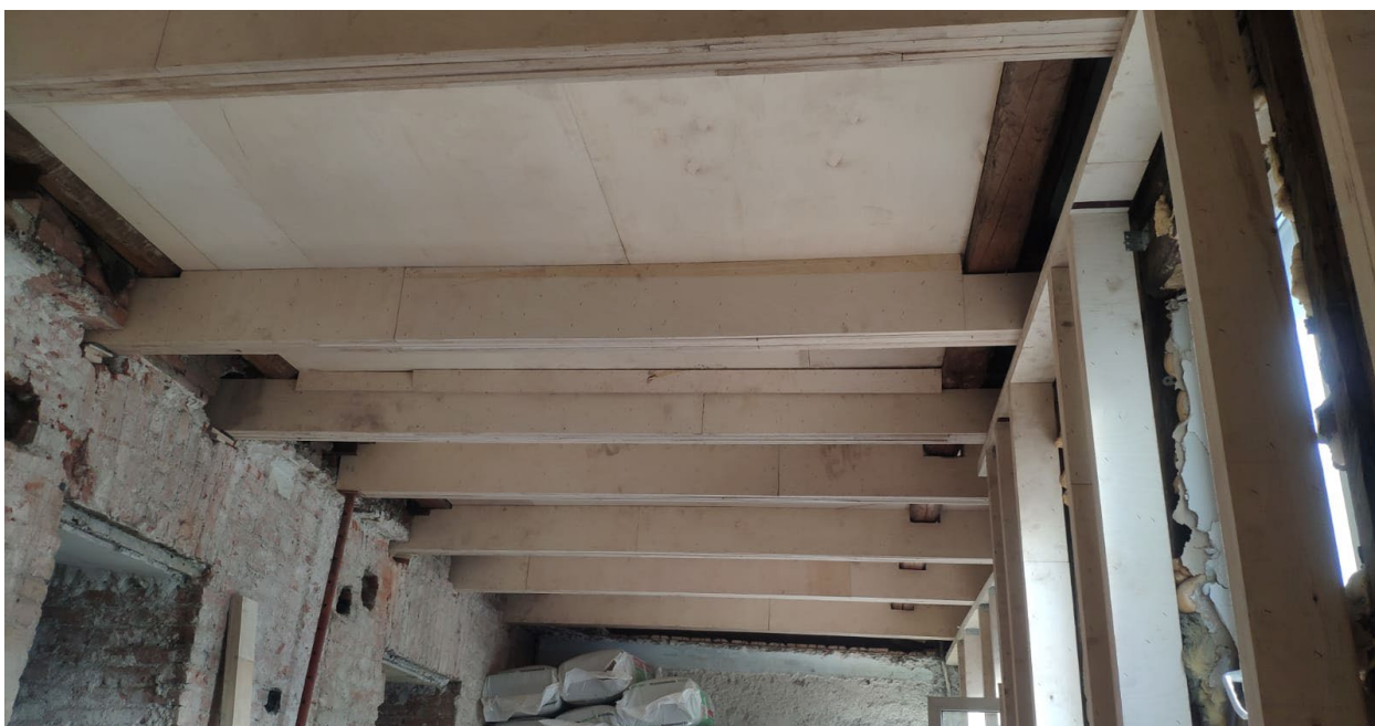
Фото № 15. Интерьер квартиры № 26. Помещения 2,3. Ценные элементы архитектурно-художественной отделки отсутствуют. Потолок разобран. Проводятся противоаварийные работы.
