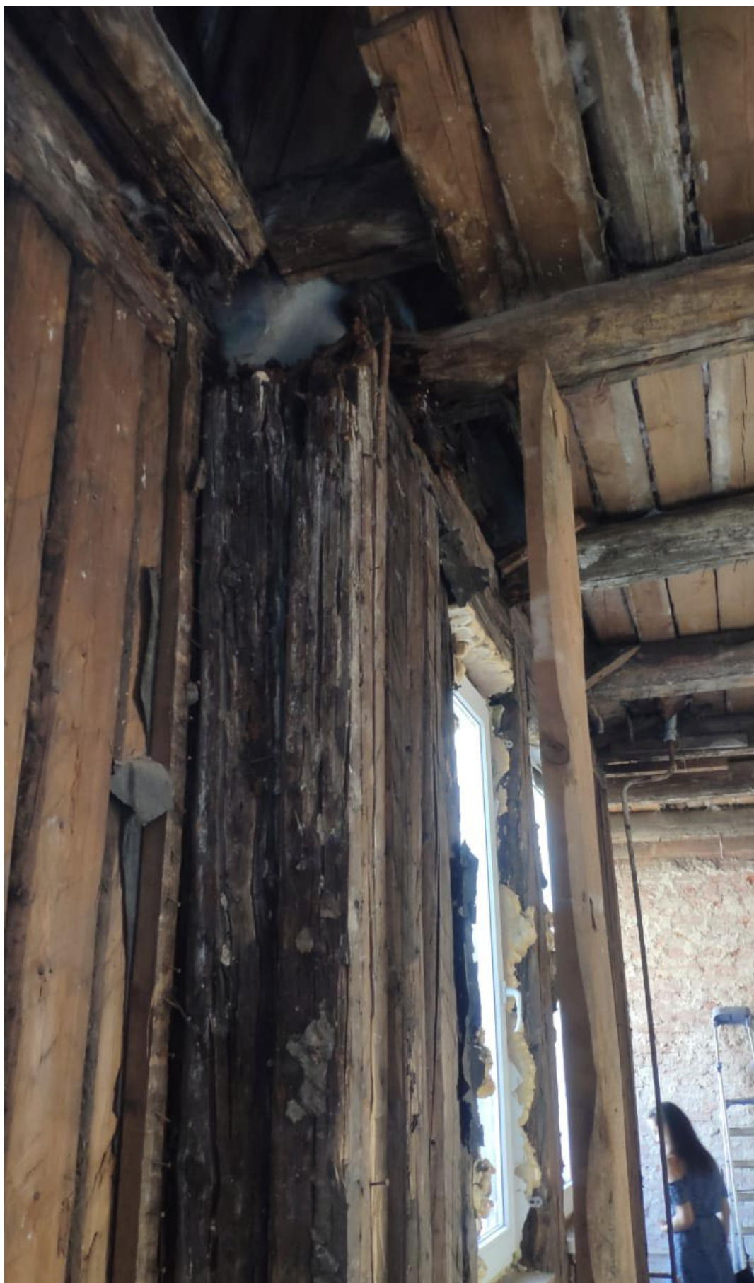
Фото № 4. Интерьер квартиры № 26. Присутствуют повреждения элементов стропильной конструкции. Элементы архитектурно-художественной отделки отсутствуют.
