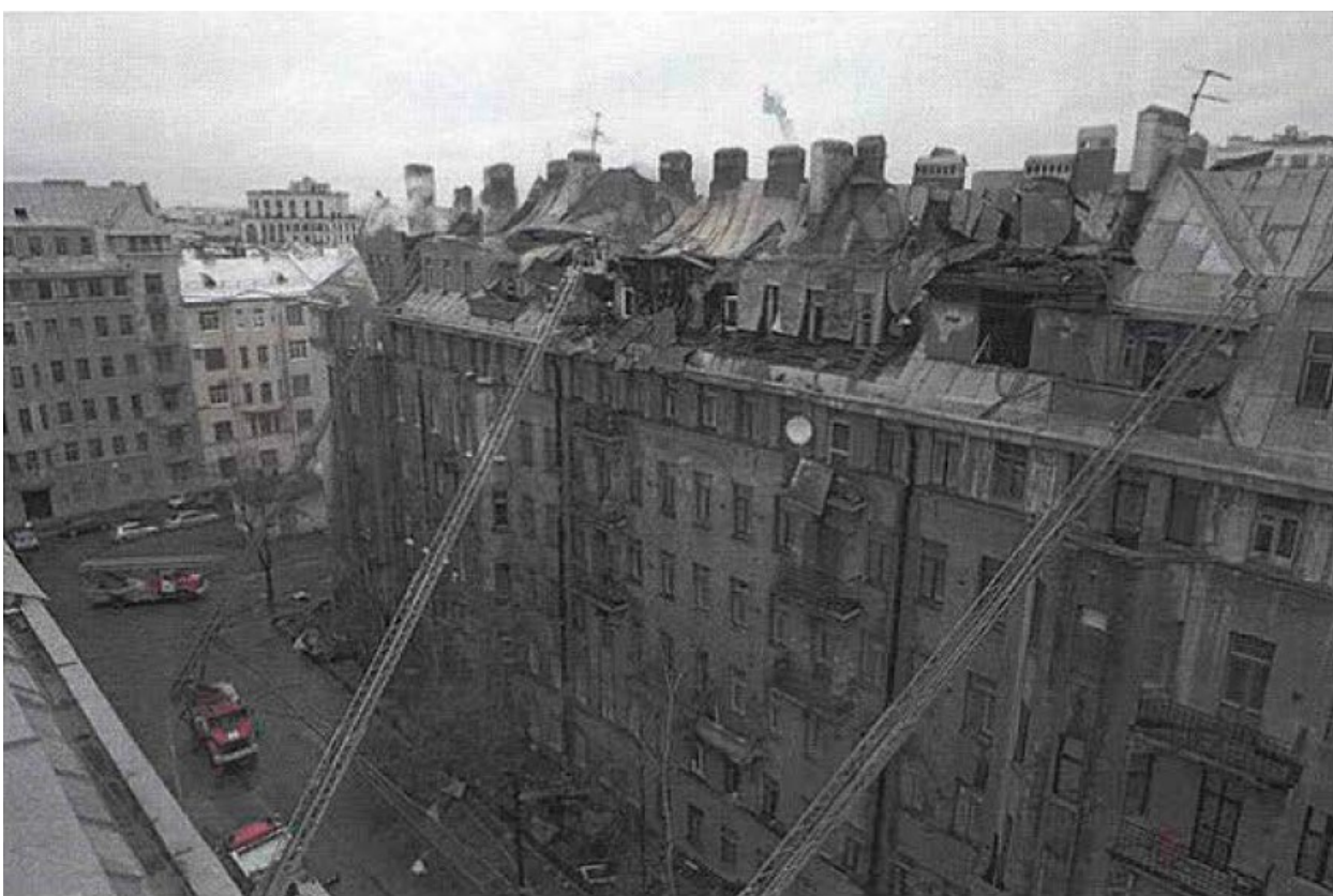
11. Пожар мансардного этажа корпуса под лит. И, Греческий пр. 12. Фото ноябрь 2014г.
