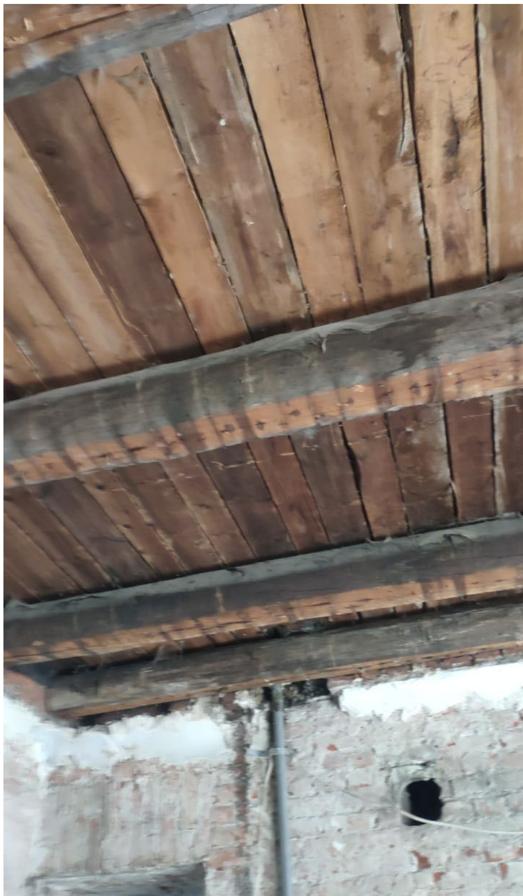
Фото № 10. Интерьер квартиры № 26. Помещение 6. Ценные элементы архитектурно-художественной отделки отсутствуют. Потолок разобран.
