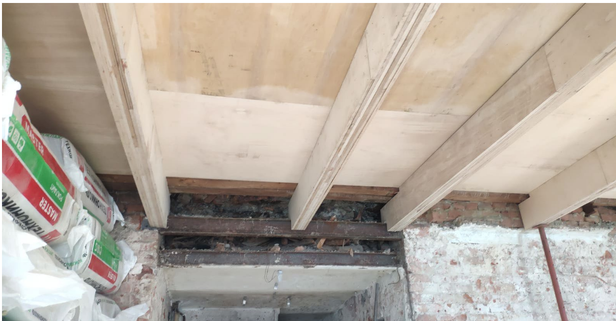
Фото № 14. Интерьер квартиры № 26. Помещение 4. Ценные элементы архитектурно-художественной отделки отсутствуют. Потолок разобран. Проводятся противоаварийные работы.
