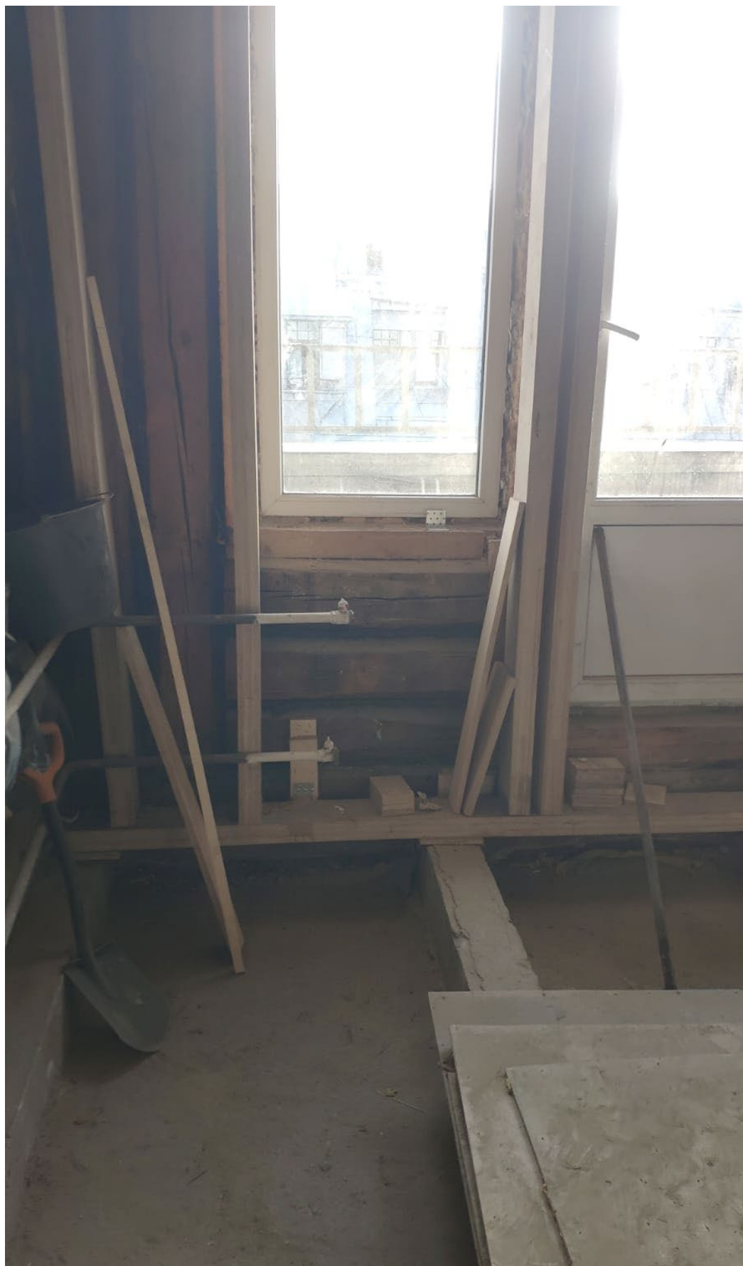
Фото № 12. Интерьер квартиры № 26. Помещение 4. Ценные элементы архитектурно-художественной отделки отсутствуют. Внутренняя обшивка стен разобрана. Проводятся противоаварийные работы.
