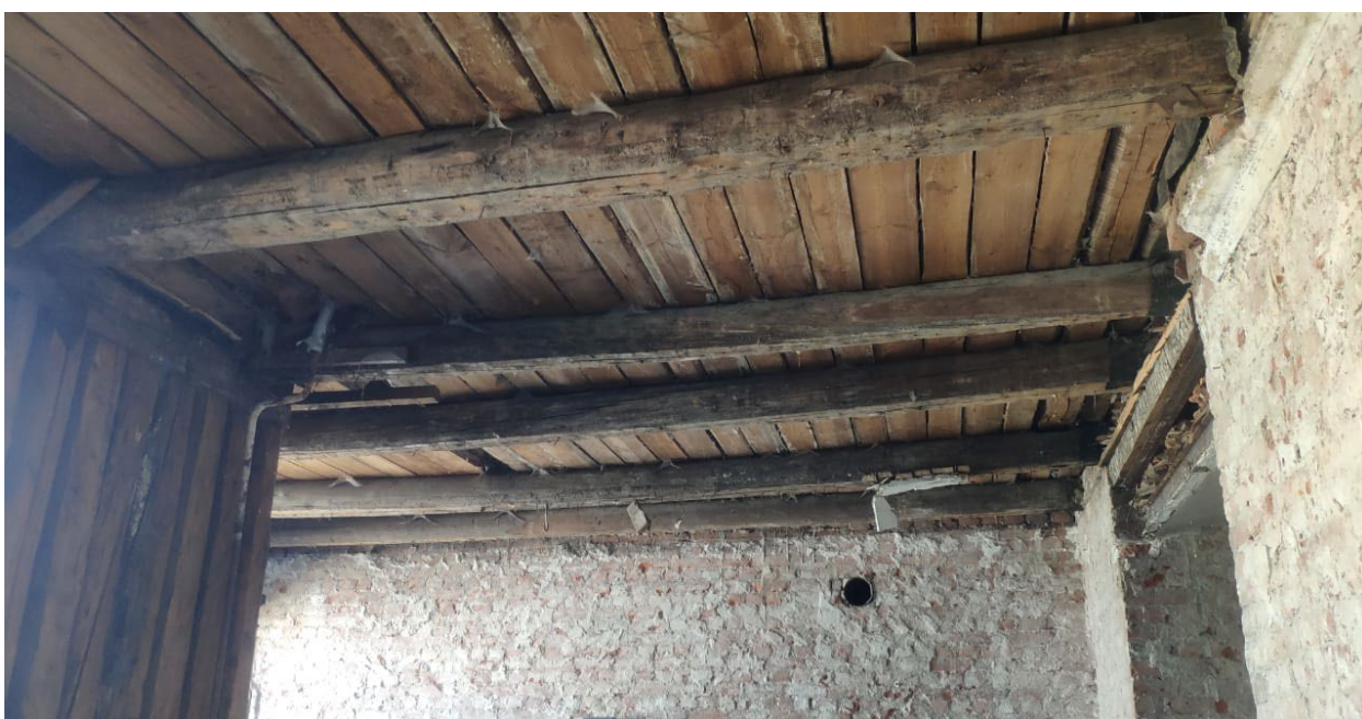
Фото № 10. Интерьер квартиры № 26. Помещение 4. Перегородки и ценные элементы архитектурно-художественной отделки отсутствуют. Проводятся противоаварийные работы.
