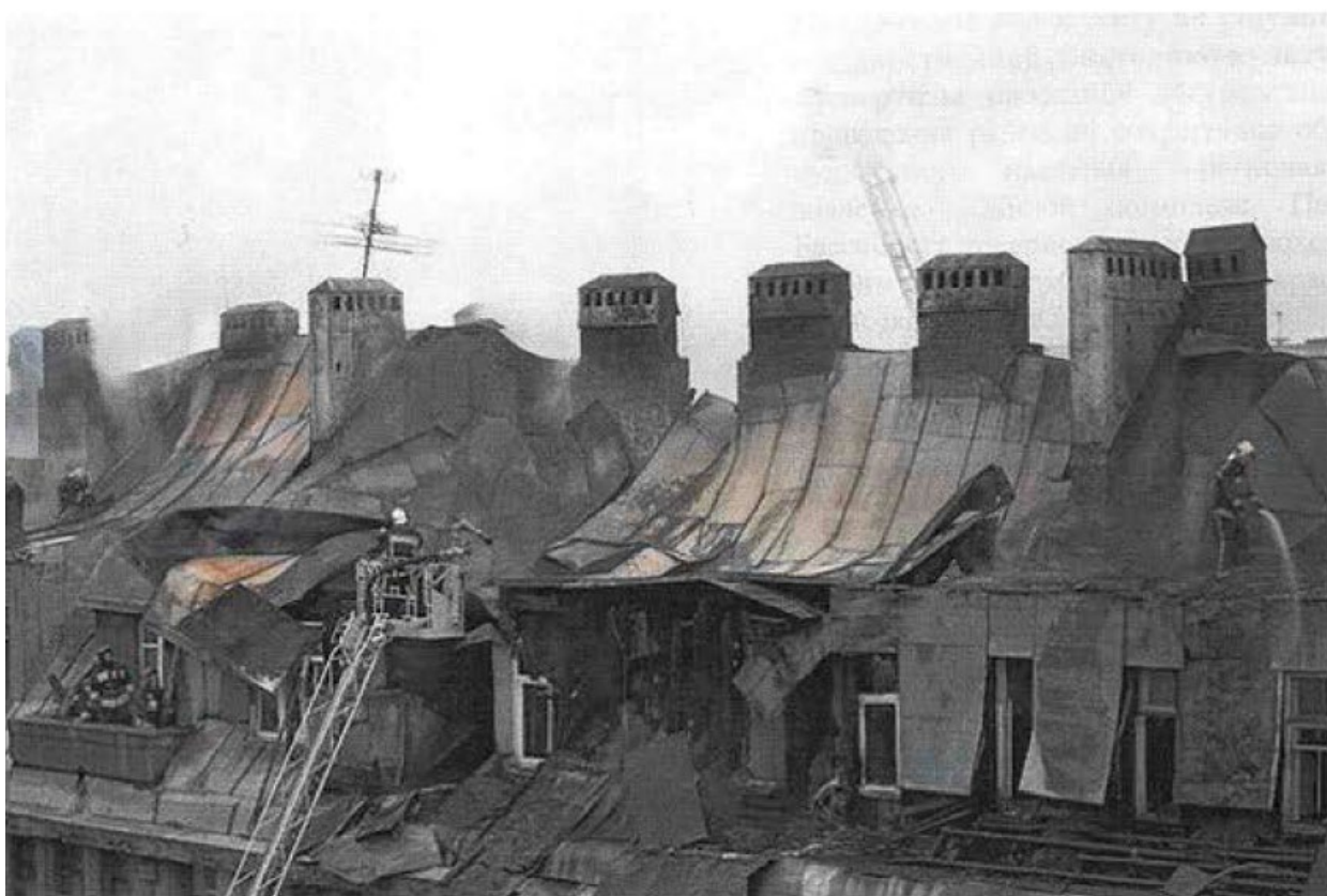
13. Пожар мансардного этажа корпуса под лит. И, Греческий пр. 12. Фото ноябрь 2014г.
