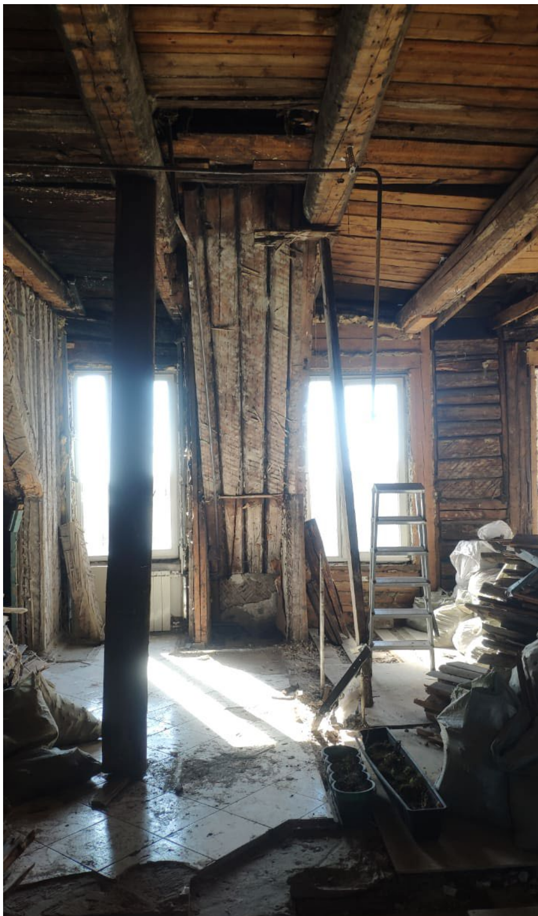
Фото № 2. Интерьер квартиры № 26. Помещения 1,6,7,8,9,10. Перегородки и ценные элементы архитектурно-художественной отделки отсутствуют. Проводятся противоаварийные работы.
