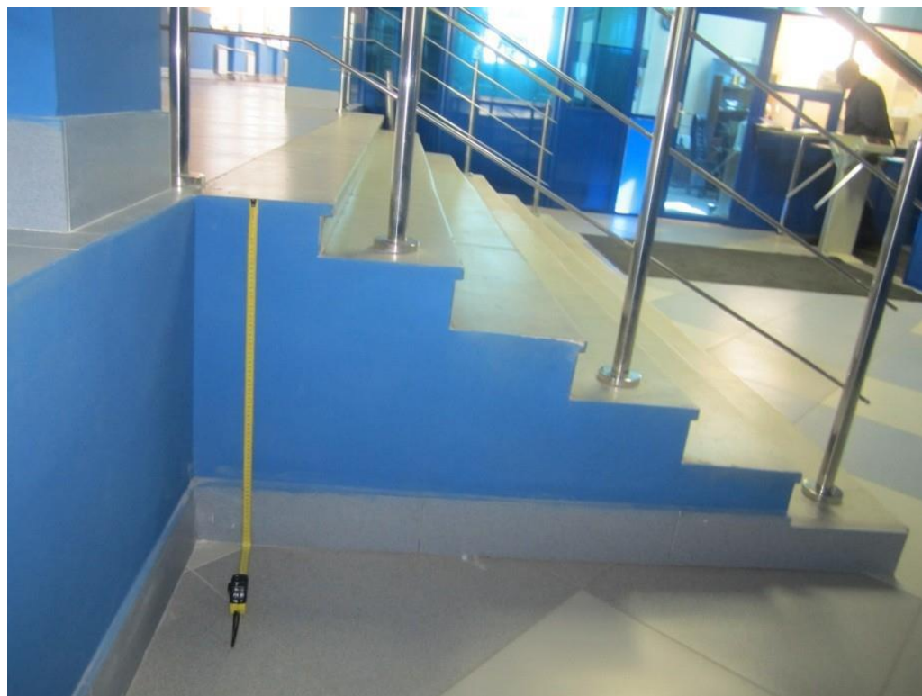
6. Гидротехнический институт им. Б.Е.Веденеева (лицевой корпус с примыкающими дворовыми флигелями). Лестница вестибюля. Штиглиц М.С. 10.02.2021 г.
