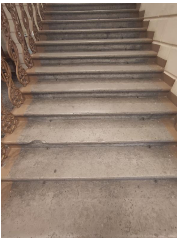
Фото 11. Интерьер объекта культурного наследия федерального значения «Дом, где в 1893-1907 гг. работал химик Менделеев Д.И.», ч.п.51, ступени лестничной клетки
