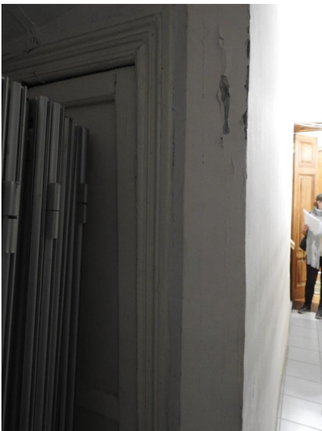
46. «Дома Дубянских (Зиновьева Н. В, Карловой Н.Ф.). Дом жилой», набережная р. Фонтанки, д. 48. Дверь в помещение № 60. Вид из помещения № 113. Фото 10.11.2021 г.
