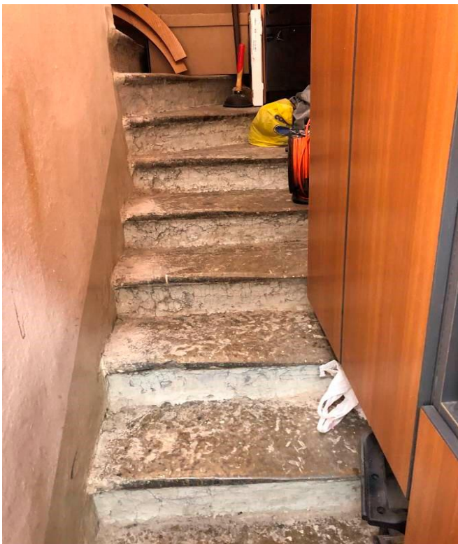
29. «Дома Дубянских (Зиновьева Н. В, Карловой Н.Ф.). Дом жилой», набережная р. Фонтанки, д. 48. Помещение № 60. Лестничный марш. Вид от входной двери. Фото 10.11.2021 г.
