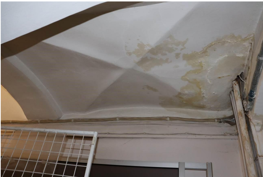
45. «Дома Дубянских (Зиновьева Н. В, Карловой Н.Ф.). Дом жилой», набережная р. Фонтанки, д. 48. Помещение № 113. Крестовый свод. Фото 10.11.2021 г.
