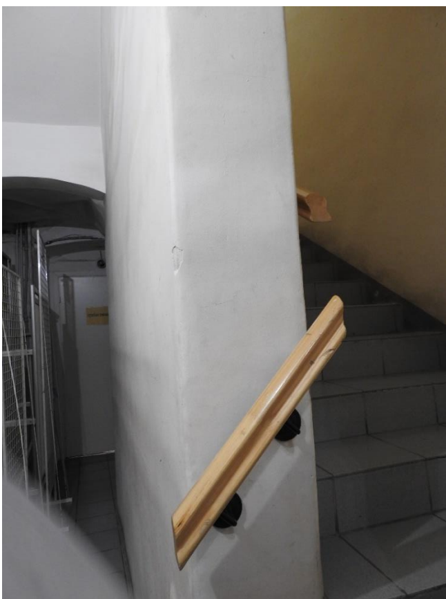
44. «Дома Дубянских (Зиновьева Н. В, Карловой Н.Ф.). Дом жилой», набережная р. Фонтанки, д. 48. Помещение 112. Вид от входной двери. Фото 10.11.2021 г.
