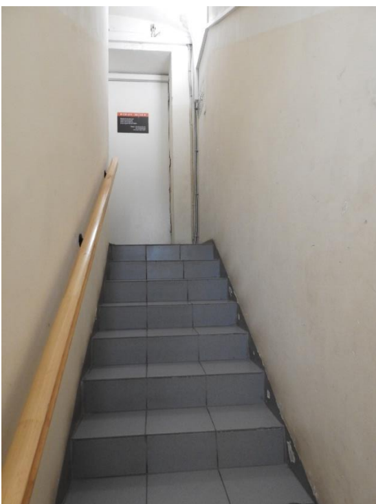
50. «Дома Дубянских (Зиновьева Н. В, Карловой Н.Ф.). Дом жилой», набережная р. Фонтанки, д. 48. Помещение № 112. Лестничный марш, ведущий на площадку 3-го этажа. Фото 10.11.2021 г.
