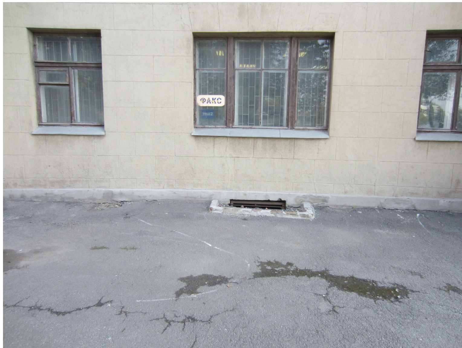
4. Объект культурного наследия регионального значения «Комплекс жилых домов (6 зданий)», расположенный по адресу: Санкт-Петербург, Красногвардейский район, Малоохтинский пр., 86, лит. А Фрагмент облицовки цоколя, заполнение оконных проемов в уровне 1-го этажа Съемка: 12 сентября 2019г.
