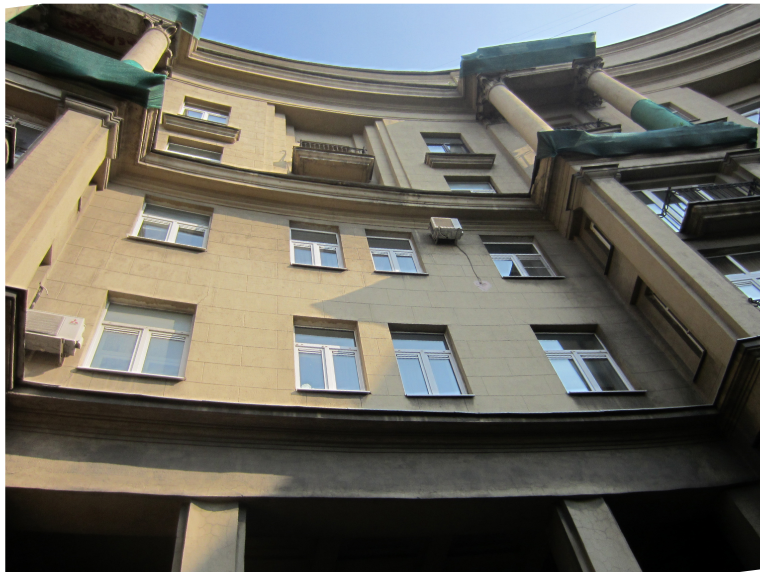
6. Объект культурного наследия регионального значения «Комплекс жилых домов (6 зданий)», расположенный по адресу: Санкт-Петербург, Красногвардейский район, Малоохтинский пр., 86, лит. А Фрагмент лицевого фасада. Заполнение оконных проемов, стилизованные колонны коринфского ордера на уровне 5-6 этажей Съемка: 12 сентября 2019г.
