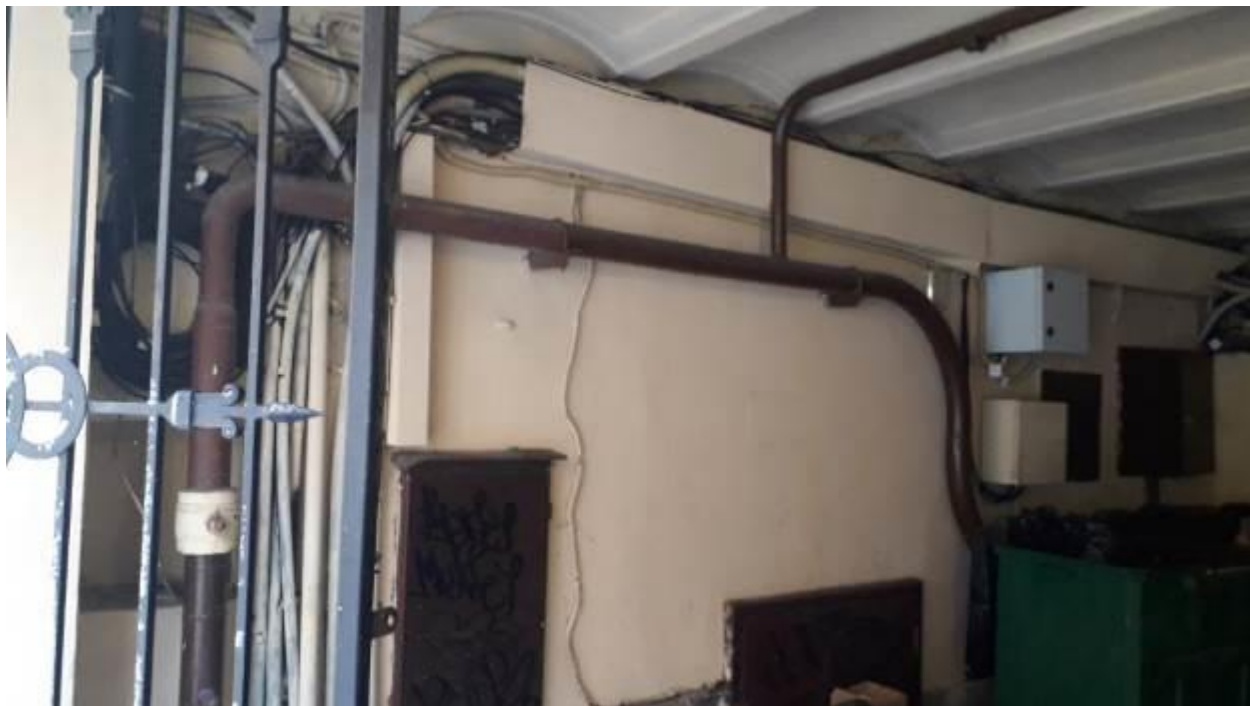
5. Дом С.М. Тедески (П.А. Зубова). Большая Морская ул., д. 7, лит. А. Арочный проезд. Фото мест установки оборудования и кабельных трасс. Штиглиц М.С. 10.01.2022.
