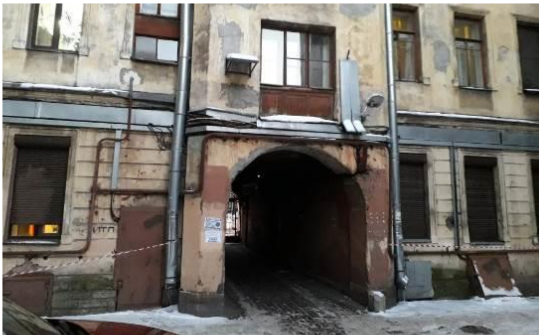
28. Дом П.К. Симонова (А.А. и И.А. Орловых). Пушкинская ул., д. 11, лит. А. Дворовые фасады. Фото мест установки оборудования и кабельных трасс. Штиглиц М.С. 10.01.2022
