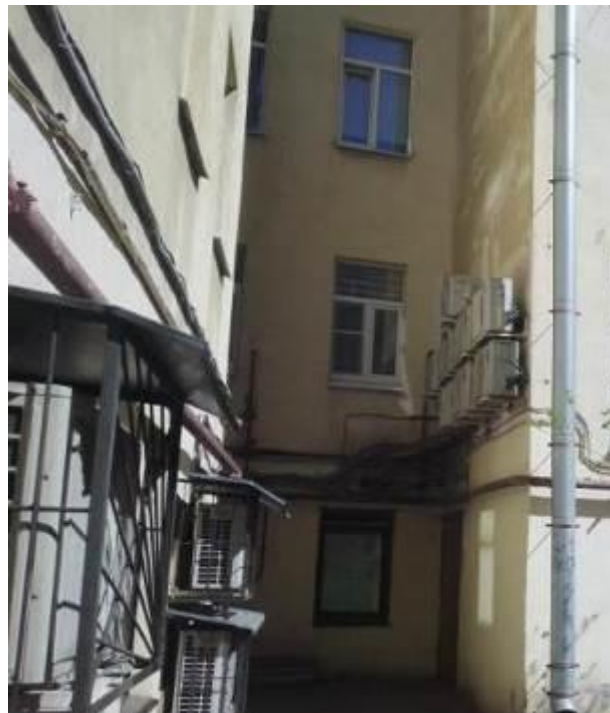
7. Дом К.К. Фелейзена (гостиница «Франция»). Большая Морская ул., д. 6, лит. А. Дворовые фасады. Фото мест установки оборудования и кабельных трасс. Штиглиц М.С. 10.01.2022.
