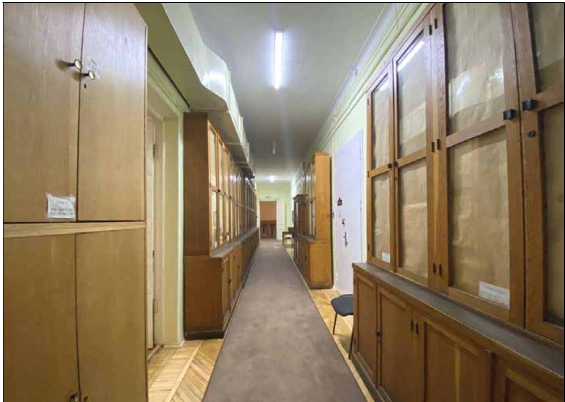
77. Объект культурного наследия регионального значения «Дом, в котором в 1902-1929 и 1933-1936 годах жил историк Н.П. Лихачев». 1-й этаж. Помещение № 1 (коридор). Вид от помещения № 6. 16.01.2022 г.
