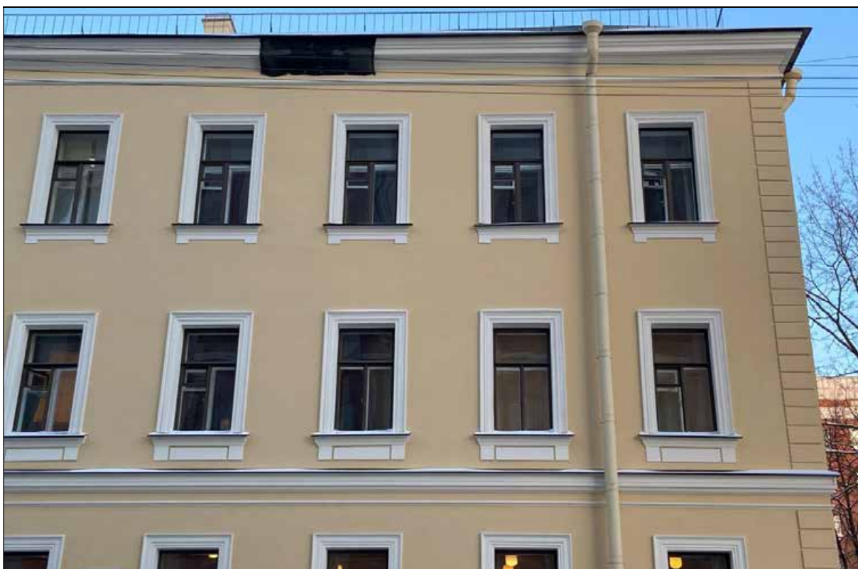
11. Объект культурного наследия регионального значения «Дом, в котором в 1902-1929 и 1933-1936 годах жил историк Н.П. Лихачев». Фрагмент лицевого фасада. Оконные проемы 2-го и 3-го этажей. 16.01.2022 г.
