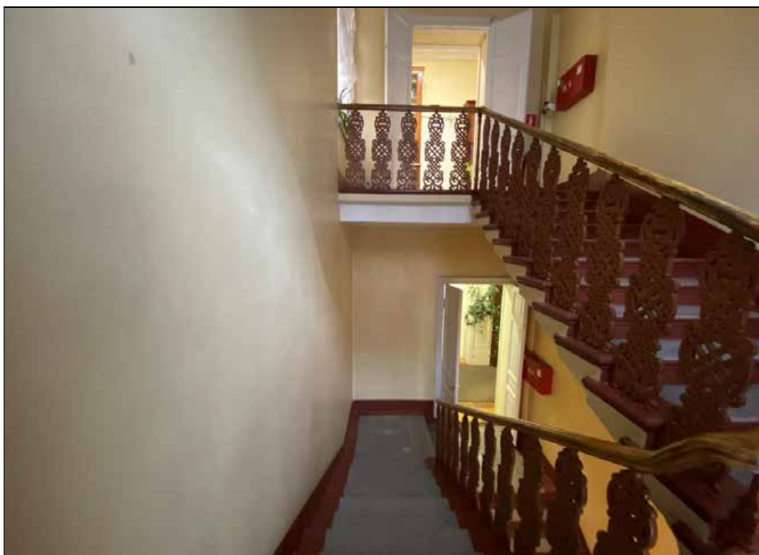
213. Объект культурного наследия регионального значения «Дом, в котором в 1902-1929 и 1933-1936 годах жил историк Н.П. Лихачев». Парадная лестница Л-1 (помещение V). Лестничные марши 2-го и 3-го этажей. 16.01.2022 г.
