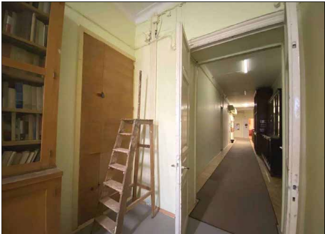
137. Объект культурного наследия регионального значения «Дом, в котором в 1902-1929 и 1933-1936 годах жил историк Н.П. Лихачев». 2-й этаж. Дверной проем между помещением № 1 и помещением № 4. 16.01.2022 г.
