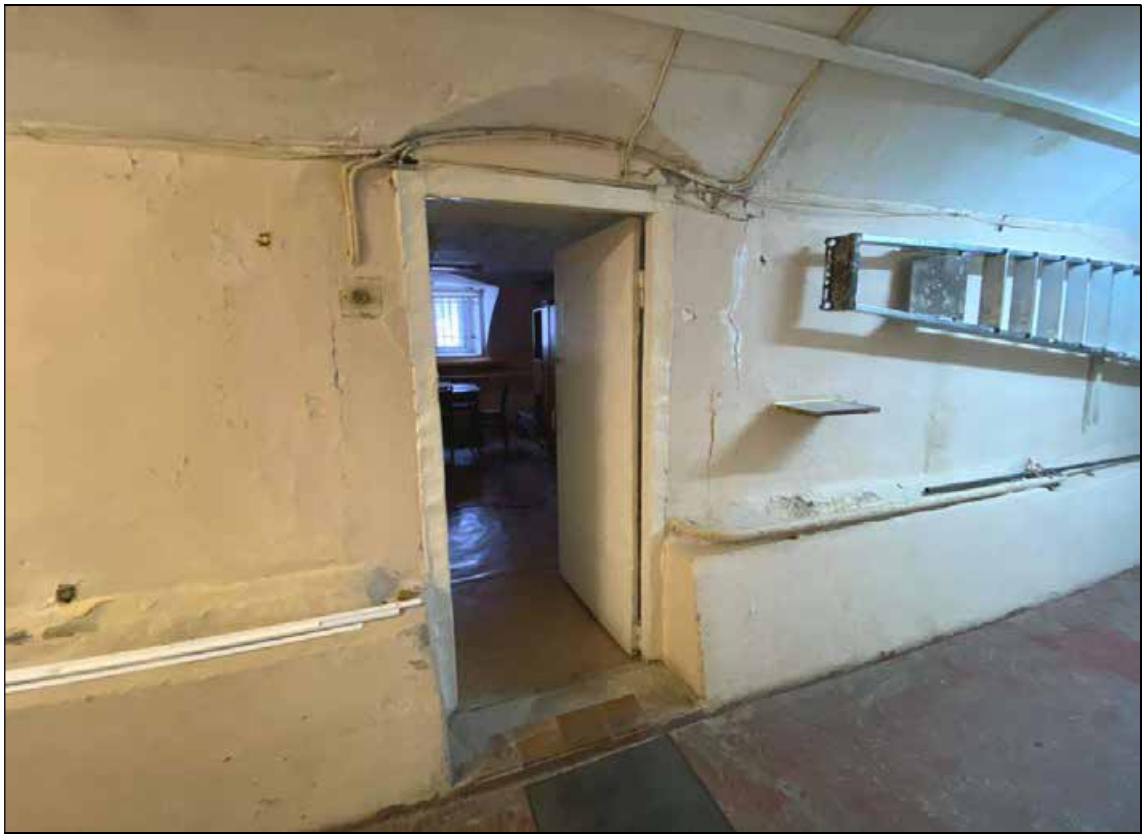
43. Объект культурного наследия регионального значения «Дом, в котором в 1902-1929 и 1933-1936 годах жил историк Н.П. Лихачев». Цокольный этаж. Помещение № 2 (коридор). Вход в помещение № 3. 16.01.2022 г.
