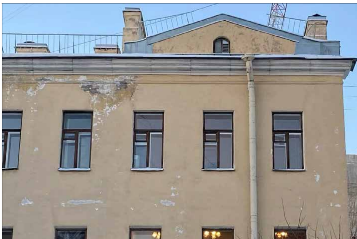
29. Объект культурного наследия регионального значения «Дом, в котором в 1902-1929 и 1933-1936 годах жил историк Н.П. Лихачев». Фрагмент северного дворового фасада. Оконные проемы 3-го этажа. Аттик с люнетом. Венчающий карниз. 16.01.2022 г.
