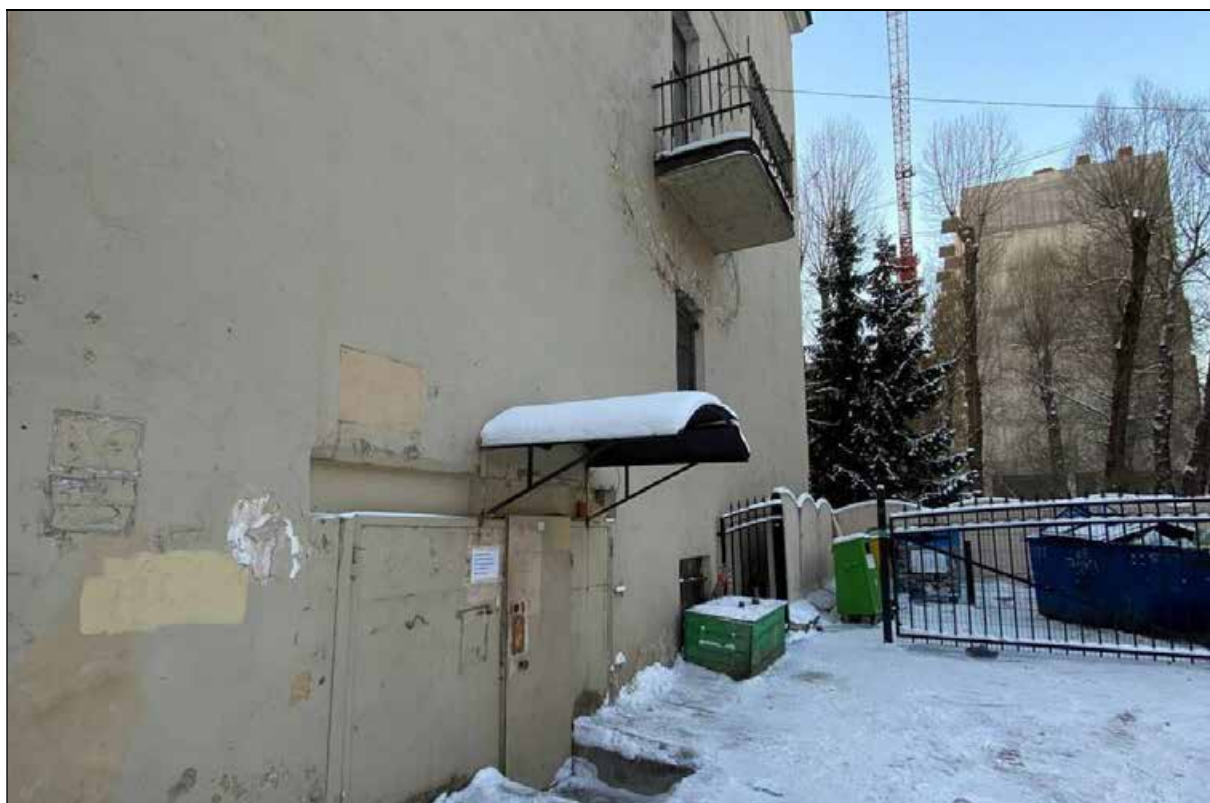
21. Объект культурного наследия регионального значения «Дом, в котором в 1902-1929 и 1933-1936 годах жил историк Н.П. Лихачев». Фрагмент северного торцевого фасада. Вход в помещение 2-Н. 16.01.2022 г.
