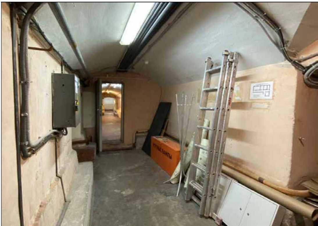
44. Объект культурного наследия регионального значения «Дом, в котором в 1902-1929 и 1933-1936 годах жил историк Н.П. Лихачев». Цокольный этаж. Западная часть помещения № 6 (коридор). Вид от помещения № 10. 16.01.2022 г.
