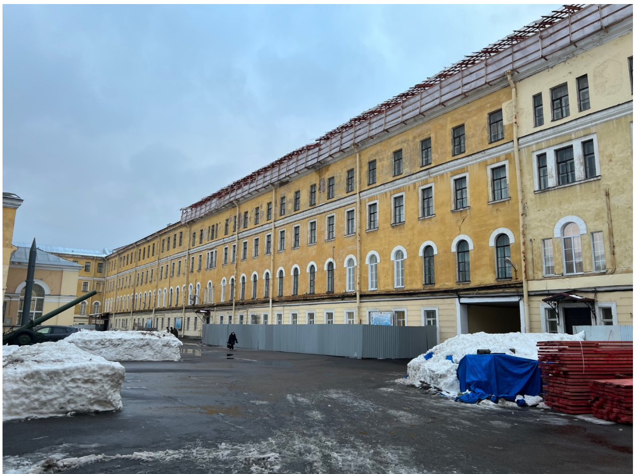
15. Северо-восточный дворовый фасад выявленного объекта культурного наследия «Главный корпус с 1-м солдатским корпусом, офицерским флигелем и Михайловское артиллерийское училище», расположенного по адресу: г. Санкт-Петербург, ул. Комсомола, д. 22, литера А. 06.12.2021
