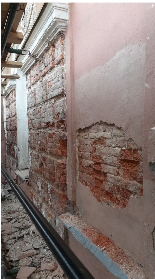
9. Юго-западный лицевой фасад выявленного объекта культурного наследия «Пиротехническая школа», расположенного по адресу: г. Санкт-Петербург, ул. Комсомола, д. 22, литера А. 06.12.2021
