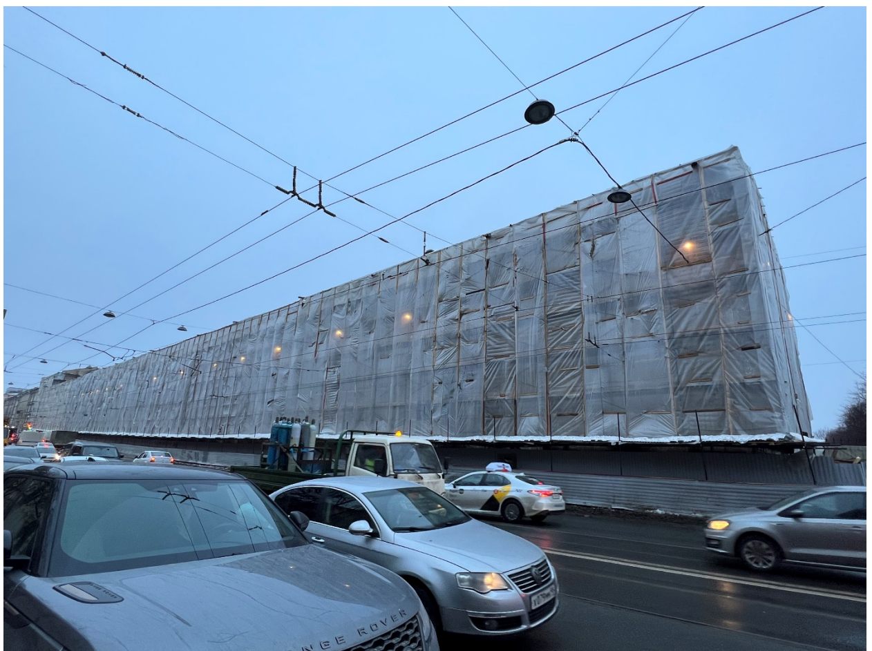
1. Юго-западный лицевой фасад выявленного объекта культурного наследия «Пиротехническая школа», расположенного по адресу: г. Санкт-Петербург, ул. Комсомола, д. 22, литера А. 06.12.2021
