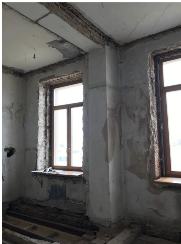
Фото 13. Интерьер квартиры №1, расположенной в объекте культурного наследия регионального значения «Дом № 48», входящем в состав объекта культурного наследия регионального значения «Дома П.К. Ферзена (А.Я. Прозорова)», 2 эт.
