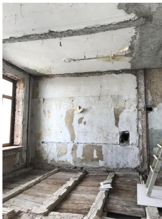
Фото 11. Интерьер квартиры №1, расположенной в объекте культурного наследия регионального значения «Дом № 48», входящем в состав объекта культурного наследия регионального значения «Дома П.К. Ферзена (А.Я. Прозорова)», 2 эт.
