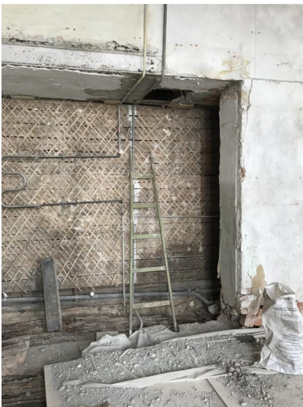
Фото 12. Интерьер квартиры №1, расположенной в объекте культурного наследия регионального значения «Дом № 48», входящем в состав объекта культурного наследия регионального значения «Дома П.К. Ферзена (А.Я. Прозорова)», 2 эт., ниша в стене
