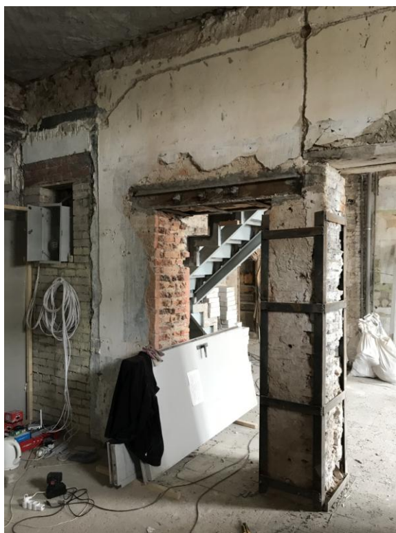
Фото 7. Интерьер квартиры №1, расположенной в объекте культурного наследия регионального значения «Дом № 48», входящем в состав объекта культурного наследия регионального значения «Дома П.К. Ферзена (А.Я. Прозорова)», 1 эт, существующие проемы в стене
