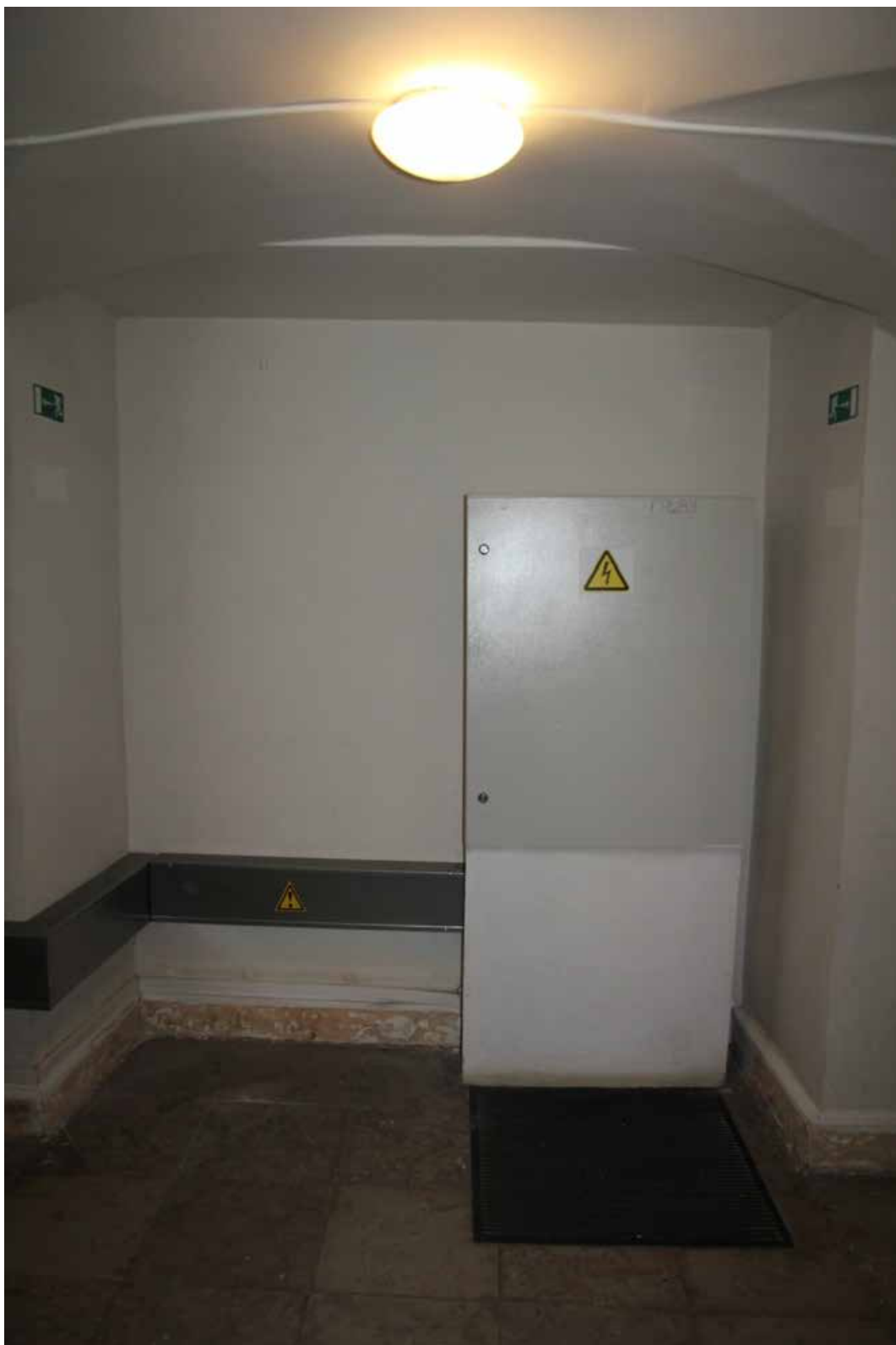
Фото №6. Общій вид на тупик в концe коридора и щиток
