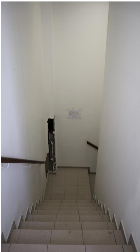
Фото 5.1. 5 этаж, помещение 10Н (49), лестница двухмаршевая, в северо-западной части здания, на плане ПИБ от 24.12.2018 не обозначена.
