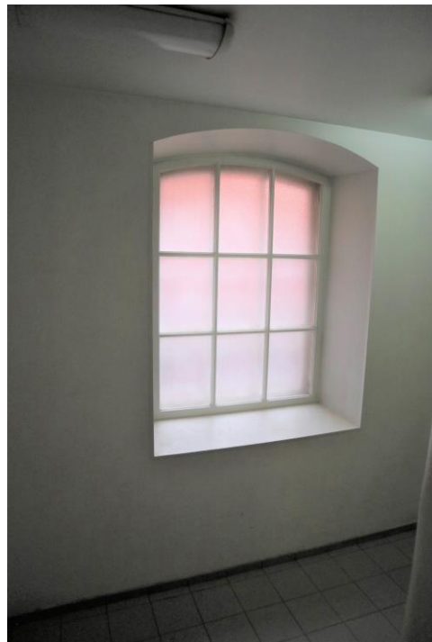
Фото 3.1. 3 этаж, лестничная площадка лестницы ЛК-1 (4, 6).
