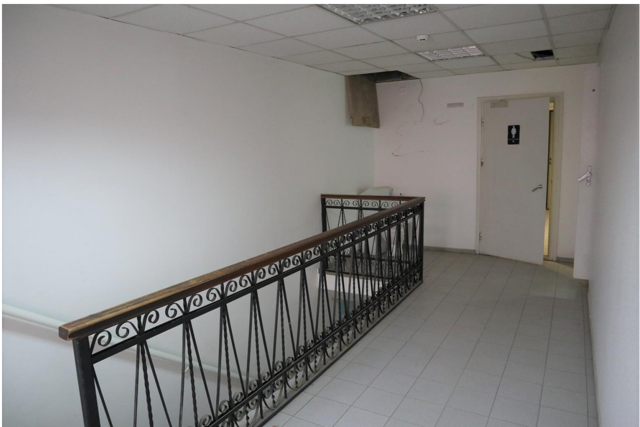
Фото 4.2. 4 этаж, лестничная площадка лестницы ЛК-1 (7).
