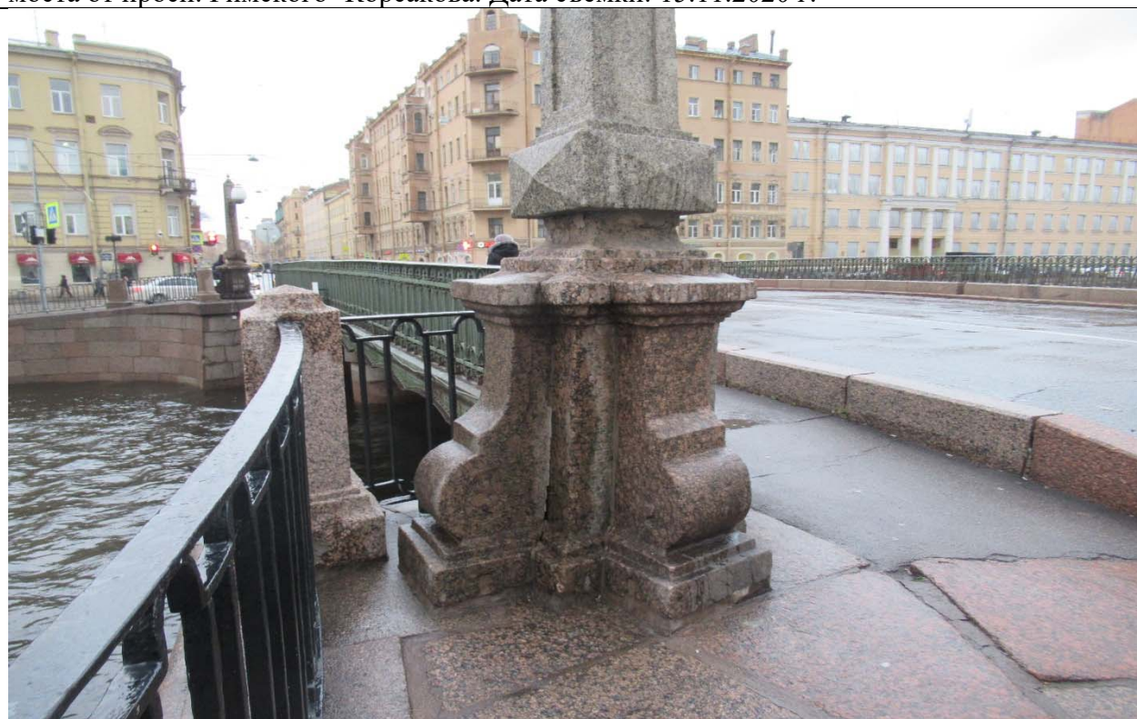
10. ОКН ФЗ «Мост Аларчин», входящий в состав комплекса «Набережные и мосты Екатерининского канала (ныне канала Грибоедова)» по адресу: г. Санкт-Петербург, через канал Грибоедова по Английскому пр. Постаменты, парапетная профилированная тумба со стороны наб. кан. Грибоедова (напротив д. 154). Дата съемки: 15.11.2020 г.
