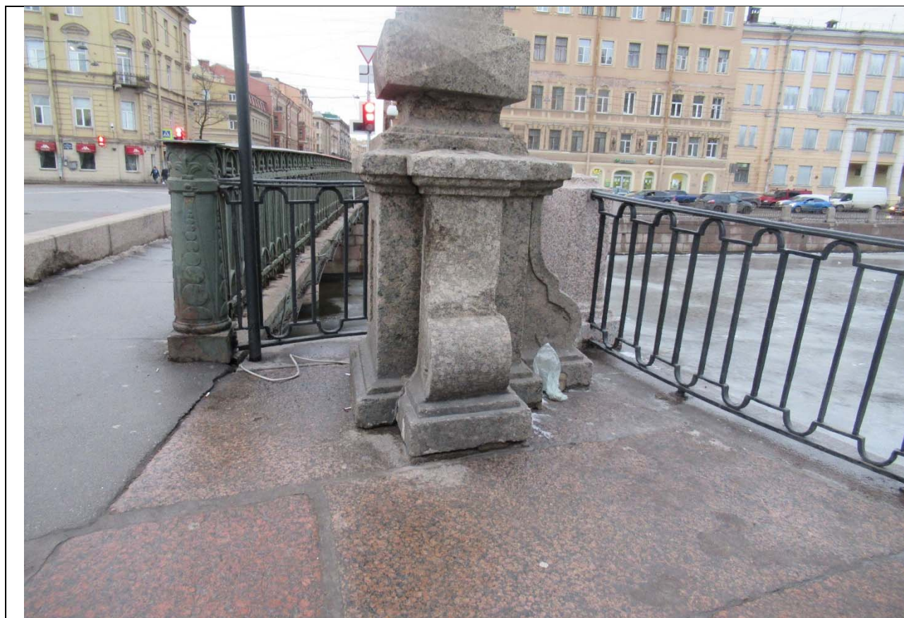
15. ОКН ФЗ «Мост Аларчин», входящий в состав комплекса «Набережные и мосты Екатерининского канала (ныне канала Грибоедова)» по адресу: г. Санкт-Петербург, через канал Грибоедова по Английскому пр. Постаменты, парапетная профилированная тумба со стороны наб. кан. Грибоедова (напротив д. 152/42). Дата съемки: 15.11.2020 г.
