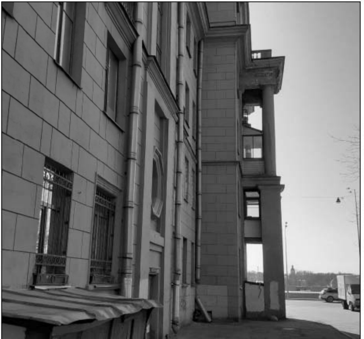
14. Северный фасад. Вид на западный ризалит. Дата съемки: 10 мая 2021 г. Фотограф: Г. В. Михайловская.
