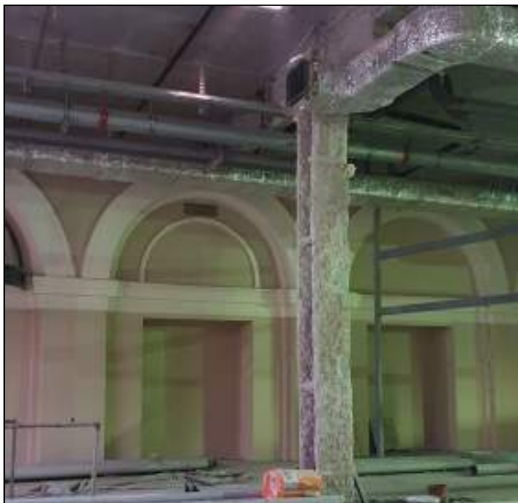
27. Фрагмент интерьера бывшего внутреннего двора, перекрытого в настоящее время. Выявленный объект культурного наследия «Здание вокзала», расположенный по адресу: Санкт-Петербург, наб. Обводного канала, д. 118, лит. С, входящий в ансамбль выявленного объекта культурного наследия «Комплекс построек Варшавского вокзала». Дата съемки: 20.12.2021.
