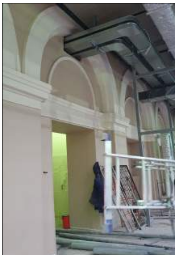
30. Фрагмент интерьера бывшего внутреннего двора, перекрытого в настоящее время: пилястры в межоконном пространстве. Выявленный объект культурного наследия «Здание вокзала», расположенный по адресу: Санкт-Петербург, наб. Обводного канала, д. 118, лит. С, входящий в ансамбль выявленного объекта культурного наследия «Комплекс построек Варшавского вокзала». Дата съемки: 20.12.2021.
