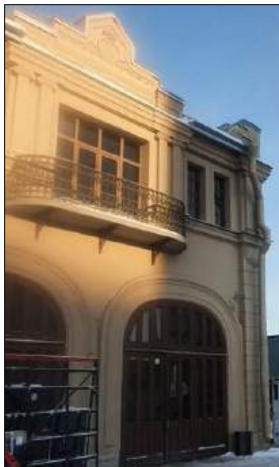
78. Южный фасад. Боковая часть. Оконные и дверные (коробовые) проемы. Выявленный объект культурного наследия «Здание вокзала», расположенный по адресу: Санкт-Петербург, наб. Обводного канала, д. 118, лит. С, входящий в ансамбль выявленного объекта культурного наследия «Комплекс построек Варшавского вокзала». Дата съемки: 20.12.2021.
