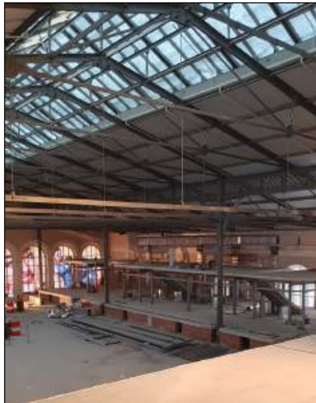
72. Фонарь в коньке крыши дебаркадера. Общий вид. Металлические колонны дебаркадера. Фермы. Фасонки. Выявленный объект культурного наследия «Здание вокзала», расположенный по адресу: Санкт-Петербург, наб. Обводного канала, д. 118, лит. С, входящий в ансамбль выявленного объекта культурного наследия «Комплекс построек Варшавского вокзала». Дата съемки: 20.12.2021.
