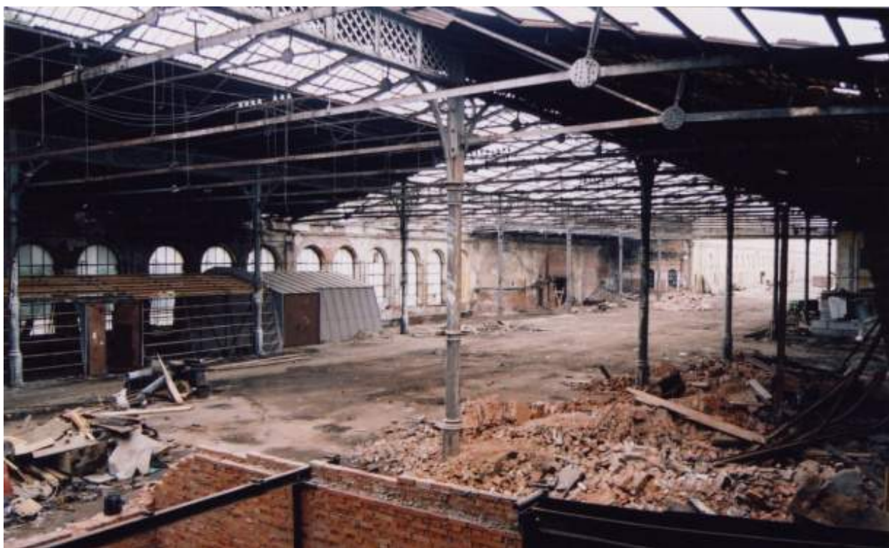
109. Здание бывшего Варшавского вокзала во время реконструкции. Представление о пространственной структуре вокзала и используемой конструкции стеклянной крыши 1850-х гг. 2004г. http://www.citywalls.ru/ .
