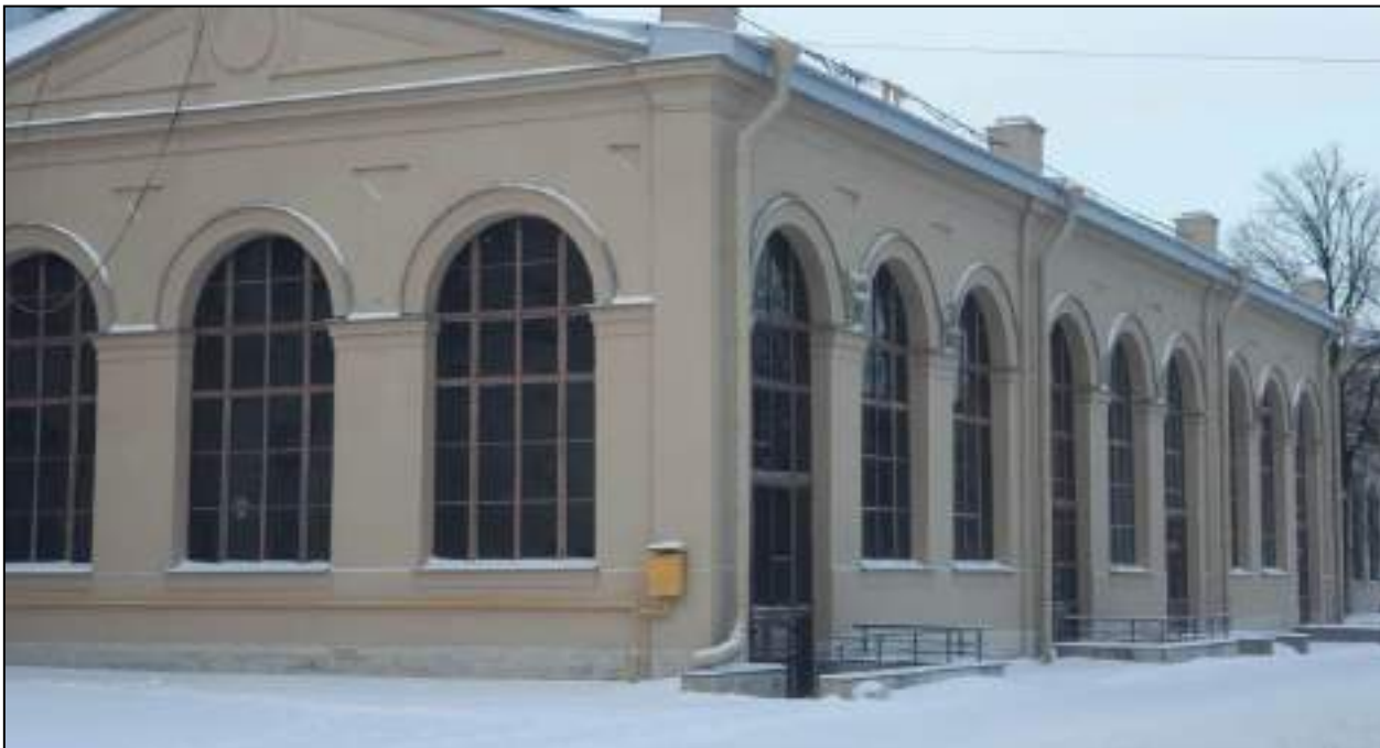
10. Боковой и восточный фасады пристройки лицевого фасада восточного корпуса. Выявленный объект культурного наследия «Здание вокзала», расположенный по адресу: Санкт-Петербург, наб. Обводного канала, д. 118, лит. С, входящий в ансамбль выявленного объекта культурного наследия «Комплекс построек Варшавского вокзала». Дата съемки: 20.12.2021.
