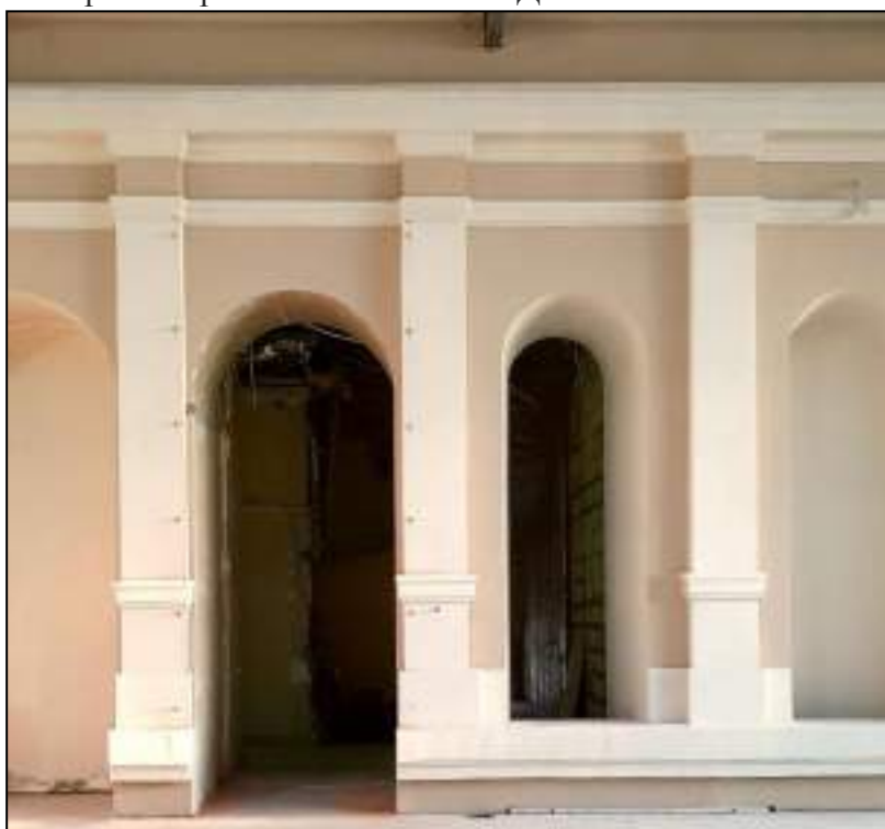
84. Интерьеры (второй этаж) бывшего внутреннего двора, перекрытого в настоящее время. Фрагмент. Выявленный объект культурного наследия «Здание вокзала», расположенный по адресу: Санкт-Петербург, наб. Обводного канала, д. 118, лит. С, входящий в ансамбль выявленного объекта культурного наследия «Комплекс построек Варшавского вокзала». Дата съемки: 20.12.2021.
