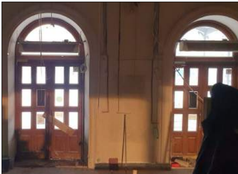
29. Фрагмент интерьера: исторические дверные проемы. Выявленный объект культурного наследия «Здание вокзала», расположенный по адресу: Санкт-Петербург, наб. Обводного канала, д. 118, лит. С, входящий в ансамбль выявленного объекта культурного наследия «Комплекс построек Варшавского вокзала». Дата съемки: 20.12.2021.
