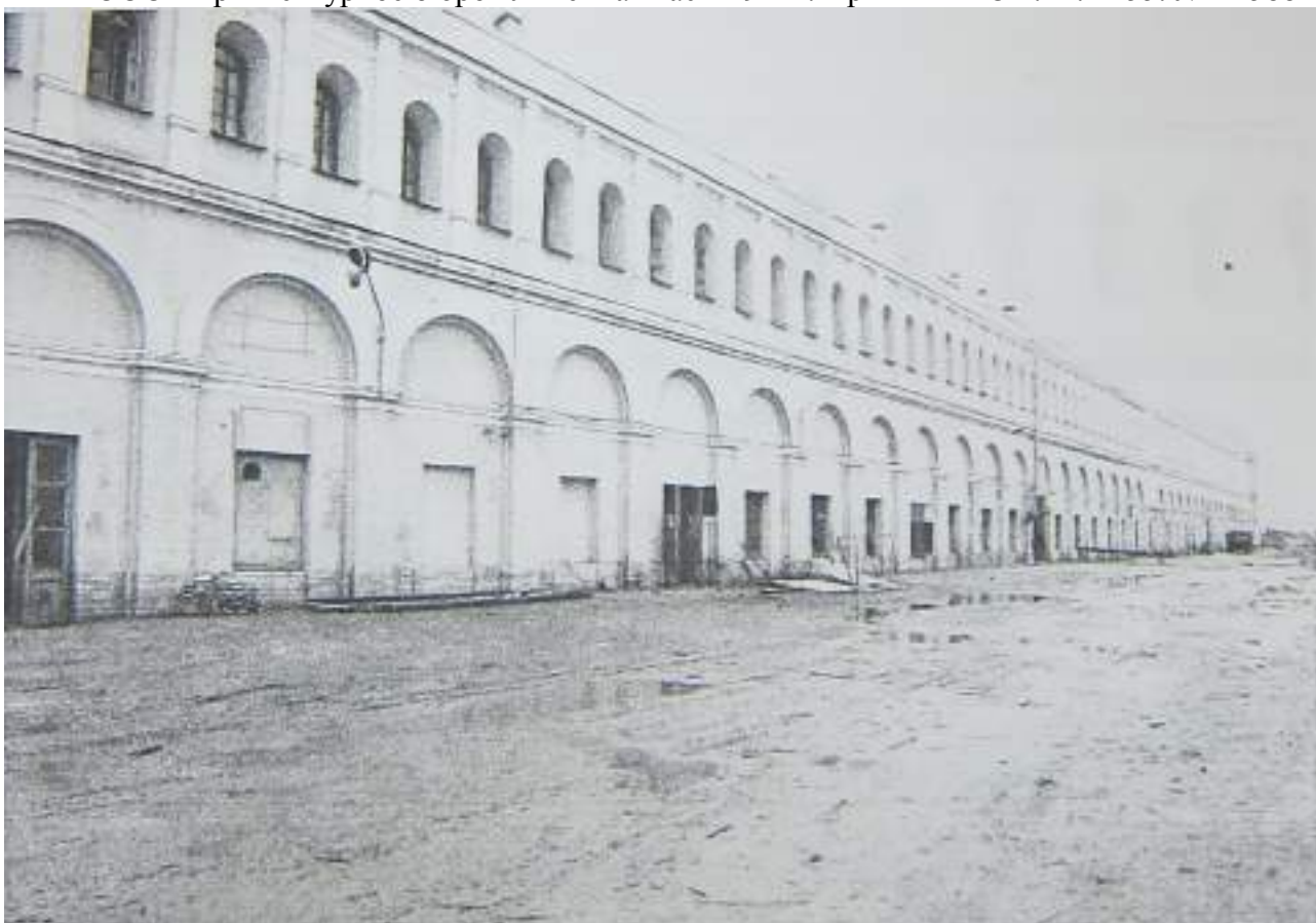
97. Фрагмент внутренней стены восточного корпуса. Вид с северо-запада. 2003г. ООО «Архитектурное бюро «Литейная часть-91»». Архив КГИОП. Ф. 1155. № Н-5881.
