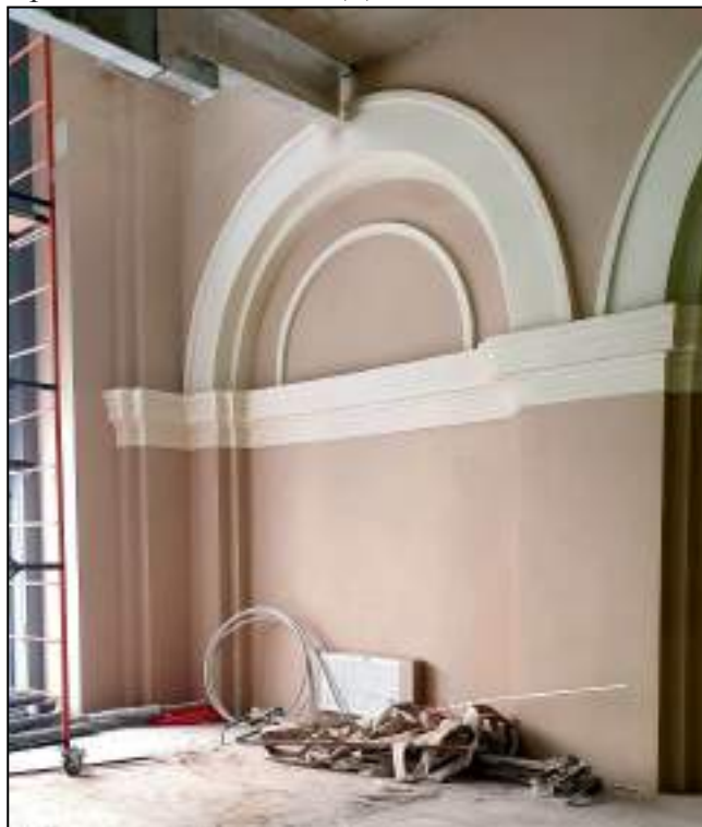
20. Фрагмент интерьера бывшего внутреннего двора, перекрытого в настоящее время. Оформление оконных проемов нижнего уровня – профилированные архивольты на импостах; профилированные карнизы. Выявленный объект культурного наследия «Здание вокзала», расположенный по адресу: Санкт-Петербург, наб. Обводного канала, д. 118, лит. С, входящий в ансамбль выявленного объекта культурного наследия «Комплекс построек Варшавского вокзала». Дата съемки: 20.12.2021.
