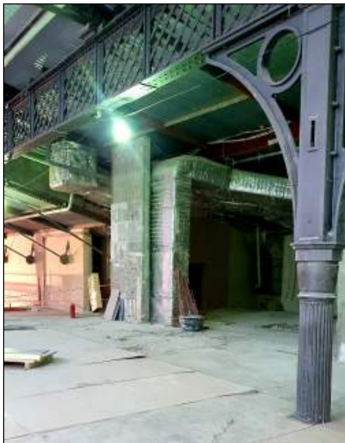
41. Фрагмент фонаря в коньке крыши дебаркадера. Металлическая колонна дебаркадера. Выявленный объект культурного наследия «Здание вокзала», расположенный по адресу: Санкт-Петербург, наб. Обводного канала, д. 118, лит. С, входящий в ансамбль выявленного объекта культурного наследия «Комплекс построек Варшавского вокзала». Дата съемки: 20.12.2021.
