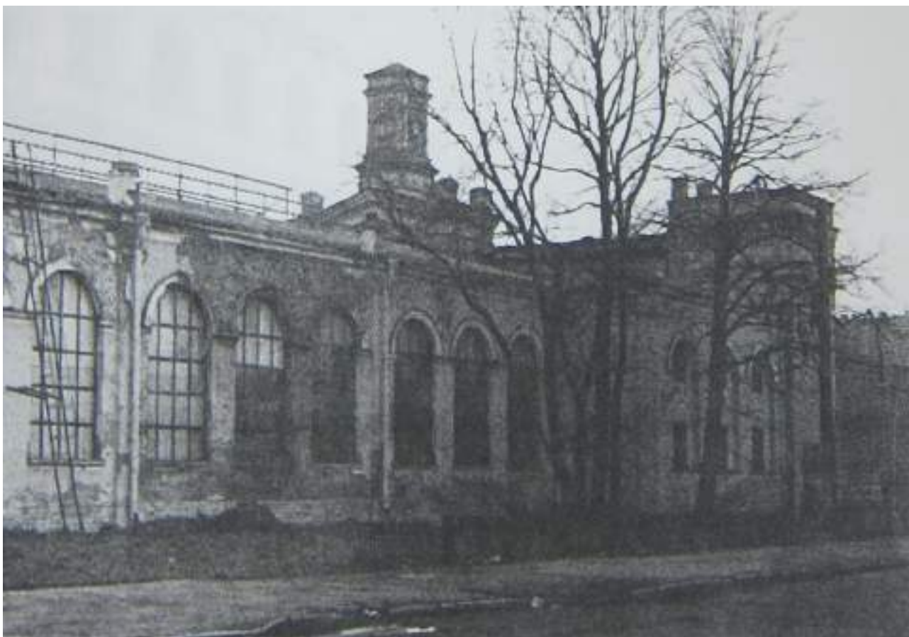
96. Лицевой фасад стены дебаркадера. Фрагмент. Вид с юго-востока. 2003г. ООО «Архитектурное бюро «Литейная часть-91»». Архив КГИОП. Ф. 1155. № Н-5881.
