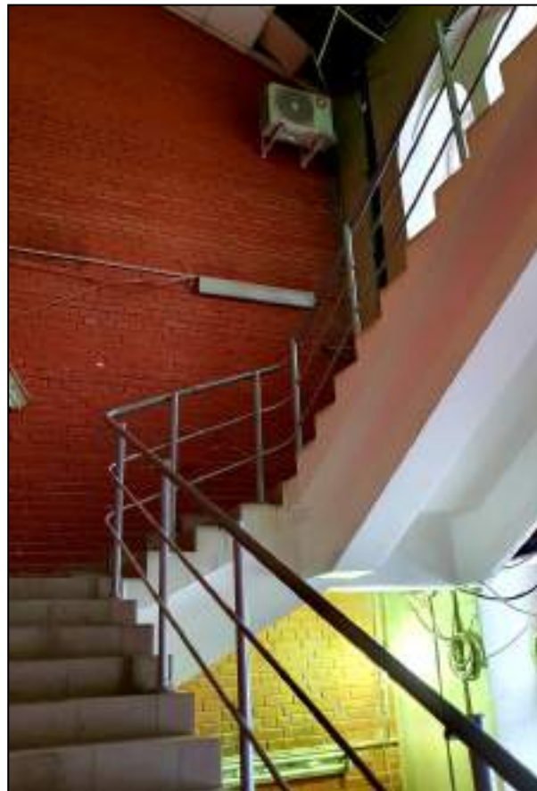
49. Интерьер второго этажа. Историческое местоположение лестницы. Выявленный объект культурного наследия «Здание вокзала», расположенный по адресу: Санкт-Петербург, наб. Обводного канала, д. 118, лит. С, входящий в ансамбль выявленного объекта культурного наследия «Комплекс построек Варшавского вокзала». Дата съемки: 20.12.2021.
