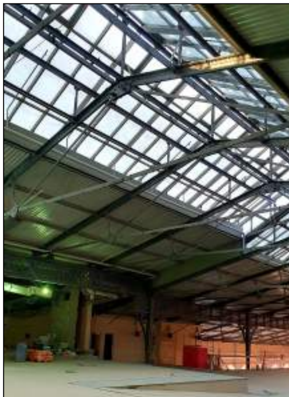
40. Фонарь в коньке крыши дебаркадера. Металлические фермы конструкции. Выявленный объект культурного наследия «Здание вокзала», расположенный по адресу: Санкт-Петербург, наб. Обводного канала, д. 118, лит. С, входящий в ансамбль выявленного объекта культурного наследия «Комплекс построек Варшавского вокзала». Дата съемки: 20.12.2021.
