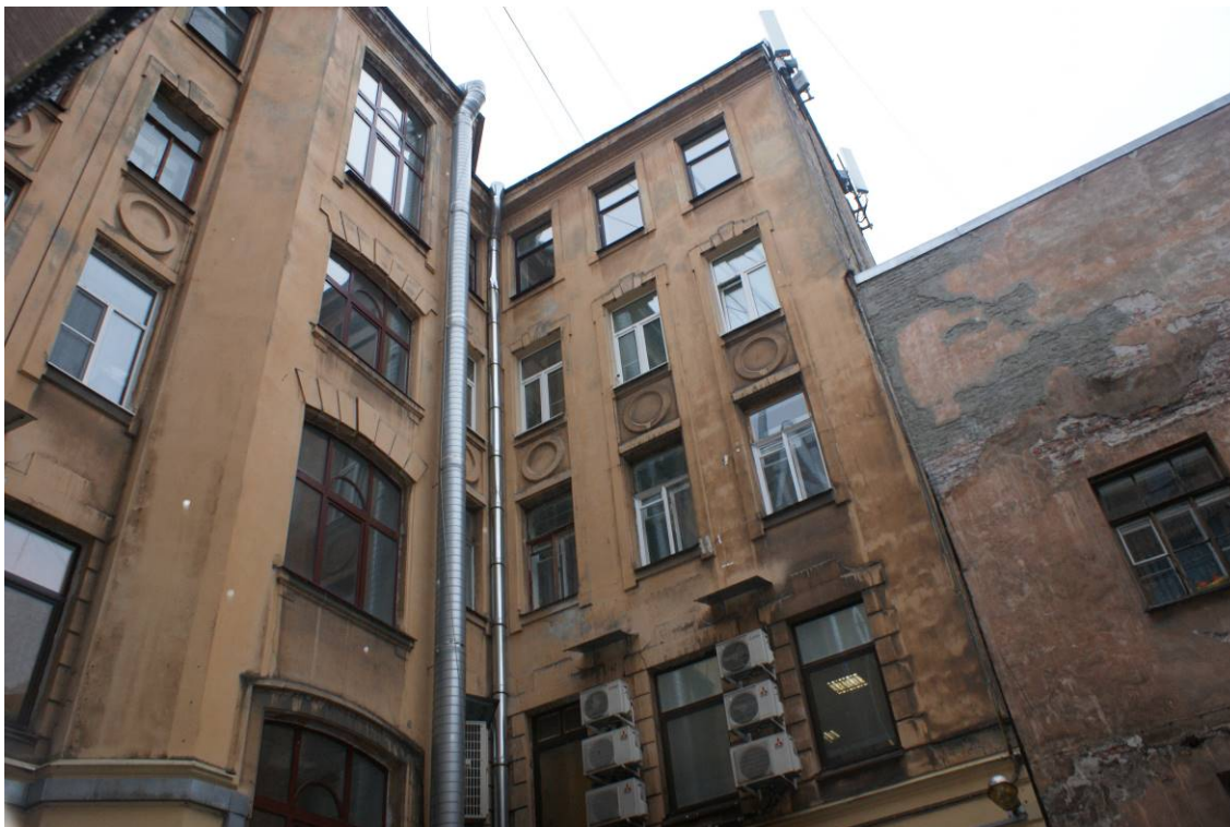
Фото 36. Здание по адресу: г. Санкт-Петербург, Звенигородская улица, дом 2/44, литера А. Юго-восточный дворовой фасад. Фрагмент. Съемка 24.11.2021 г. Трушковский В. Э.
