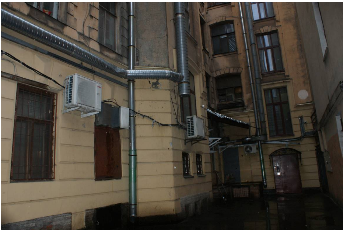
Фото 38. Здание по адресу: г. Санкт-Петербург, Звенигородская улица, дом 2/44, литера А. Северо-восточный дворовой фасад. Фрагмент. Съемка 24.11.2021 г. Трушковский В. Э.
