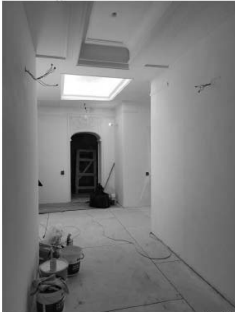
38. Объект культурного наследия регионального значения «Дом М.П. Толстого» (г. Санкт-Петербург, Фонтанки р. наб., 54; Рубинштейна ул., 15-17). Помещение квартиры № 563.
