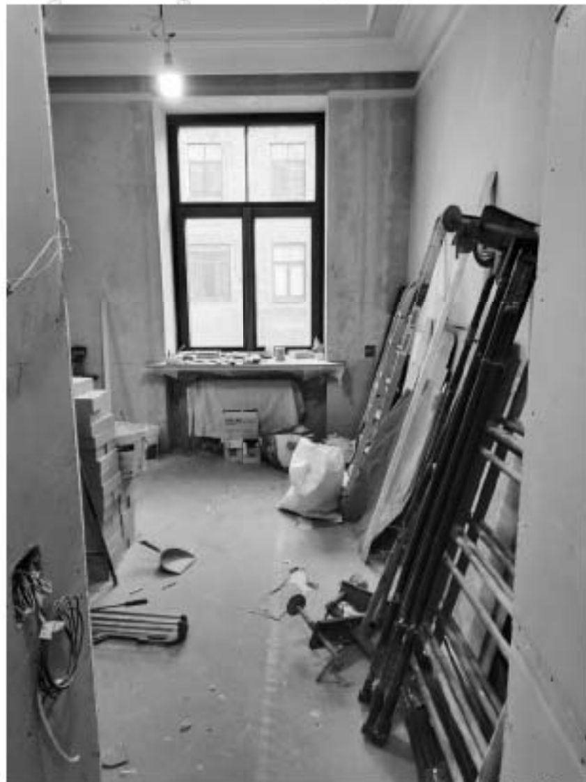
21. Объект культурного наследия регионального значения «Дом М.П. Толстого» (г. Санкт-Петербург, Фонтанки р. наб., 54; Рубинштейна ул., 15-17). Помещение квартиры № 563.
