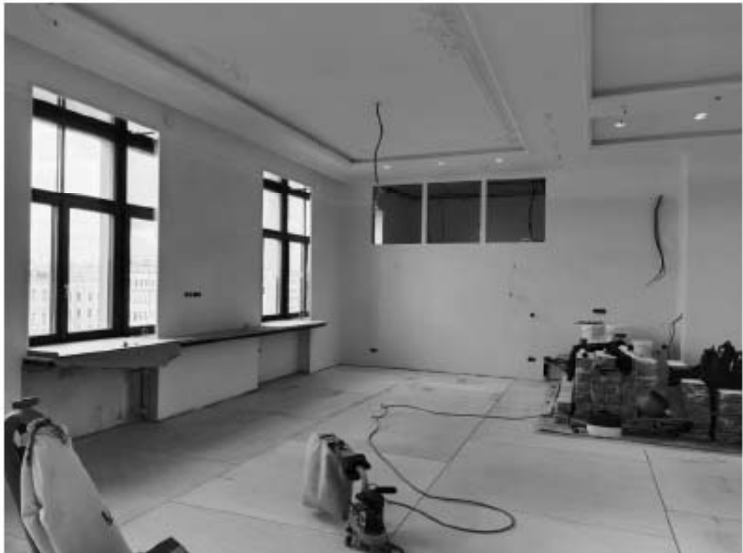
33. Объект культурного наследия регионального значения «Дом М.П. Толстого» (г. Санкт-Петербург, Фонтанки р. наб., 54; Рубинштейна ул., 15-17). Помещение квартиры № 563.
