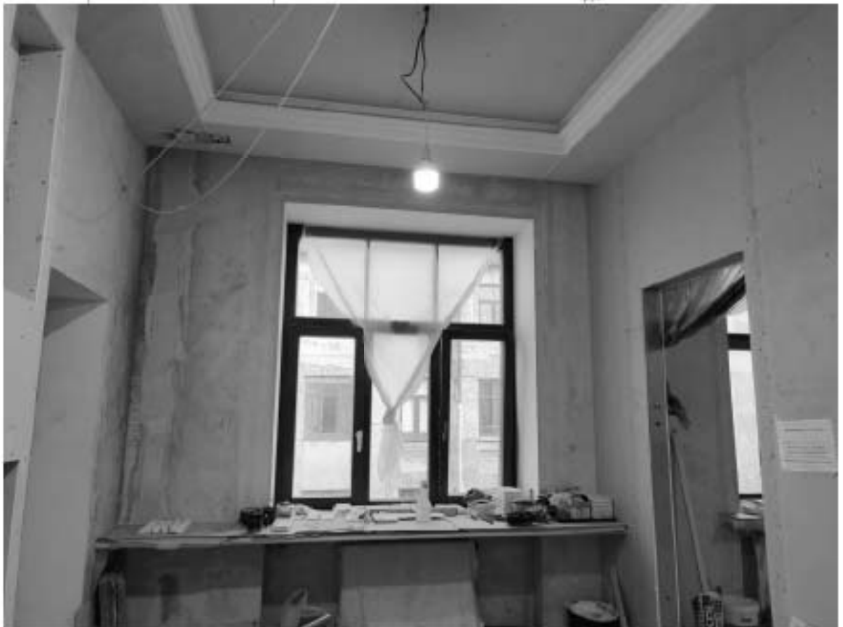
25. Объект культурного наследия регионального значения «Дом М.П. Толстого» (г. Санкт-Петербург, Фонтанки р. наб., 54; Рубинштейна ул., 15-17). Помещение квартиры № 563.
