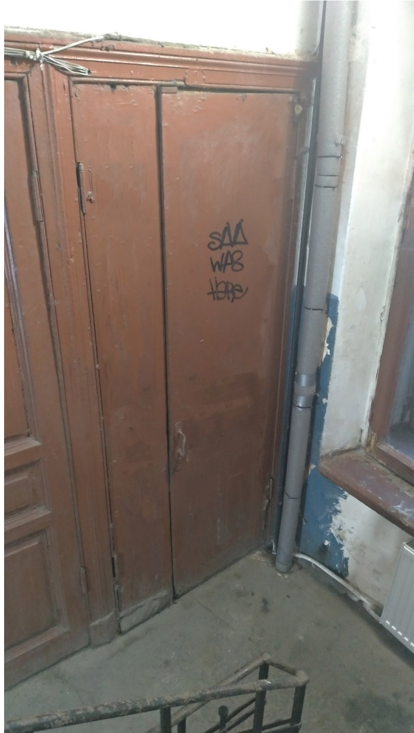
5. Дверное заполнение входного проема кв. №2 с «черной» лестницы в уровне 2-го этажа дворового фасада объекта культурного наследия регионального значения «Дом Т.П. Павловой», расположенного по адресу: г. Санкт-Петербург, Конная ул., д. 8, литера А. 05.03.2021.
