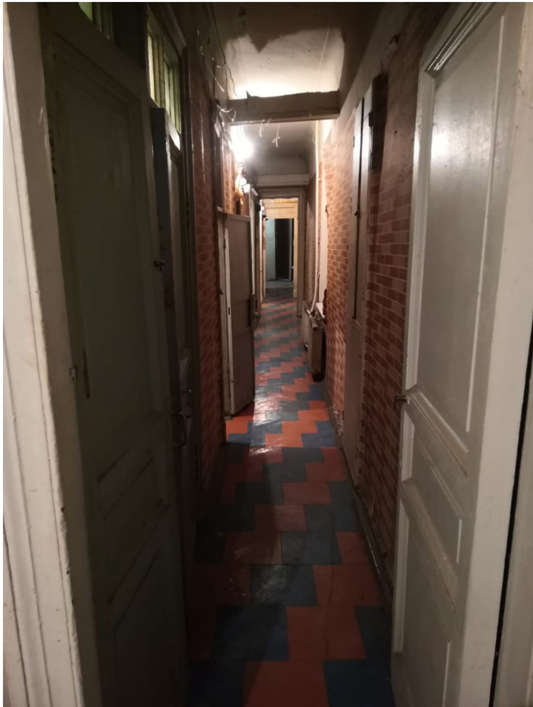
6. Помещение №13 кв. №2 в уровне 2-го этажа объекта культурного наследия регионального значения «Дом Т.П. Павловой», расположенного по адресу: г. Санкт-Петербург, Конная ул., д. 8, литера А. 05.03.2021.
