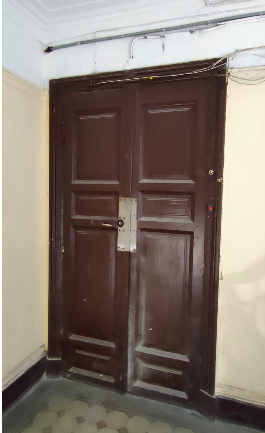
4. Дверное заполнение входного проема кв. №2 с парадной лестницы в уровне 2-го этажа дворового фасада объекта культурного наследия регионального значения «Дом Т.П. Павловой», расположенного по адресу: г. Санкт-Петербург, Конная ул., д. 8, литера А. 05.03.2021.
