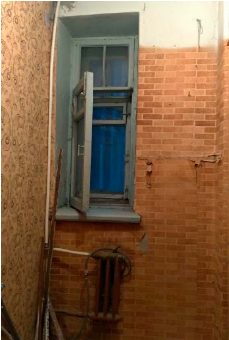
15. Помещение №6 кв. №2 в уровне 2-го этажа объекта культурного наследия регионального значения «Дом Т.П. Павловой», расположенного по адресу: г. Санкт-Петербург, Конная ул., д. 8, литера А. 05.03.2021.
