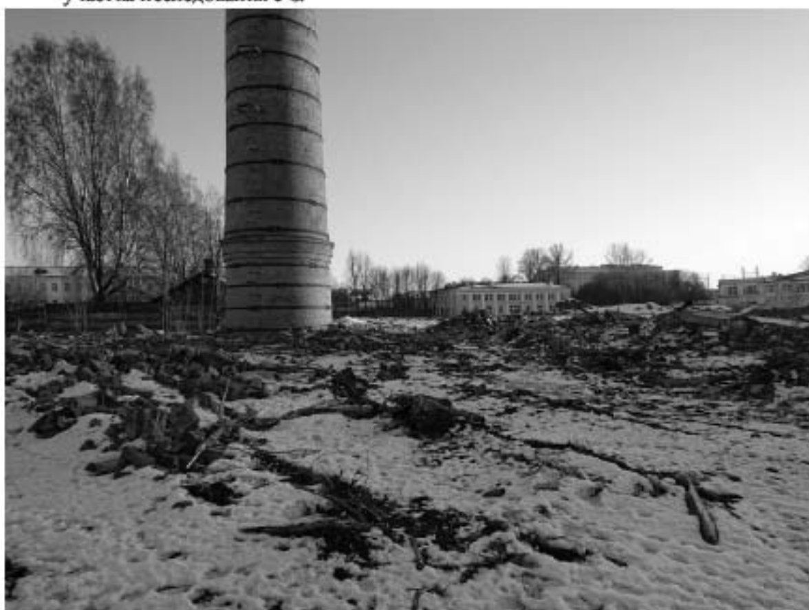
Точка фотофиксации 3. Центральная часть участка, восточная граница у дымовой трубы. Состояние территории после сноса зданий. Вид с 3.
