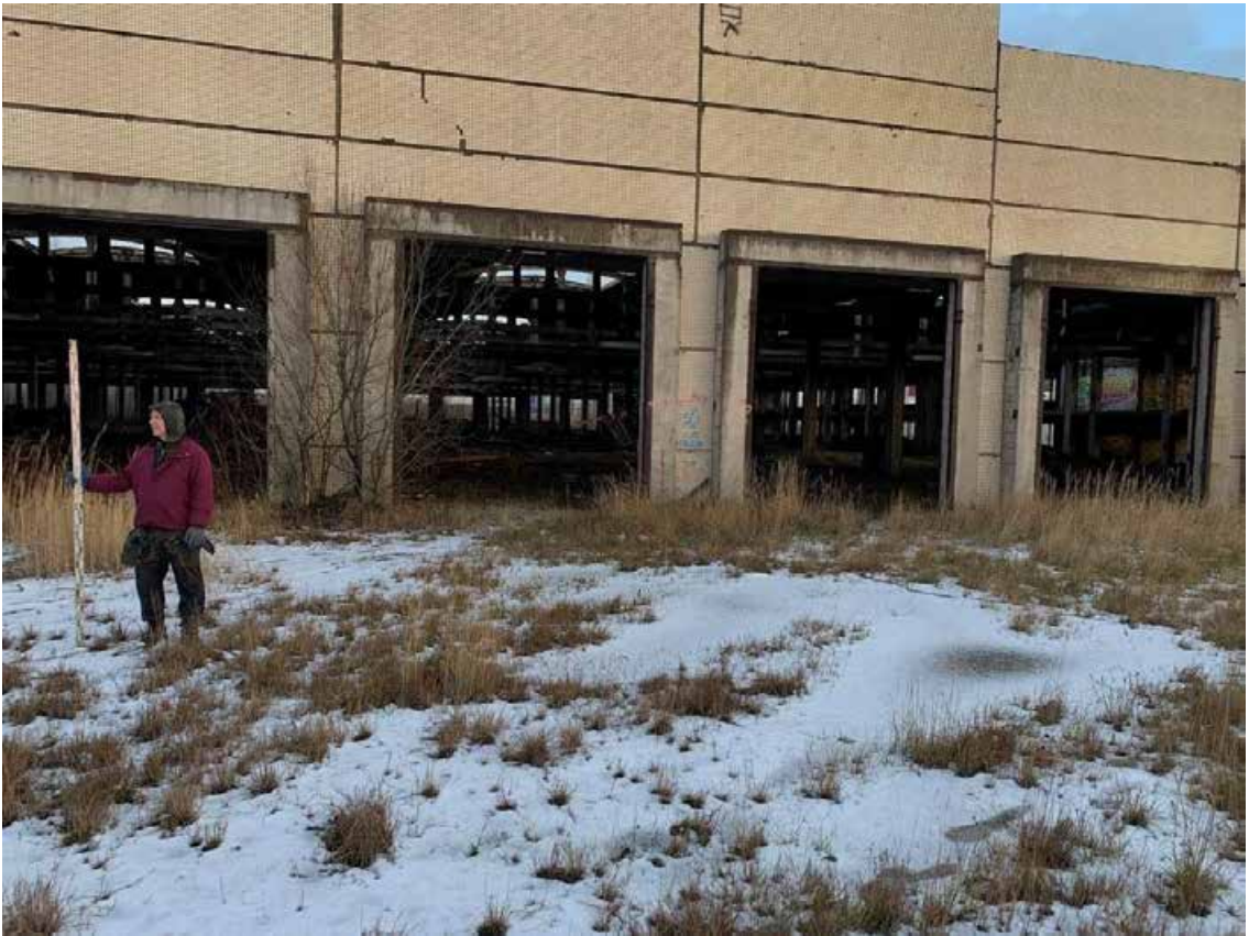
Рис. 46. Санкт-Петербург, Красногвардейский район. Точка съемки 9. Общий вид участка обследования. Вид с ВЮВ.
