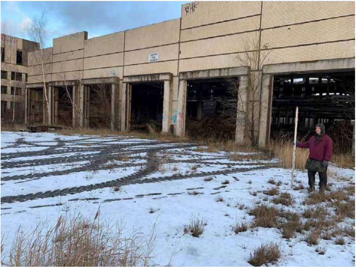
Рис. 45. Санкт-Петербург, Красногвардейский район. Точка съемки 9. Общий вид участка обследования. Вид с СВ.
