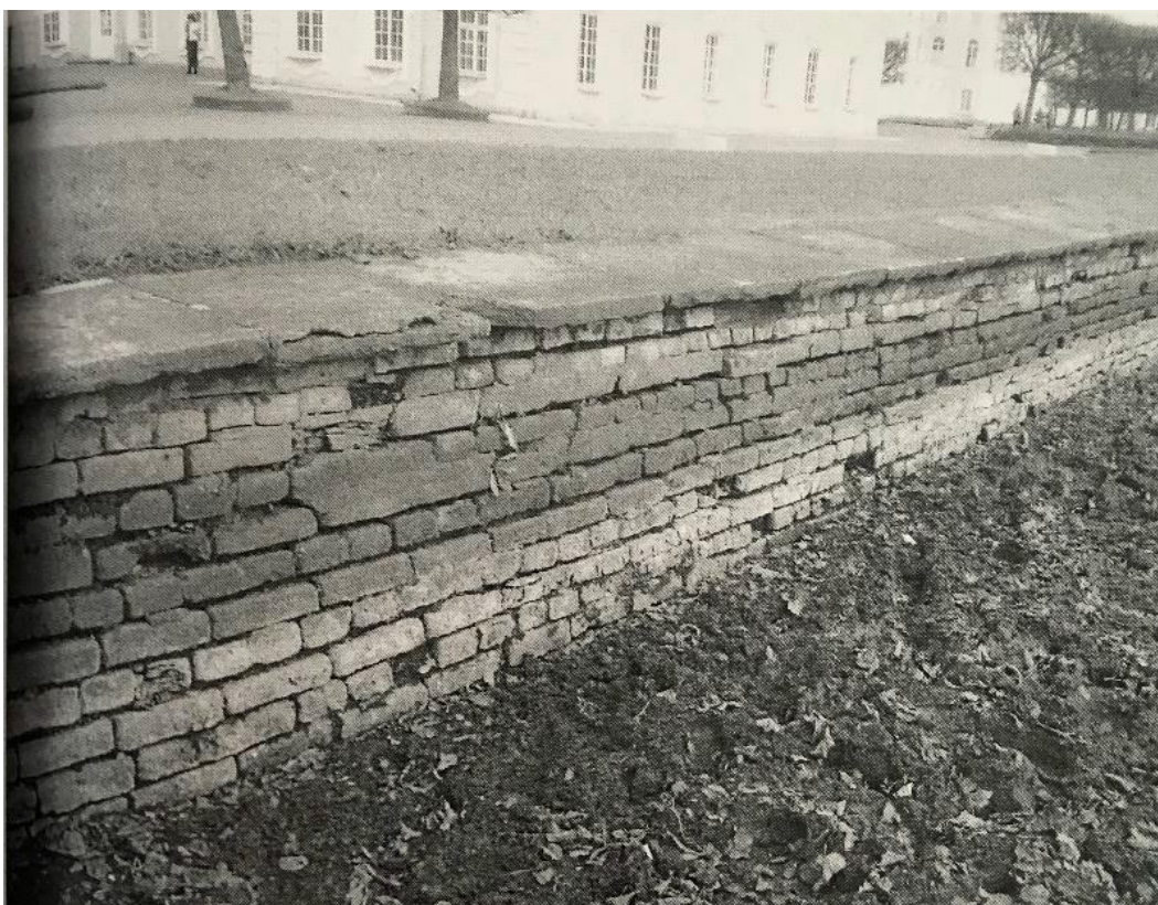
39. Петергоф. Верхний сад. Восточный Квадратный пруд. 2009 г. Состояние восточной подпорной стены пруда до начала противоаварийных работ. (Научный отчёт о проделанной работе», ООО «Феррумленд» 2009 г.). Архив Службы реставрации, реконструкции и капитального ремонта ГМЗ «Петергоф».
