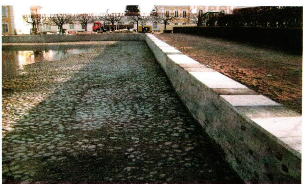
40. Петергоф. Верхний сад. Восточный Квадратный пруд. 2009 г. Состояние дна и восточной подпорной стенки пруда после завершения противоаварийных работ. (Научный отчёт о проделанной работе», ООО «Феррумленд» 2009 г.). Архив Службы реставрации, реконструкции и капитального ремонта ГМЗ «Петергоф».
