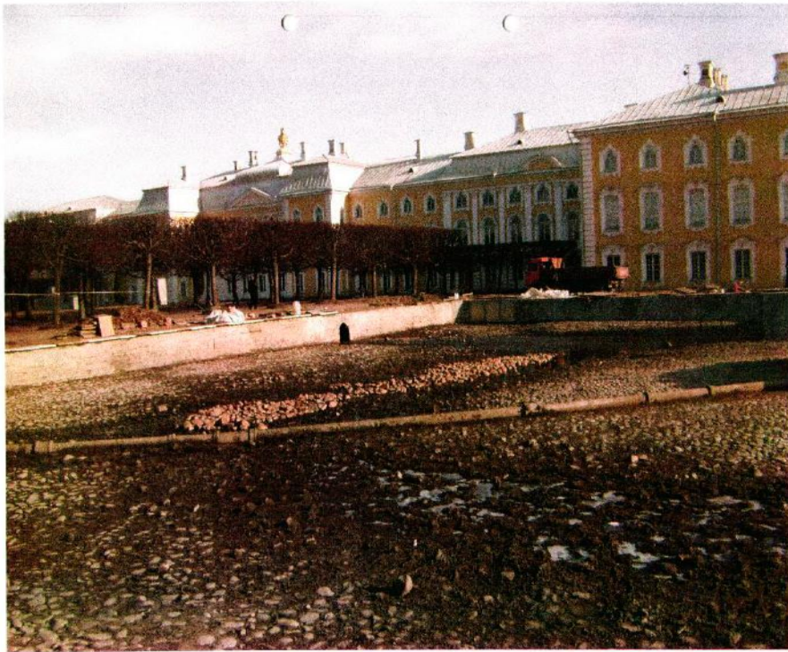
42. Петергоф. Верхний сад. Восточный Квадратный пруд. 2009 г. Состояние дна пруда, арок в подпорных стенках и фонтанного водовода после завершения противоаварийных работ. (Научный отчёт о проделанной работе), ООО «Феррумленд» 2009 г.). Архив Службы реставрации, реконструкции и капитального ремонта ГМЗ «Петергоф».
