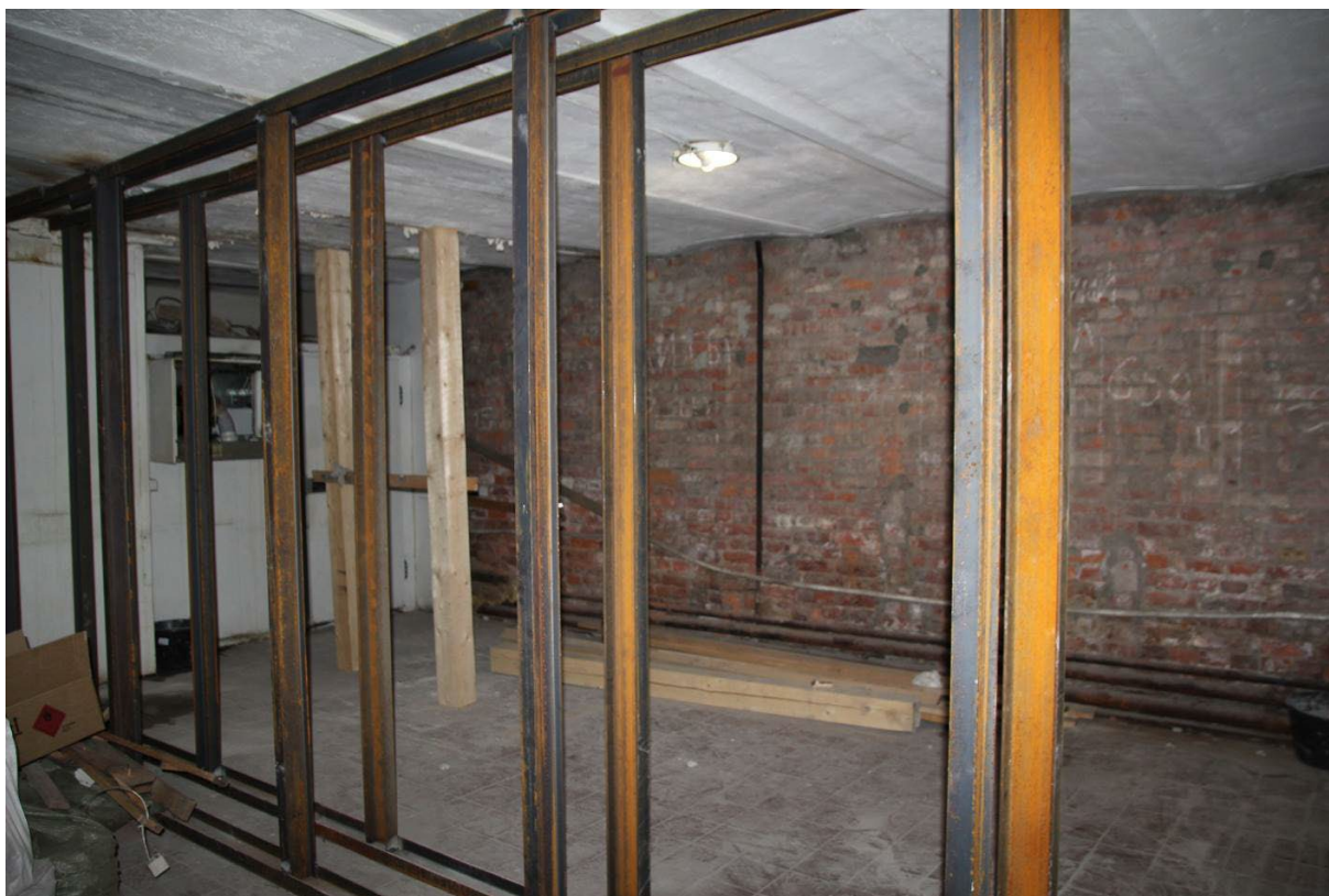
Фото №7. Общій вид помещения 11-Н (1). Вид на морозильные камеры 11-Н (2,3)
