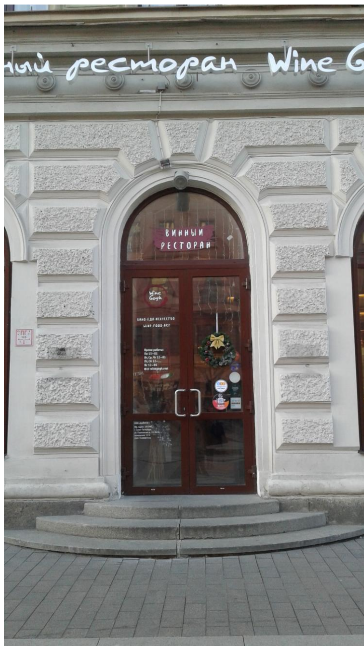
4. Выявленный объект культурного наследия «Дома немецкой лютеранской церкви св. Петра» (Невский пр., 22-24). Дом № 7 по Малой Конюшенной улице. Главный фасад. Вход (главный вход) в помещение 34-Н. Дверное заполнение (позднее).
