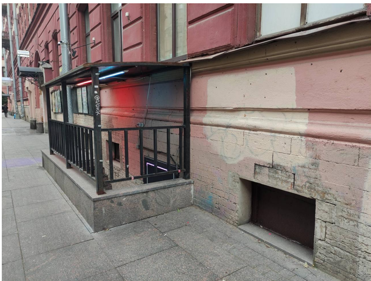
Фото 2. Фрагмент лицевого фасада выявленного объекта культурного наследия «Дом Р.К. Сан-Галли», приямок
