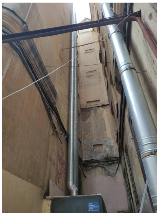
Фото 6. Фрагмент дворового фасада выявленного объекта культурного наследия «Дом Р.К. Сан-Галли», воздуховоды
