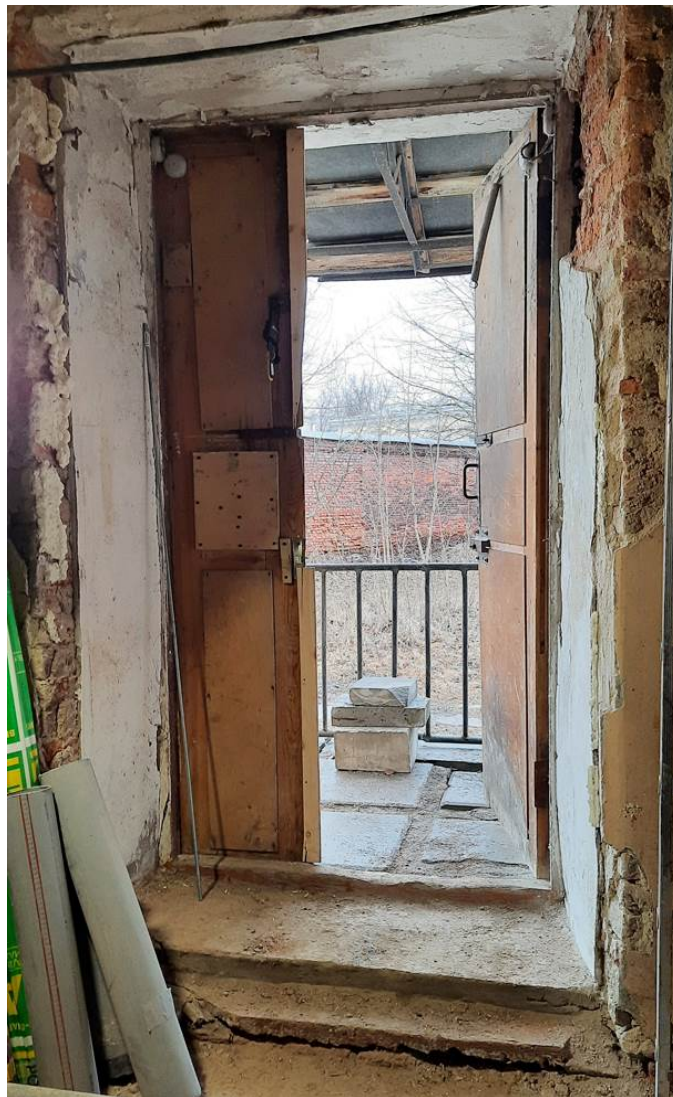
8. Объект культурного наследия регионального значения «3-я линия фруктовых теплиц с квартирами садовников и конторой» в составе объекта культурного наследия регионального значения комплекса «Дворцовые теплицы». Входная дверь в помещение 5-Н. Вид из интерьера.
