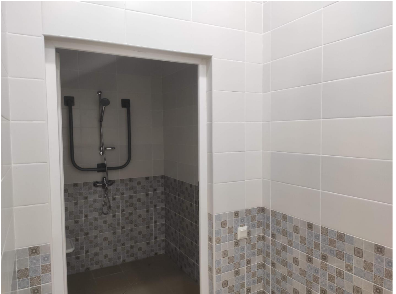
Илл. 85. Душ в помещении 2 этажа в восточном объеме здания.
