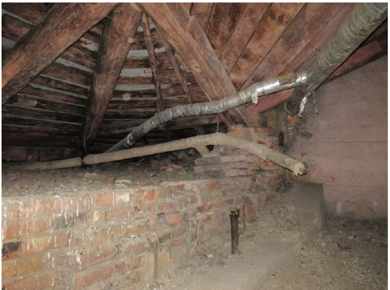
13. Стропильная система объекта культурного наследия регионального значения «Быв. дом Белозерского», расположенного по адресу: г. Санкт-Петербург, ул. Куйбышева, д. 25, литера А. 15.10.2021.
