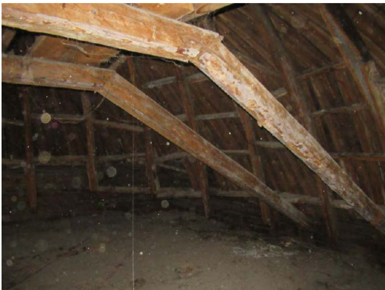
18. Конструкции купола объекта культурного наследия регионального значения «Быв. дом Белозерского», расположенного по адресу: г. Санкт-Петербург, ул. Куйбышева, д. 25, литера А. 15.10.2021.
