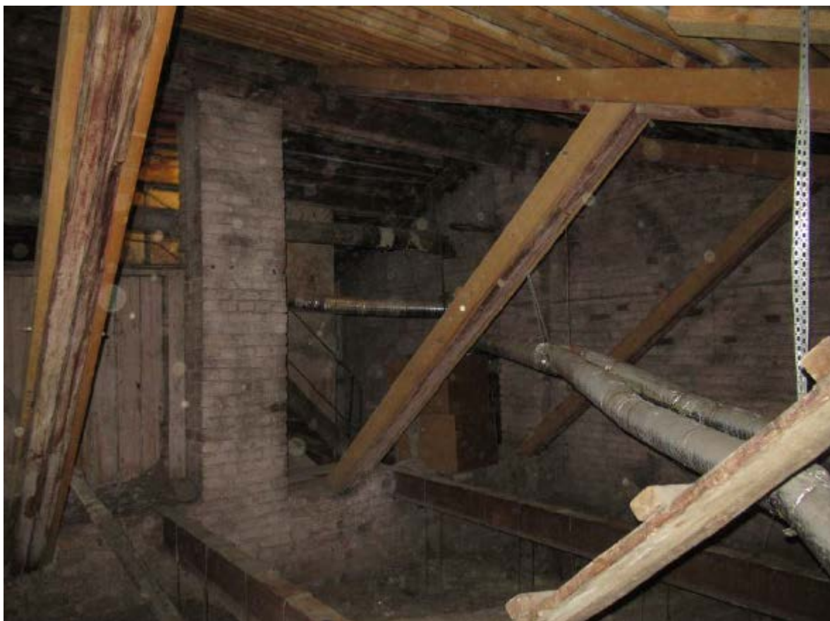
10. Стропильная система объекта культурного наследия регионального значения «Быв. дом Белозерского», расположенного по адресу: г. Санкт-Петербург, ул. Куйбышева, д. 25, литера А. 15.10.2021.
