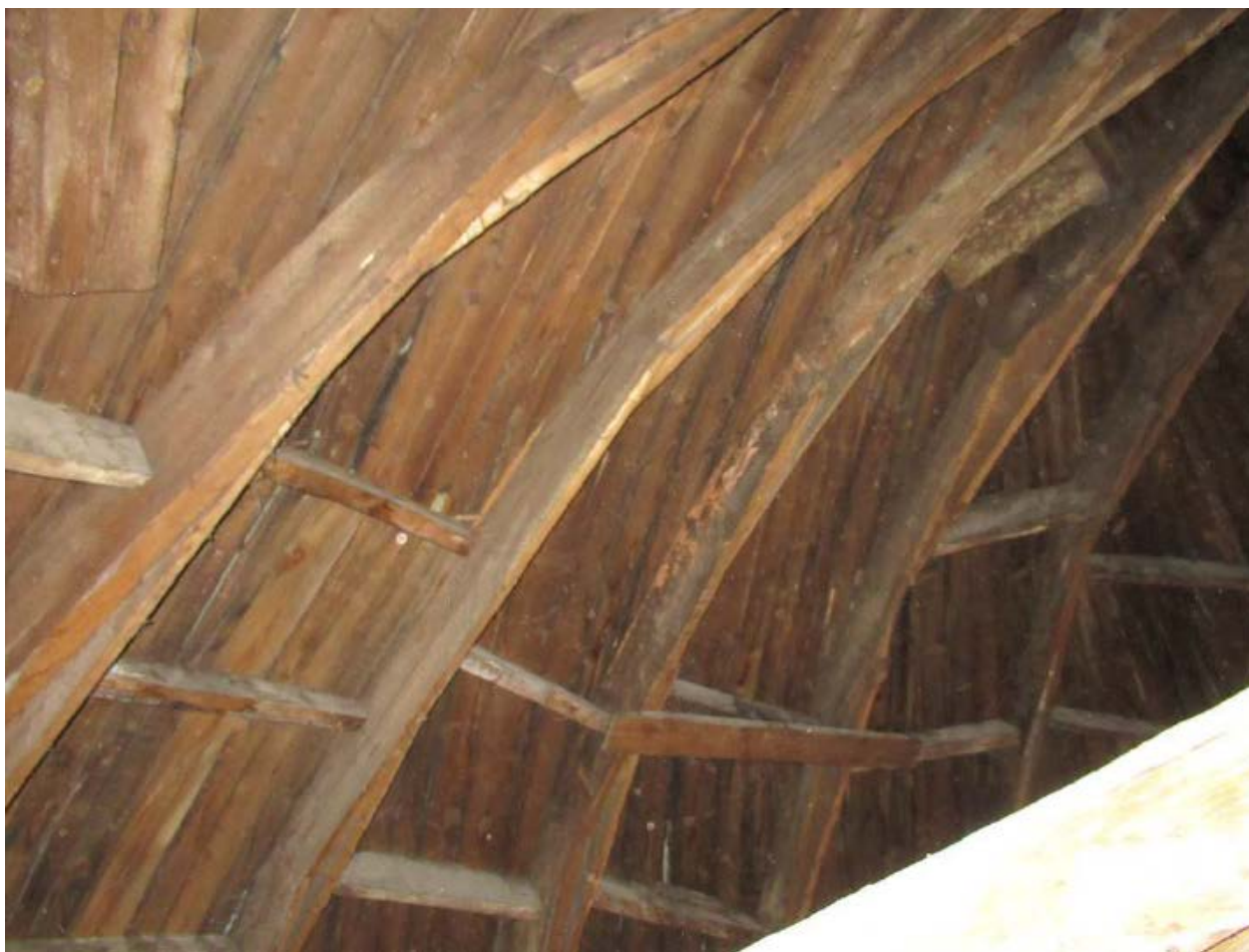
16. Конструкции купола объекта культурного наследия регионального значения «Быв. дом Белозерского», расположенного по адресу: г. Санкт-Петербург, ул. Куйбышева, д. 25, литера А. 15.10.2021.
