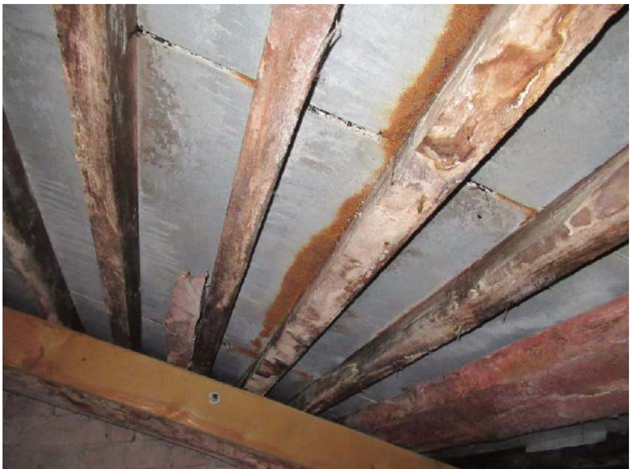
8. Обрешетка и кровля объекта культурного наследия регионального значения «Быв. дом Белозерского», расположенного по адресу: г. Санкт-Петербург, ул. Куйбышева, д. 25, литера А. 15.10.2021.
