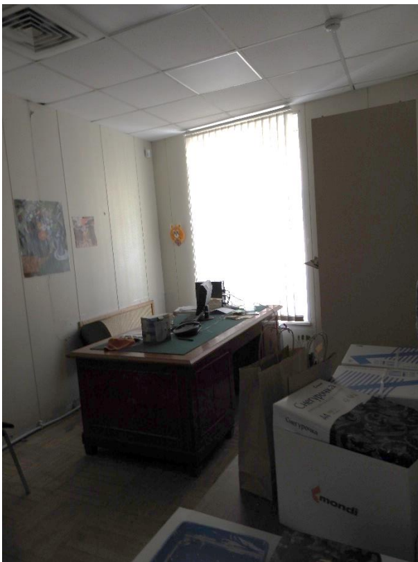
34. «Павильоны (два), 1821-1824 г.г., арх.Квадри Д.И.», входящие в состав объекта культурного наследия федерального значения «Дворец Шереметевых», наб. р. Фонтанки, д. 34, лит. А/Литейный пр., д.51, лит.А. Помещение №4. Общий вид. Фото 28.03.2022г.
