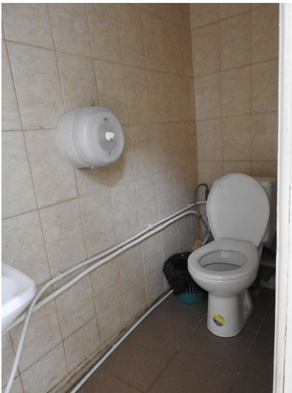
10. «Павильоны (два), 1821-1824 г.г., арх.Квадри Д.И.», входящие в состав объекта культурного наследия федерального значения «Дворец Шереметевых», наб. р. Фонтанки, д. 34, лит. А/Литейный пр., д.51, лит.А. Помещение №2. Фрагмент. Фото 28.03.2022г.
