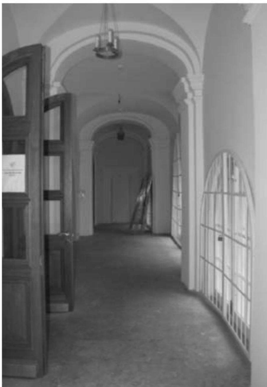
Фото 10. ОКН федерального значения «Корпус просфорный с северными воротами главного двора» (наб. реки Монастырки, дом 1, литера Г). Галерея первого этажа в осях Б-Г/5-6. Съёмка 27.09.2021 г.
