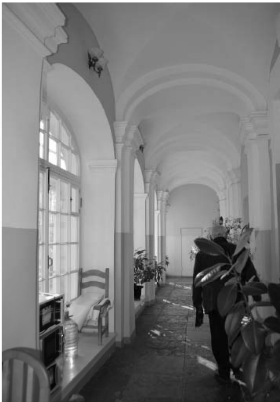
Фото 08. ОКН федерального значения «Корпус просфорный с северными воротами главного двора» (наб. реки Монастырки, дом 1, литера Г). Галерея первого этажа в осях Б-Г/4-5. Съёмка 27.09.2021 г.
