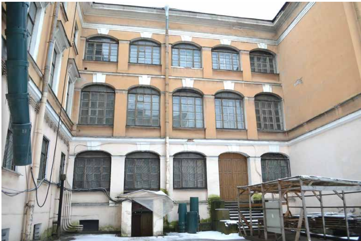
Фото 1.23. Духовная академия. Главное здание (наб. Обводного канала, 7, литер Г). Западный дворовый фасад. Южное крыльцо. Съёмка 01.12.2021 г.
