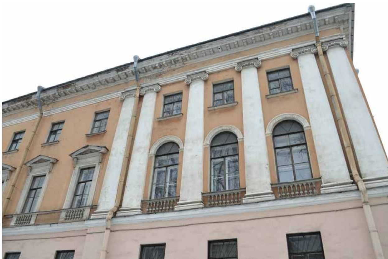
Фото 1.8. Духовная академия. Главное здание (наб. Обводного канала, 7, литер Г). Восточный фасад. Оконные проёмы в уровне второго и третьего этажей. Съёмка 01.12.2021 г.
