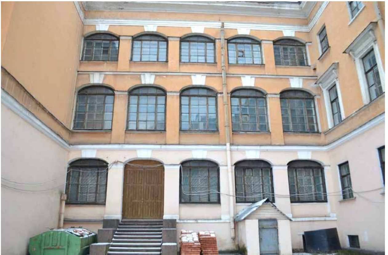
Фото 1.15. Духовная академия. Главное здание (наб. Обводного канала, 7, литер Г). Западный дворовый фасад. Северное крыльцо. Съёмка 01.12.2021 г.
