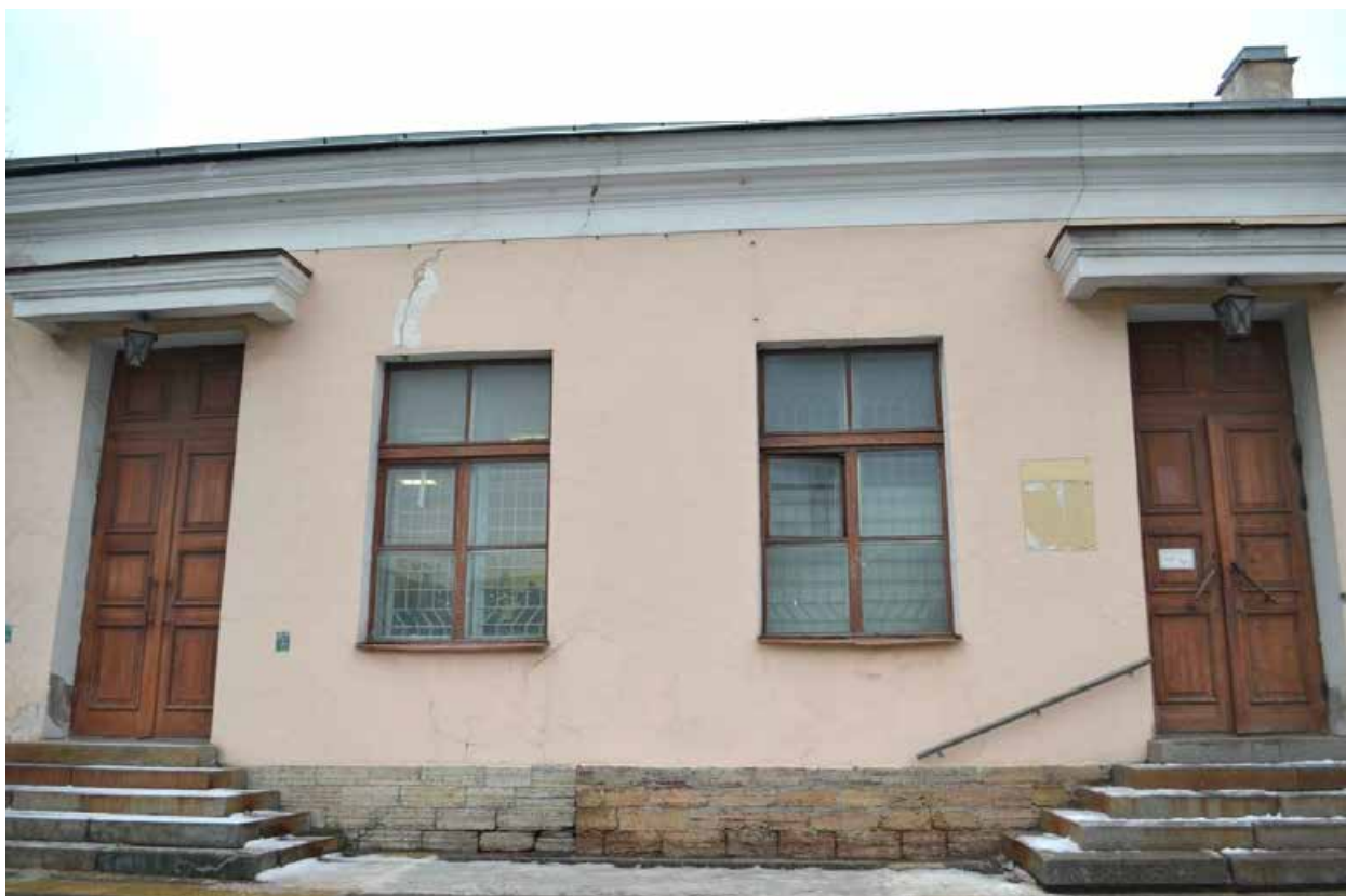
Фото 2.3. Духовная академия. Больничный флигель (наб. Обводного канала, 7, литер А). Южный фасад. Фрагмент. Съёмка 01.12.2021 г.
