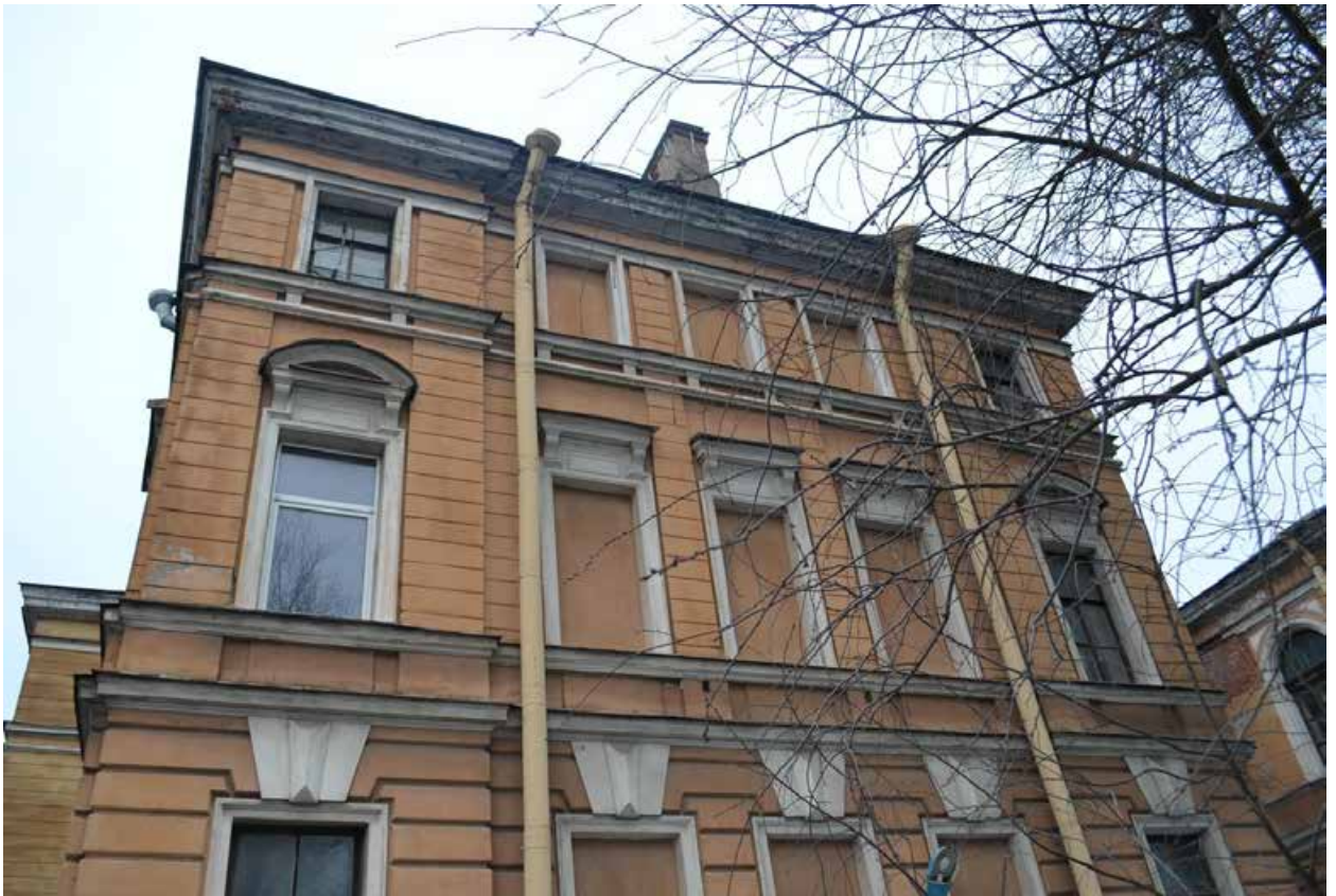
Фото 3.17. Духовная академия. Библиотека (наб. Обводного канала, 11, литер А). Восточный фасад. Фрагмент. Съёмка 01.12.2021 г.
