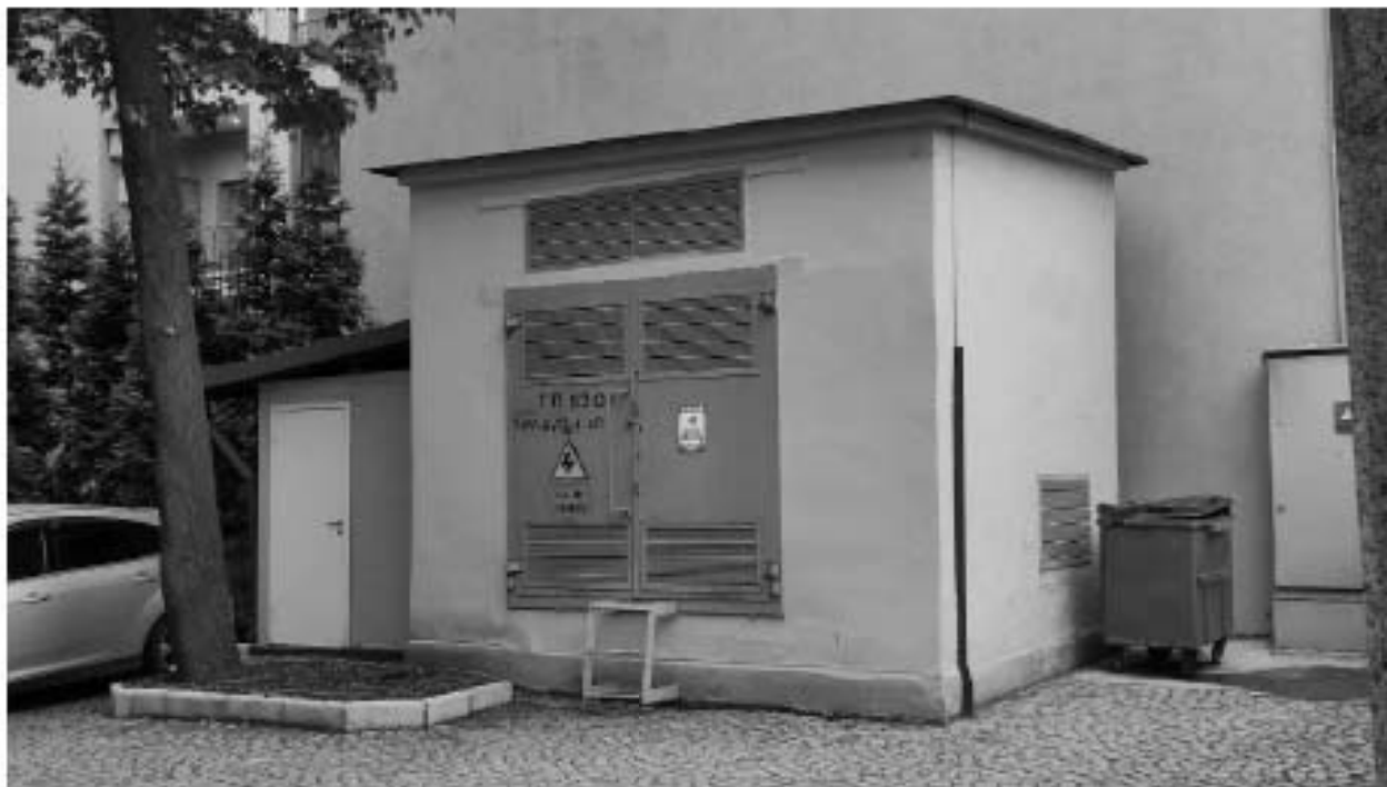
Фото 8. Вид на трансформаторную подстанцию на территории объекта культурного наследия федерального значения «Дом Кочубей М.В.» по адресу: Конногвардейский бульвар д. 7
