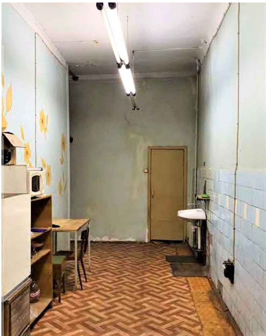
Фото 10. Выявленный объект культурного наследия «Дом М.С. Мальцева (Общества для заклада движимых имуществ)», по адресу: Санкт-Петербург, Литейный пр. д.29, Литер А (Литейный пр. 29). Квартира 33. Дата съемки: 01 сентября 2021 г.
