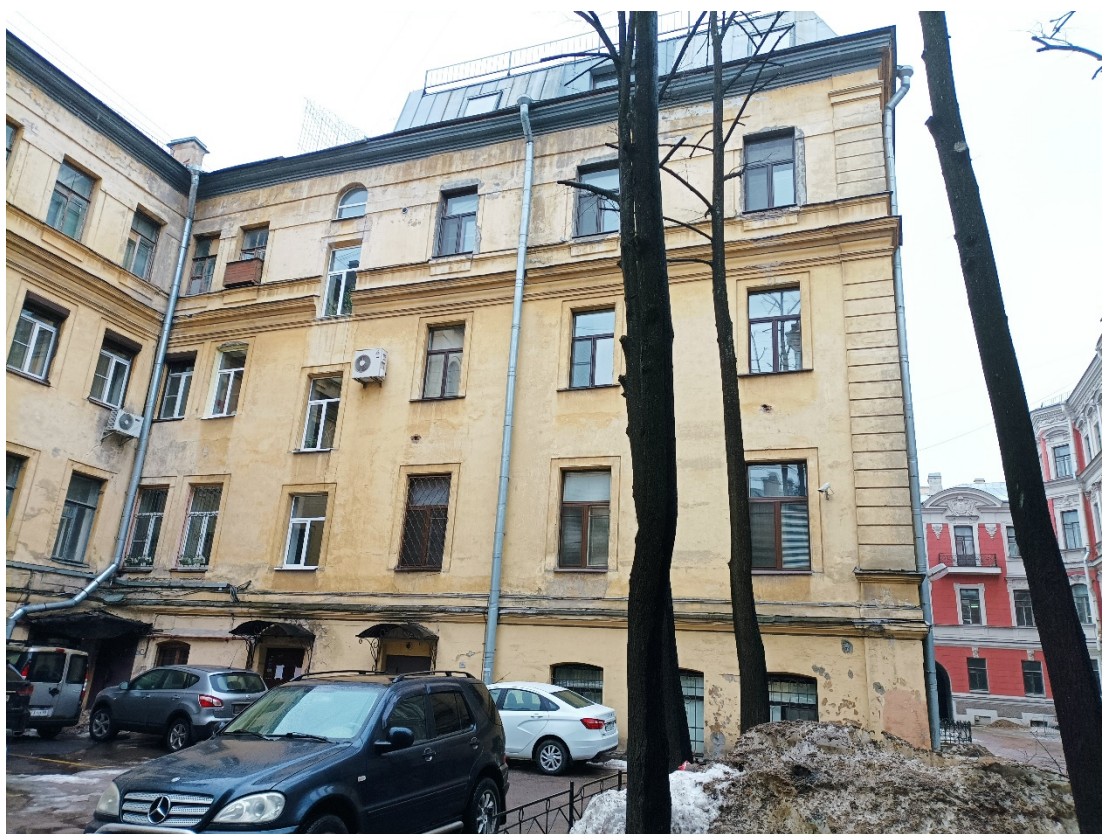
13. Объект культурного наследия регионального значения «Жилой дом Страхового общества «Россия» с садом и оградями», по адресу: г. Санкт-Петербург, Моховая улица, дом 27-29, литера А (Моховая ул., 27-29). Дворовый фасад «Северный корпус». Дата съемки: 04.03.2022г.
