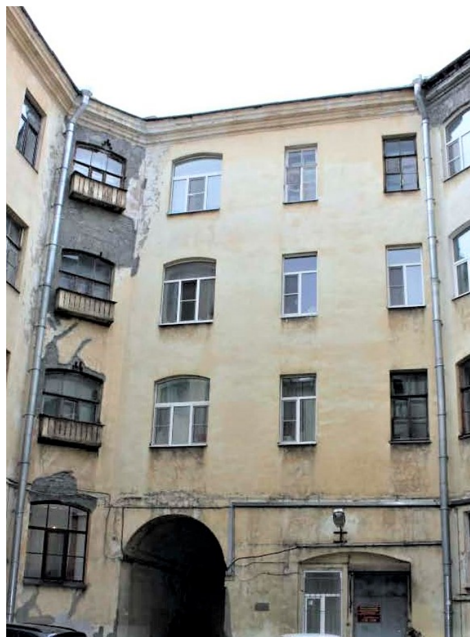
35. Объект культурного наследия регионального значения «Жилой дом Страхового общества «Россия» с садом и оградами», по адресу: г. Санкт-Петербург, Моховая улица, дом 27-29, литера А (Моховая ул., 27-29). Дворовый фасад. Дата съемки: 04.03.2022г.
