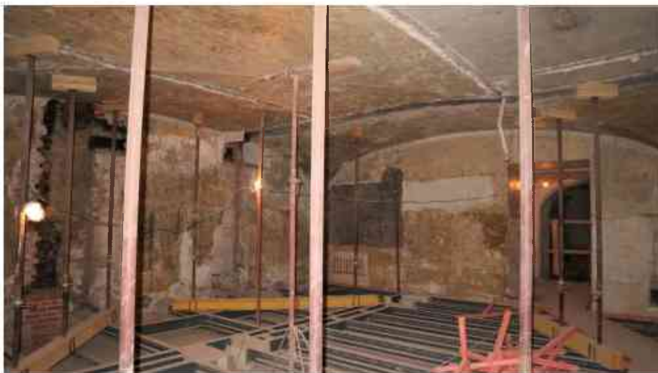
Фото 1.156. 1 этаж, помещение 31Н (16-17), 10Н (4-6).
