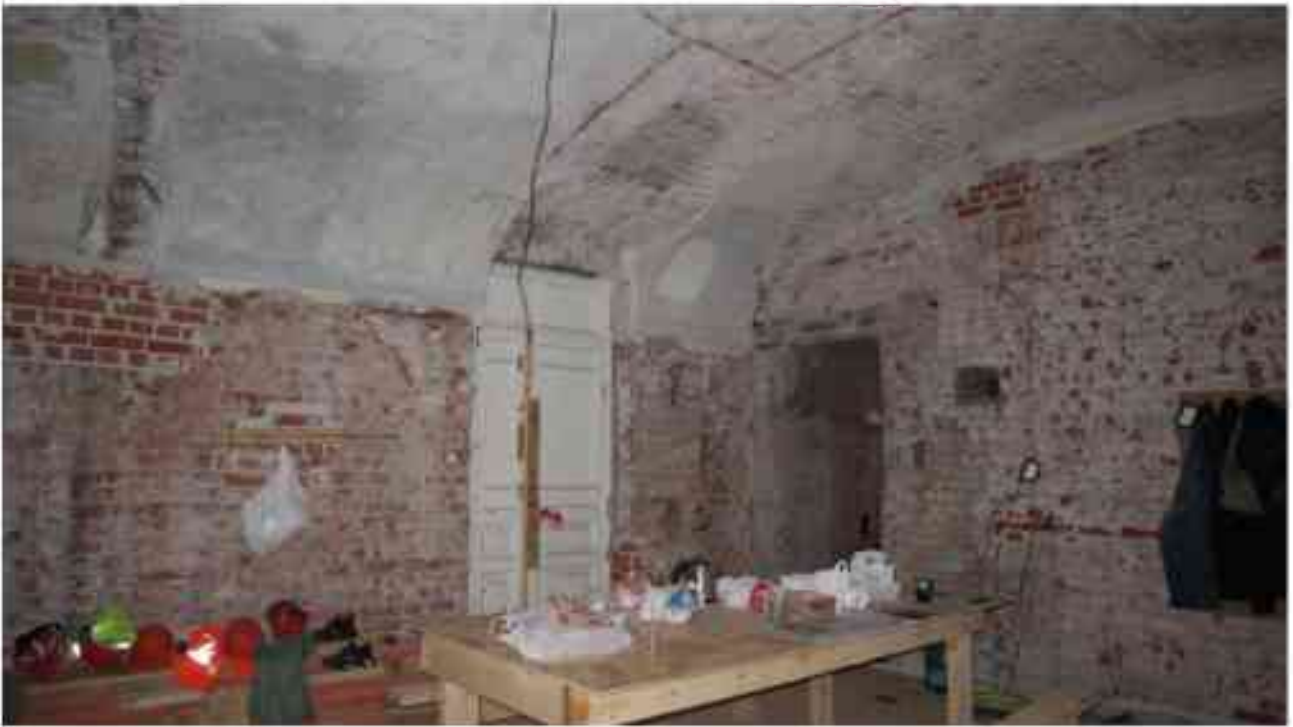
Фото 3.17. 3 этаж, помещение 28Н (40), 27Н (3).
