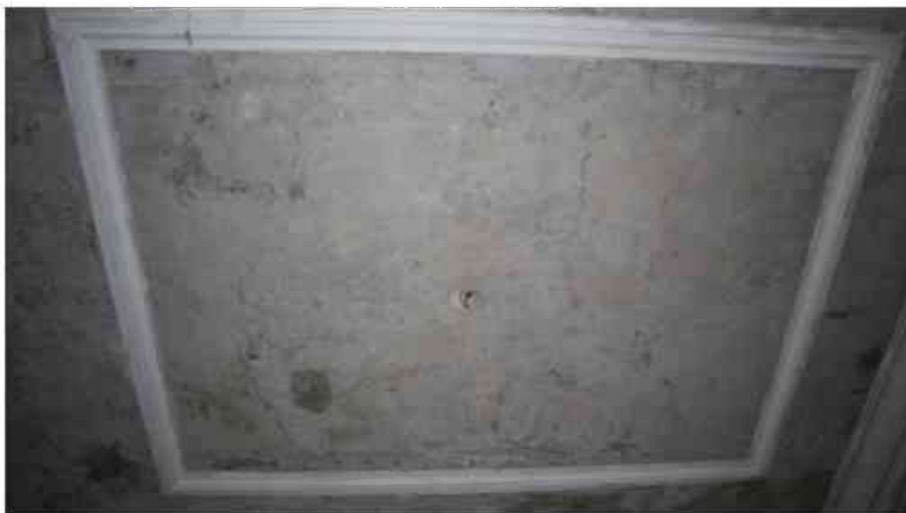
Фото 4.8. 4 этаж, плафон, помещение 33Н (39).
