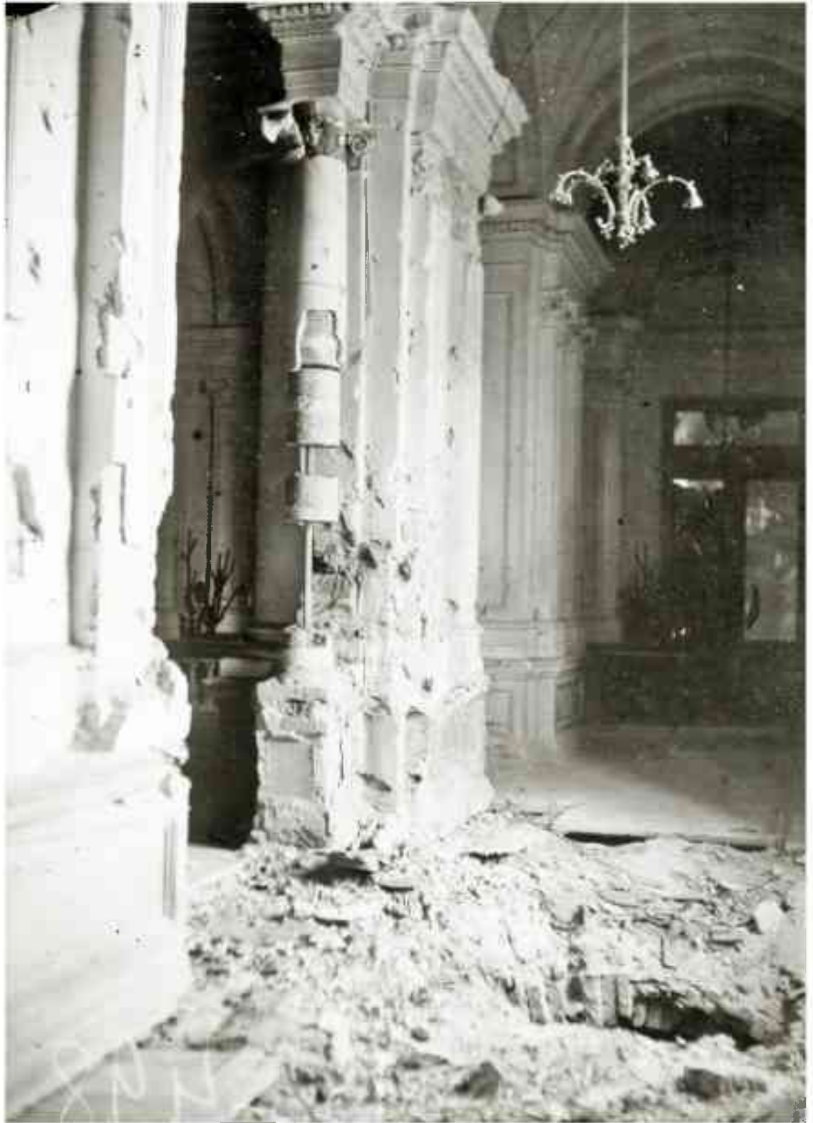
Ил. 179. Стена и часть пола первого этажа Ленинградской государственной консерватории имени Н.А. Римского-Корсакова (Театральная пл., 3), разрушенные в результате взрыва снаряда. 1943 г. Автор съемки неизвестен. ЦГА КФФД. Вр 498. ЦГА СПб. Ф.8557. Оп.9. Д.8. Л.17.
