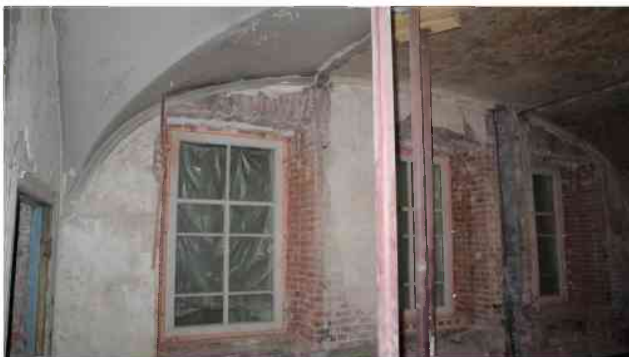
Фото 1.155. 1 этаж, помещение 31Н (16-17), 10Н (4-6).
