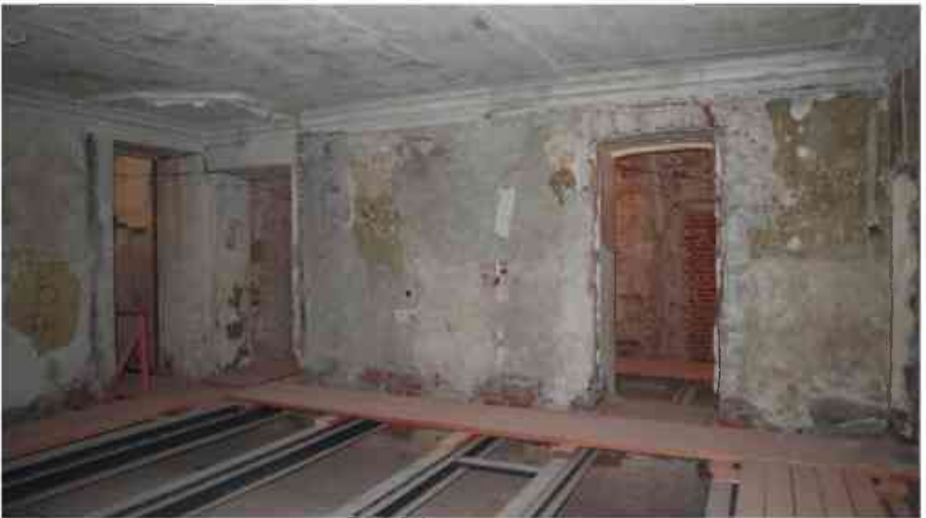
Фото 4.94. 4 этаж, помещение 33Н (11), 36Н (5).
