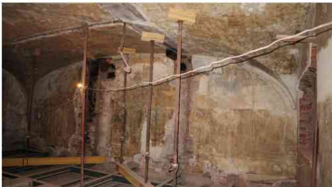
Фото 1.154. 1 этаж, помещение 31Н (16-17), 10Н (4-6).
