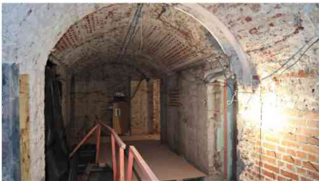
Фото 5.9. 5 этаж, помещение 37Н (1, 10-11), 35Н (18).
