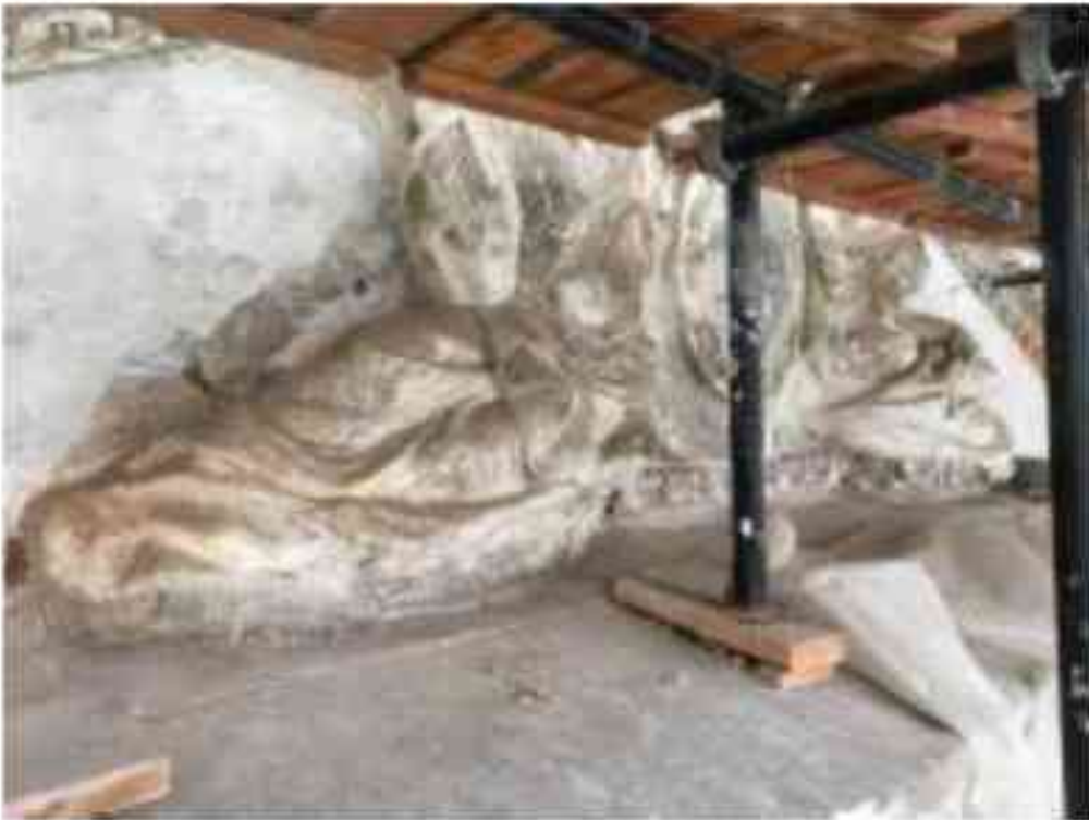
269. Фрагмент тимпана фронтона южного фасада. Фото 2019 г.
