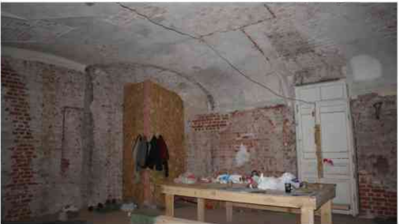
Фото 3.16. 3 этаж, помещение 28Н (40), 27Н (3).
