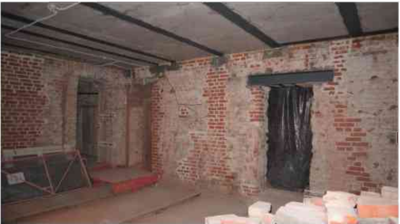
Фото 5.27. 5 этаж, помещение 37Н (9), 35Н (19).
