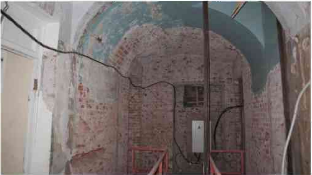
Фото 3.95. 3 этаж, помещение 28Н (41-42), 27Н (2).
