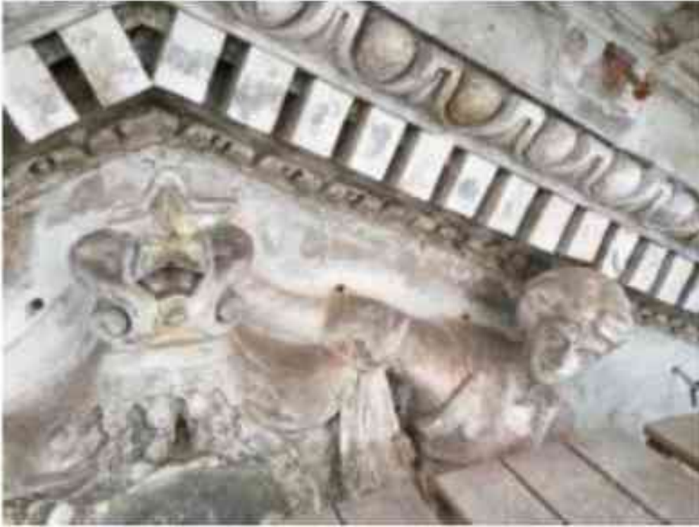
268. Фрагмент тимпана фронтона южного фасада. Фото 2019 г.
