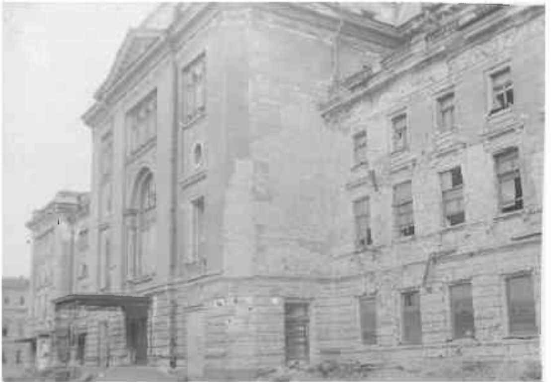
Ил. 186. Часть главного фасада здания Ленинградской государственной консерватории имени Н.А. Римского-Корсакова (Театральная пл., 3), поврежденного артиллерийским обстрелом. Дата съемки: 1944 г. Автор съемки неизвестен. ЦГА КФФД. Вр 662. КГИОП. 16467/2.
