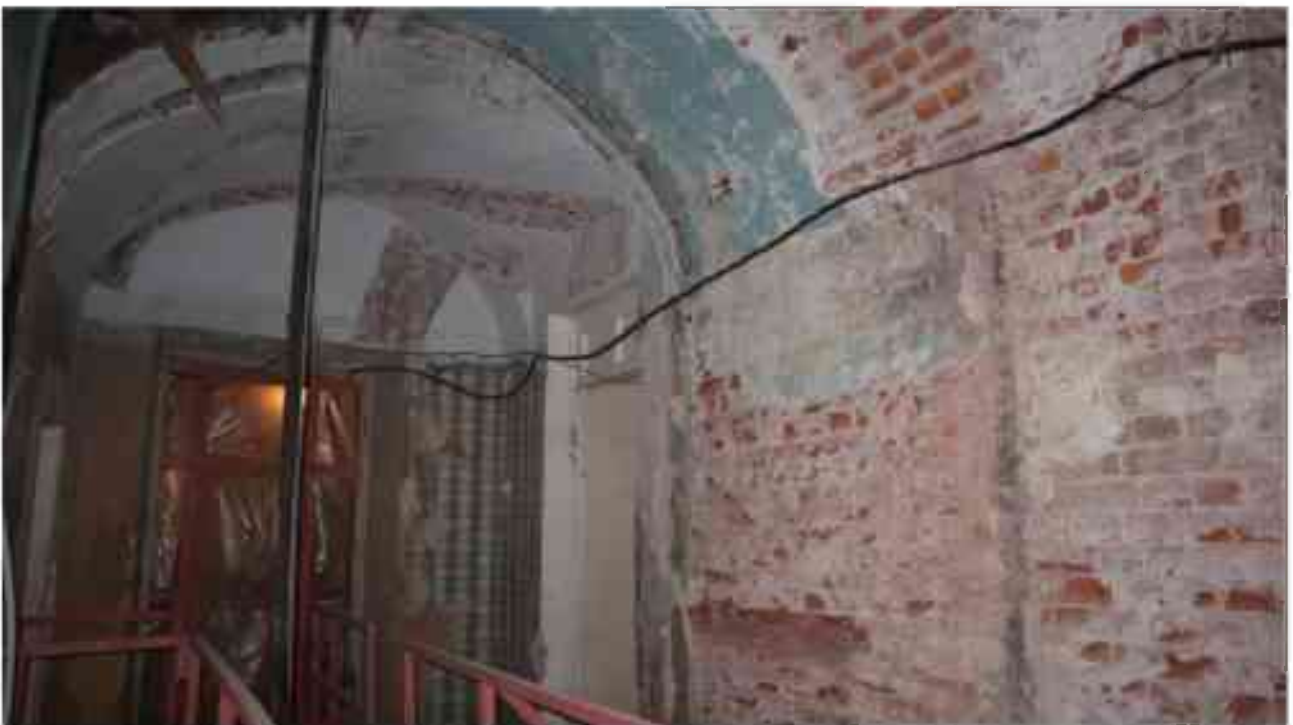
Фото 3.96. 3 этаж, помещение 28Н (41-42), 27Н (2).
