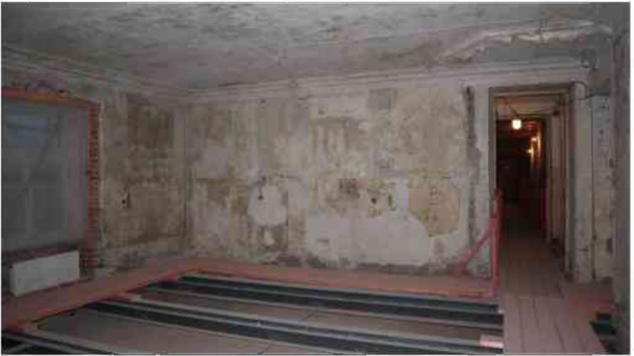
Фото 4.93. 4 этаж, помещение 33Н (11), 36Н (5).
