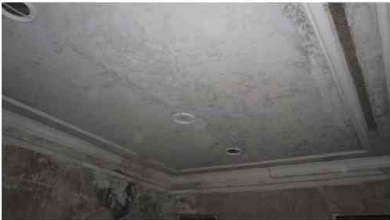
Фото 4.18. 4 этаж, плафон, помещение 33Н (38).
