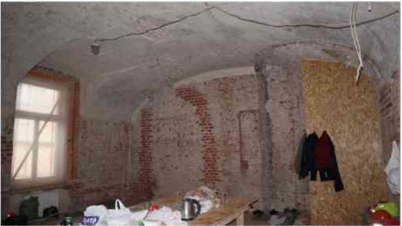
Фото 3.15. 3 этаж, помещение 28Н (40), 27Н (3).
