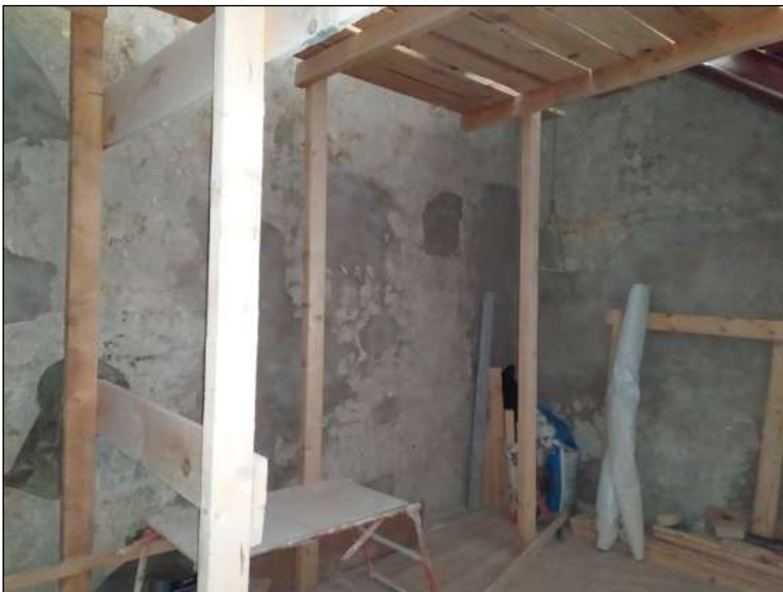
4. Колокольня Иоанновского монастыря. Интерьер 1-го яруса. Состояние стен. Фото Н.М.Петуховой 24.11.2021г.
