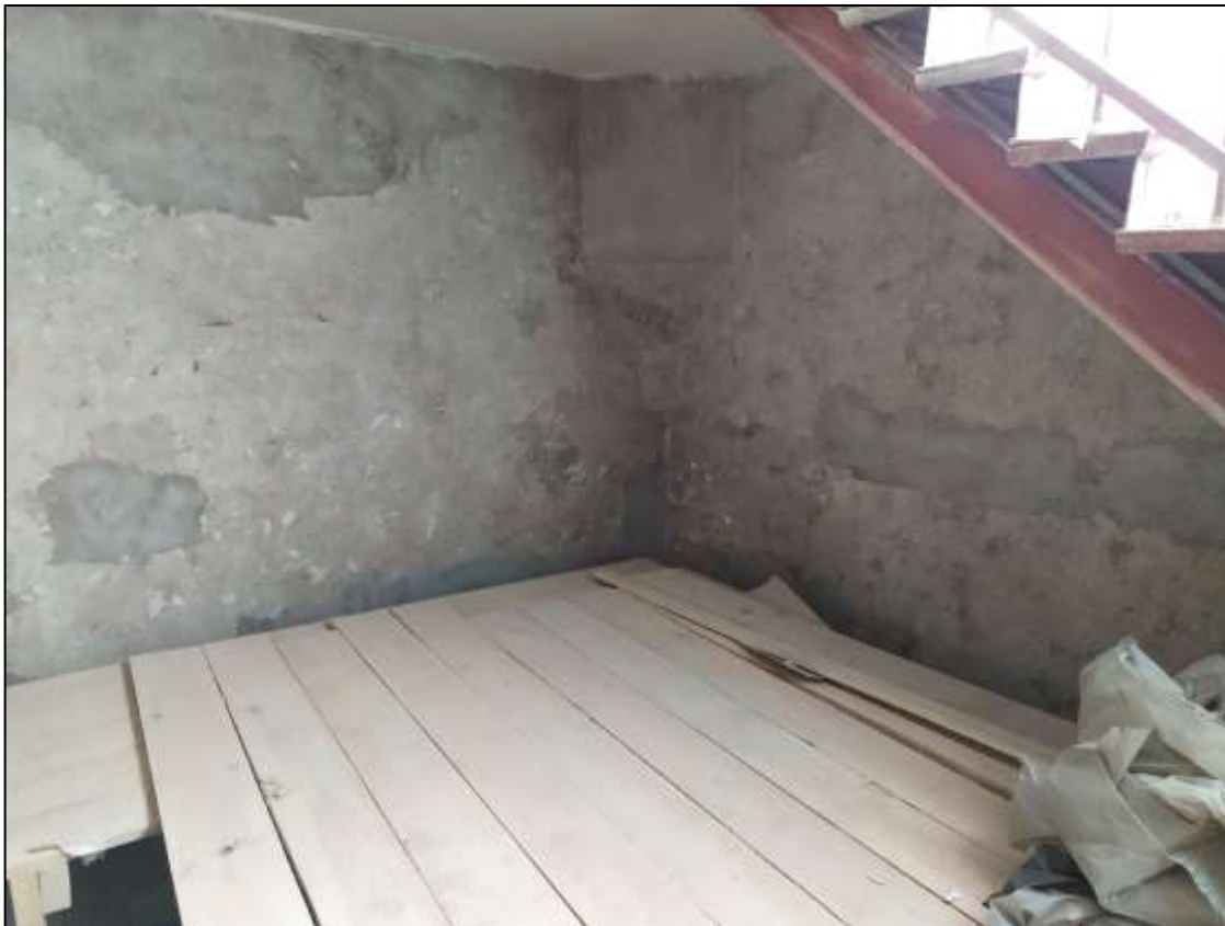
5. Колокольня Иоанновского монастыря. Интерьер 1-го яруса. Стены расчищены от красочных наслоений. Фото Н.М.Петуховой 24.11.2021г.
