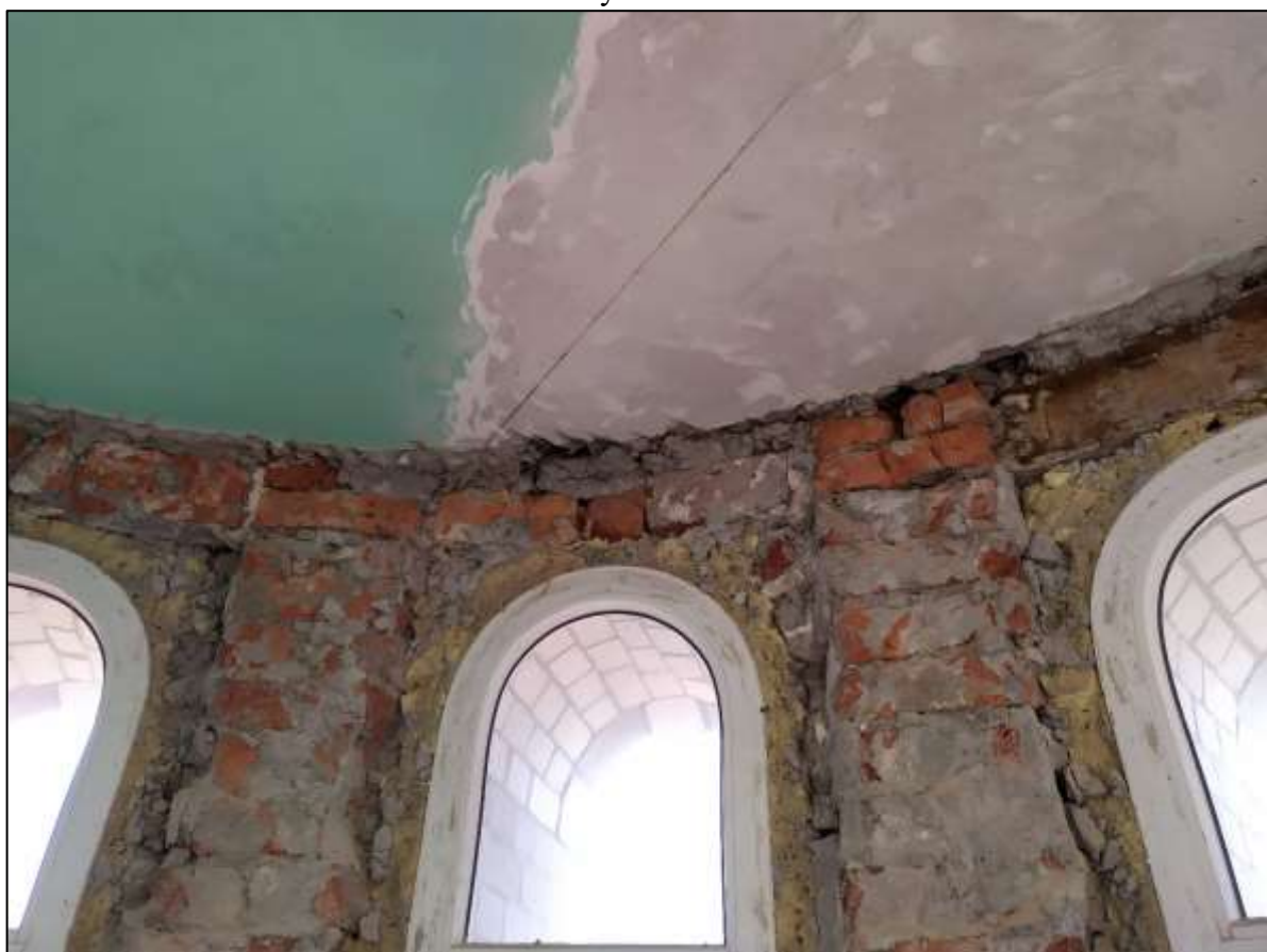
19. Колокольня Иоанновского монастыря. Интерьер 4-го яруса. Состояние кладки стен. Фото Н.М.Петуховой 24.11.2021г.
