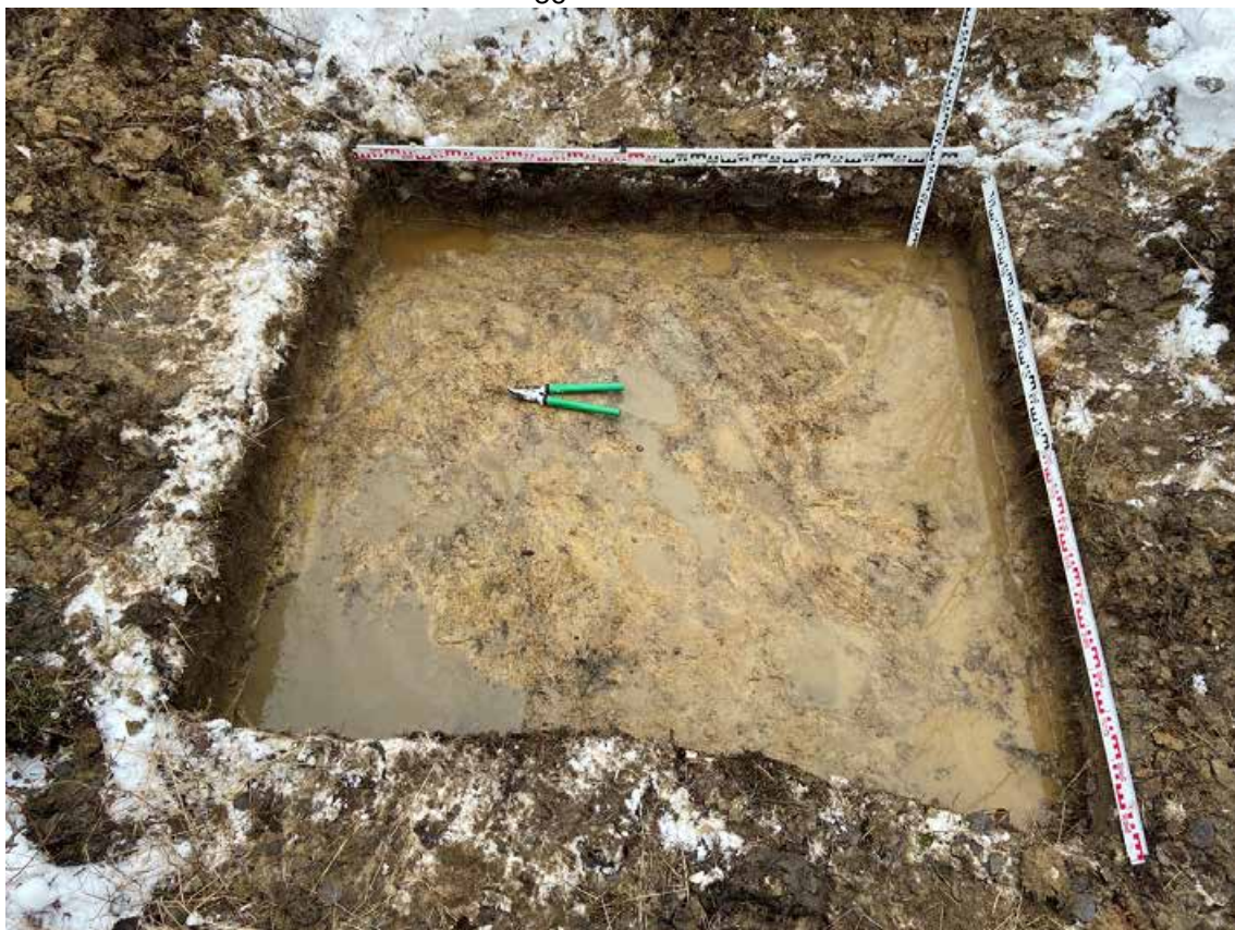
Рис. 31. Санкт-Петербург, «Строительство участка Красносельско-Калининской линии метрополитена от станции «Казаковская» до станции «Сосновая поляна»», площадка 14. Шурф №1. Фиксация по матерiku. Вид на восток.
