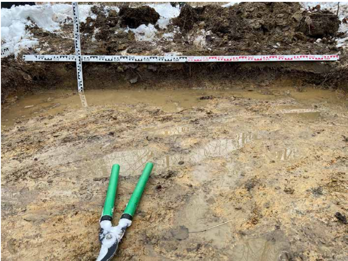
Рис. 34. Санкт-Петербург, «Строительство участка Красносельско-Калининской линии метрополитена от станции «Казаковская» до станции «Сосновая поляна»», площадка 14. Шурф №1. Южная стенка.
