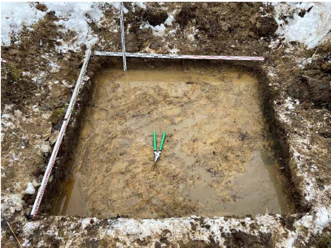
Рис. 30. Санкт-Петербург, «Строительство участка Красносельско-Калининской линии метрополитена от станции «Казаковская» до станции «Сосновая поляна»», площадка 14. Шурф №1. Фиксация по матерiku. Вид на юг.
