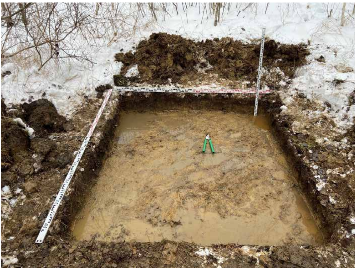
Рис. 28. Санкт-Петербург, «Строительство участка Красносельско-Калининской линии метрополитена от станции «Казаковская» до станции «Сосновая поляна»», площадка 14. Шурф №1. Фиксация по матерiku. Вид на север.
