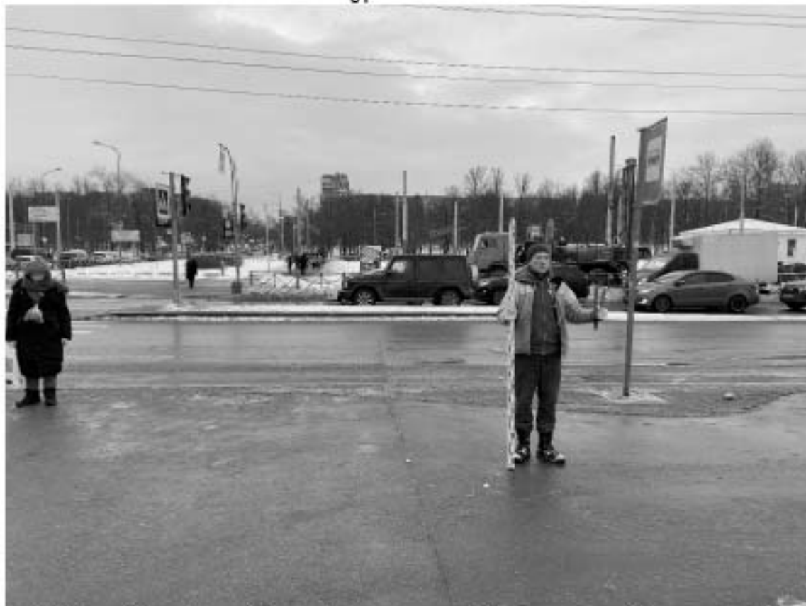
Рис. 29. Санкт-Петербург, «Строительство участка Красносельско-Калининской линии метрополитена от станции «Казаковская» до станции «Сосновая поляна»», площадка 18. Общий вид участка обследования. Точка съемки 6. Вид на юг.
