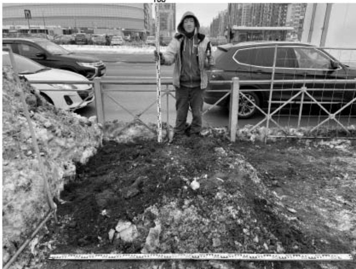
Рис. 47 Санкт-Петербург, «Строительство участка Красносельско-Калининской линии метрополитена от станции «Казановская» до станции «Сосновая поляна»», площадка 18. Шурф №1. Общий вид после рекультивации.
