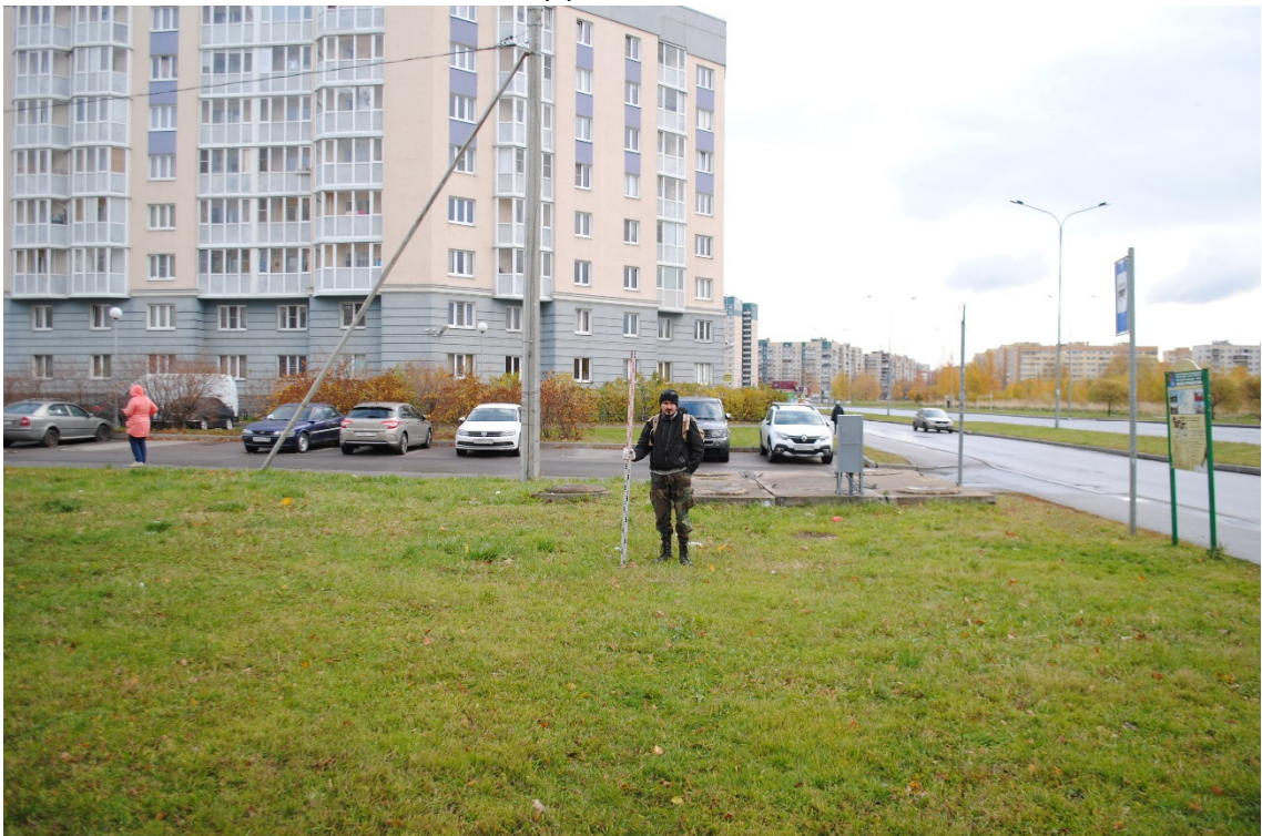
Рис. 11. Санкт-Петербург, «Строительство участка Красносельско-Калининской линии метрополитена от станции «Казаковская» до станции «Сосновая поляна»», площадка 20. Общий вид участка обследования. Точка съемки 1. Вид на восток
