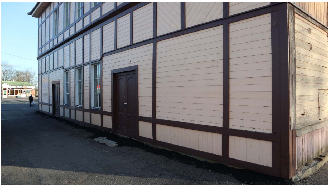
Фото 5. Западный фасад, первый этаж. Габариты исторических дверных проёмов нарушены, проёмы без фрамуги.
