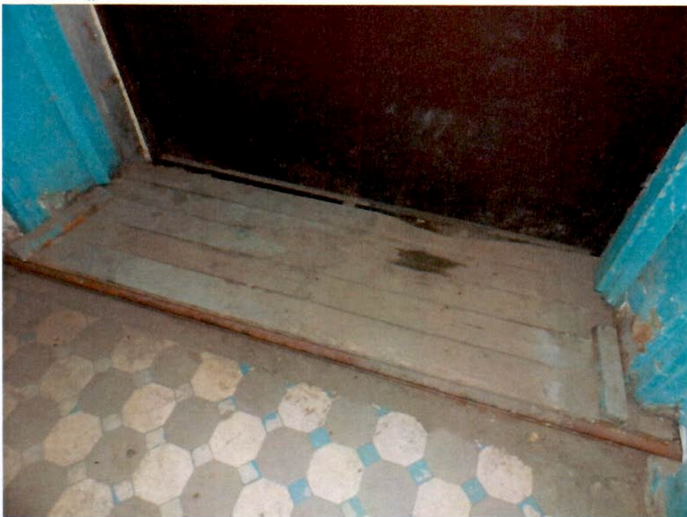
14. Порог парадного входа
