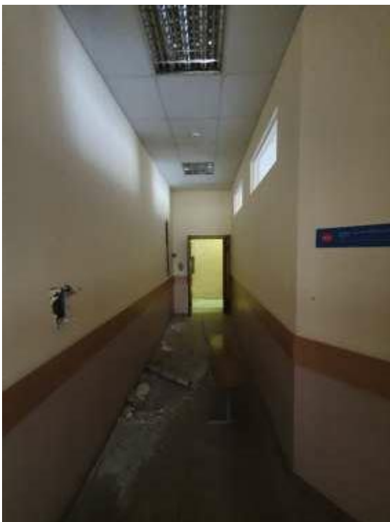
39. «Здание Коммерческого училища (с оградой)», ул. Ломоносова, д. 9, лит. А. Помещение №204. Фрагмент. Фото 01.12.2020 г.
