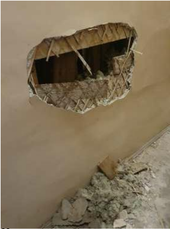
29. «Здание Коммерческого училища (с оградой)», ул. Ломоносова, д. 9, лит. А. Помещение №204. Фрагмент. Фото 01.12.2020 г.
