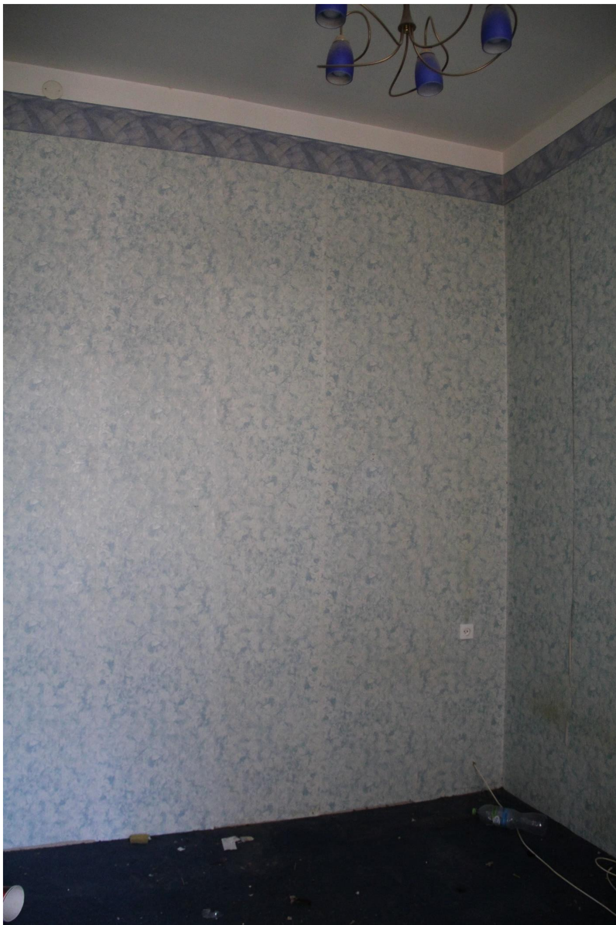
Фото 20. Вид на несущую перегородку в помещении № 6, в которой за декоративной отделкой находится дверной проем с заполнением.
