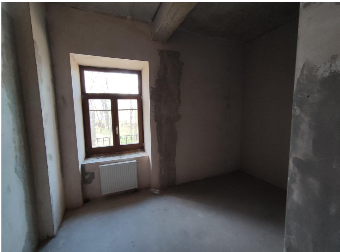
Фото 51. Объект культурного наследия регионального значения «Дачный дом», расположенный по адресу: г. Санкт-Петербург, проспект Энгельса, дом 4, корпус 2, литера А. Общий вид пом. № 4-Н(16), 2 этаж.
