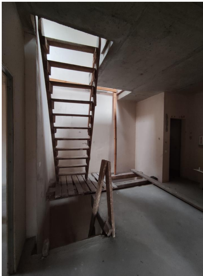
Фото 57. Объект культурного наследия регионального значения «Дачный дом», расположенный по адресу: г. Санкт-Петербург, проспект Энгельса, дом 4, корпус 2, литера А. Общий вид пом. № 3-Н(11), 2 этаж.
