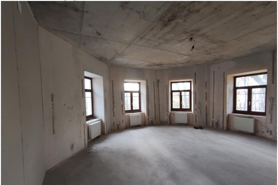
Фото 56. Объект культурного наследия регионального значения «Дачный дом», расположенный по адресу: г. Санкт-Петербург, проспект Энгельса, дом 4, корпус 2, литера А. Общий вид пом. № 3-Н(16), 2 этаж.
