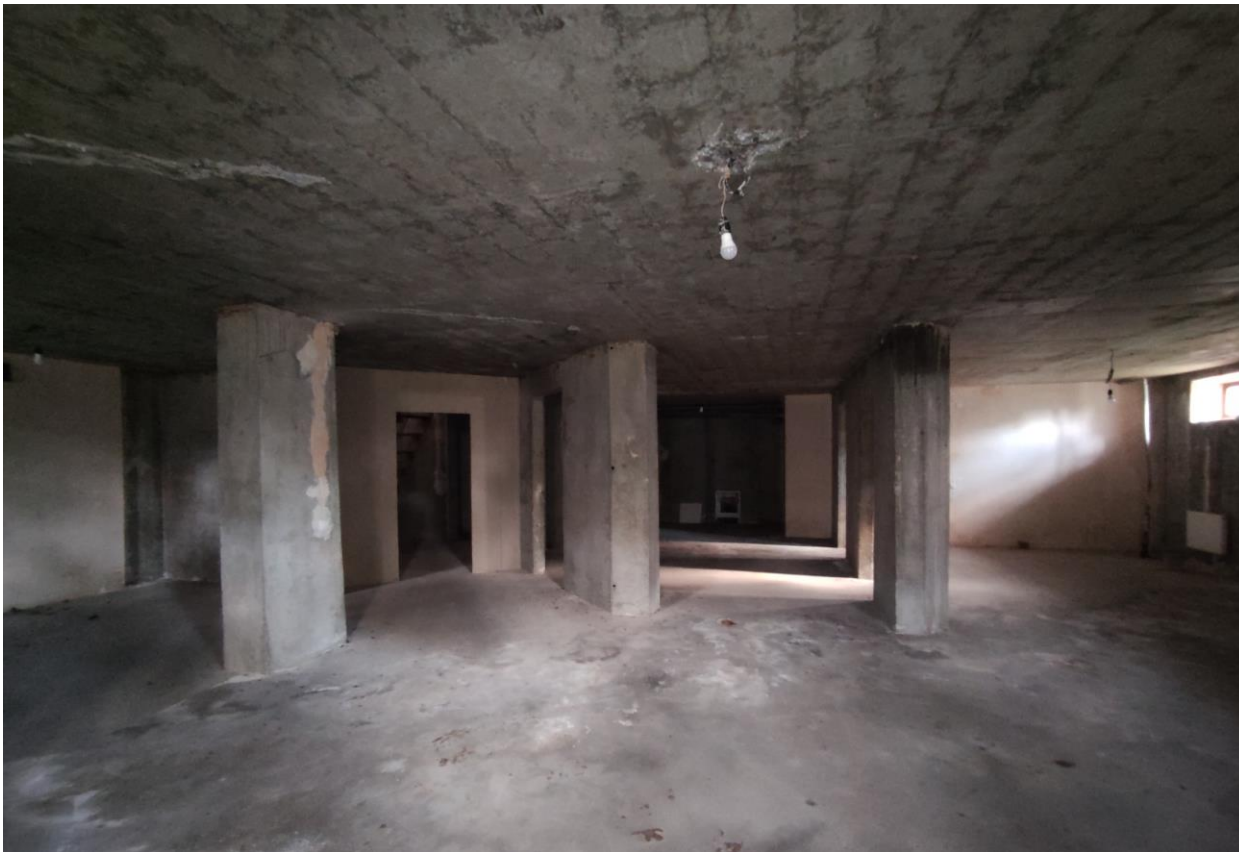
Фото 11. Объект культурного наследия регионального значения «Дачный дом», расположенный по адресу: г. Санкт-Петербург, проспект Энгельса, дом 4, корпус 2, литера А. Фрагмент пом. № 3-Н(5), подвал.
