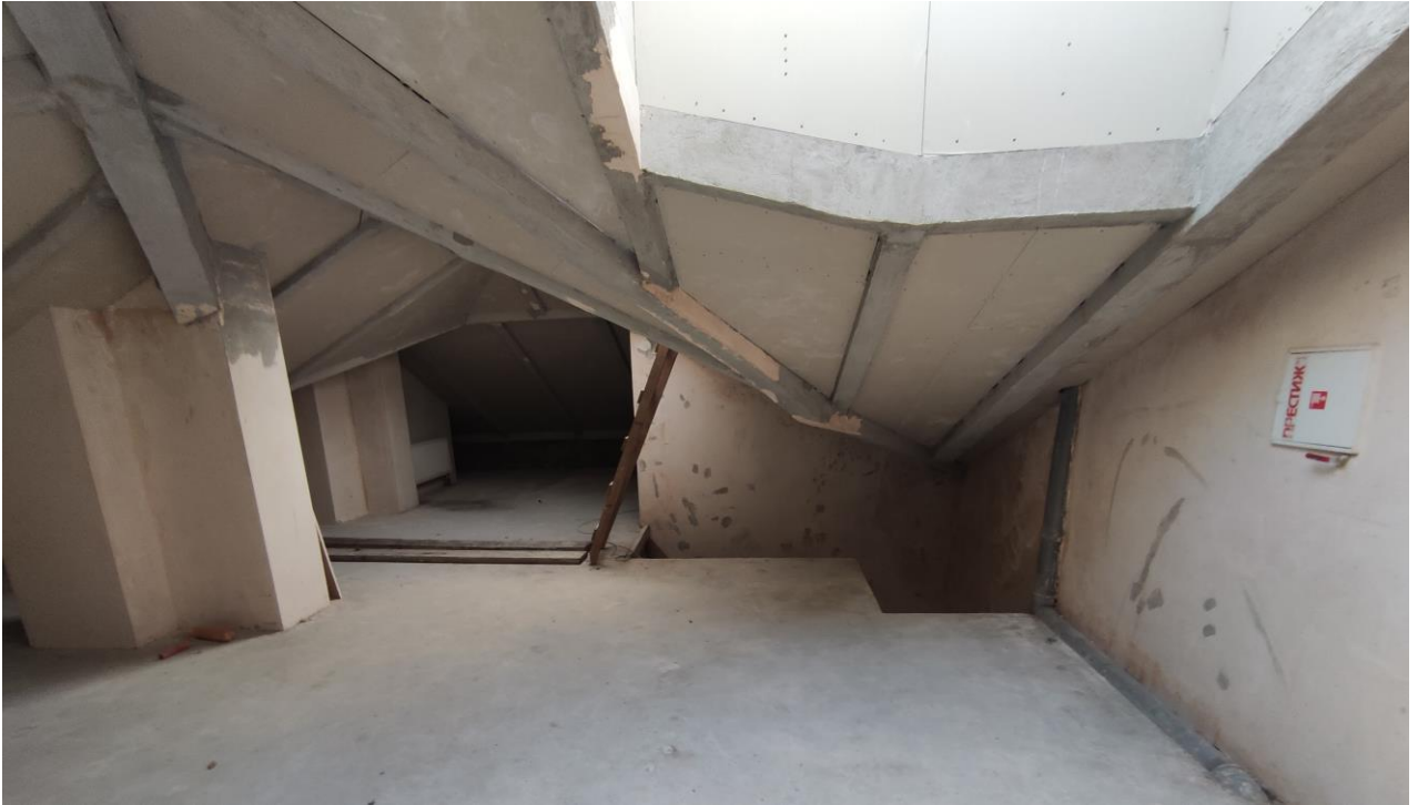
Фото 61. Объект культурного наследия регионального значения «Дачный дом», расположенный по адресу: г. Санкт-Петербург, проспект Энгельса, дом 4, корпус 2, литера А. Общий вид пом. № 2-Н(19), мансарда.
