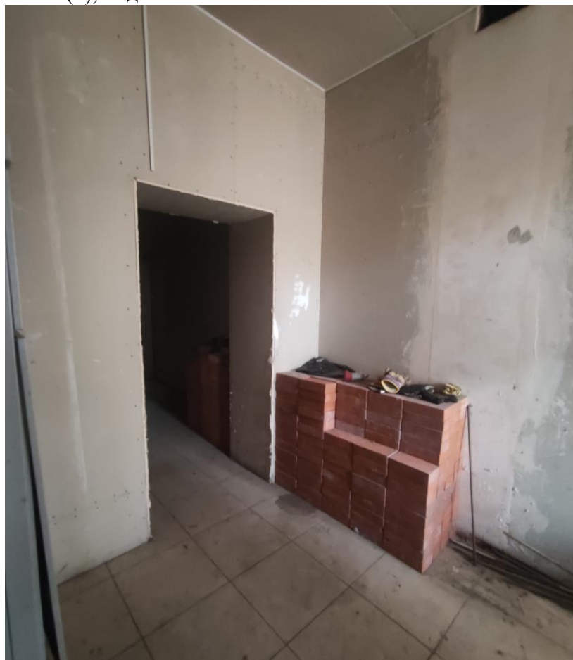
Фото 26. Объект культурного наследия регионального значения «Дачный дом», расположенный по адресу: г. Санкт-Петербург, проспект Энгельса, дом 4, корпус 2, литера А. Общий вид пом. № б/н(1), 1 этаж.
