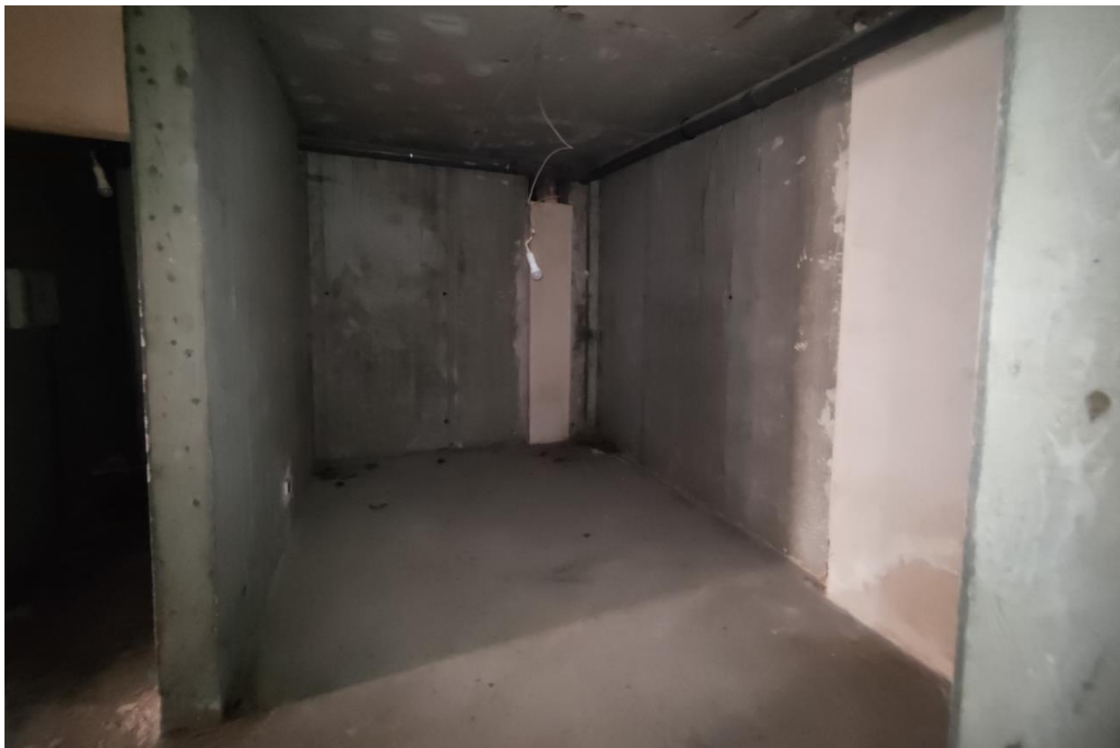
Фото 25. Объект культурного наследия регионального значения «Дачный дом», расположенный по адресу: г. Санкт-Петербург, проспект Энгельса, дом 4, корпус 2, литера А. Общий вид пом. № 2-Н(1), подвал.
