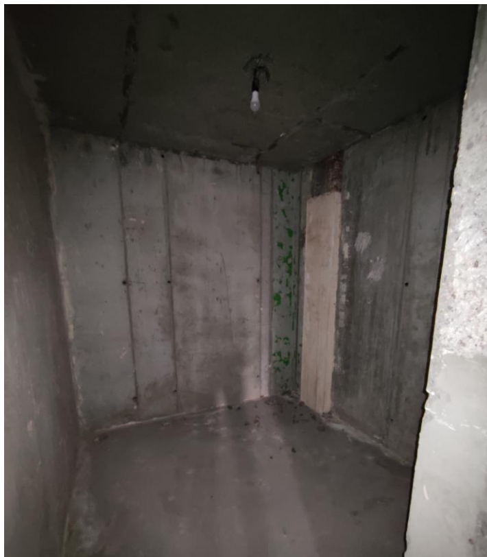
Фото 13. Объект культурного наследия регионального значения «Дачный дом», расположенный по адресу: г. Санкт-Петербург, проспект Энгельса, дом 4, корпус 2, литера А. Общий вид пом. № 3-Н(3), подвал.
