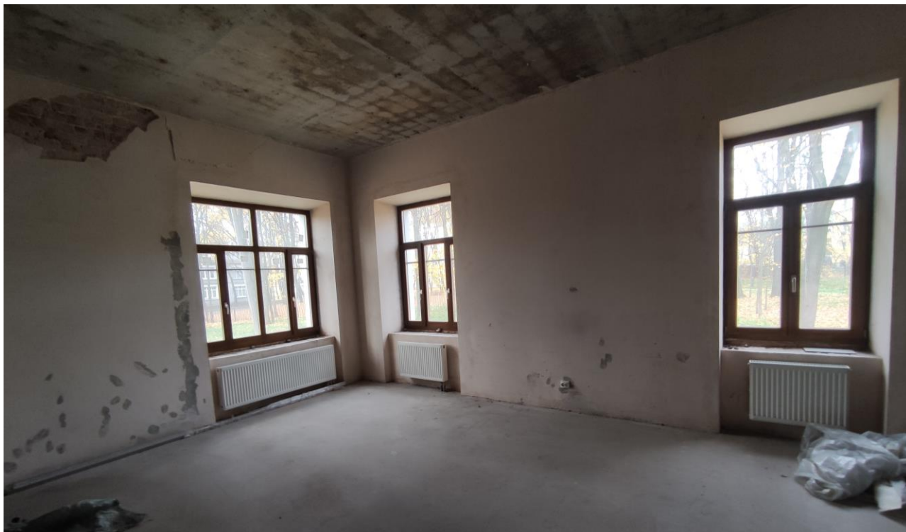
Фото 35. Объект культурного наследия регионального значения «Дачный дом», расположенный по адресу: г. Санкт-Петербург, проспект Энгельса, дом 4, корпус 2, литера А. Общий вид пом. № 4-Н(7), 1 этаж.
