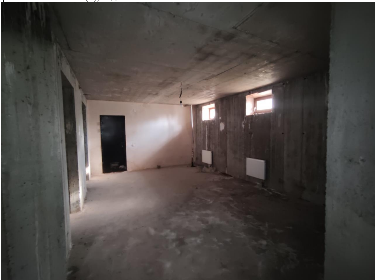
Фото 12. Объект культурного наследия регионального значения «Дачный дом», расположенный по адресу: г. Санкт-Петербург, проспект Энгельса, дом 4, корпус 2, литера А. Фрагмент пом. № 3-Н(5), подвал.
