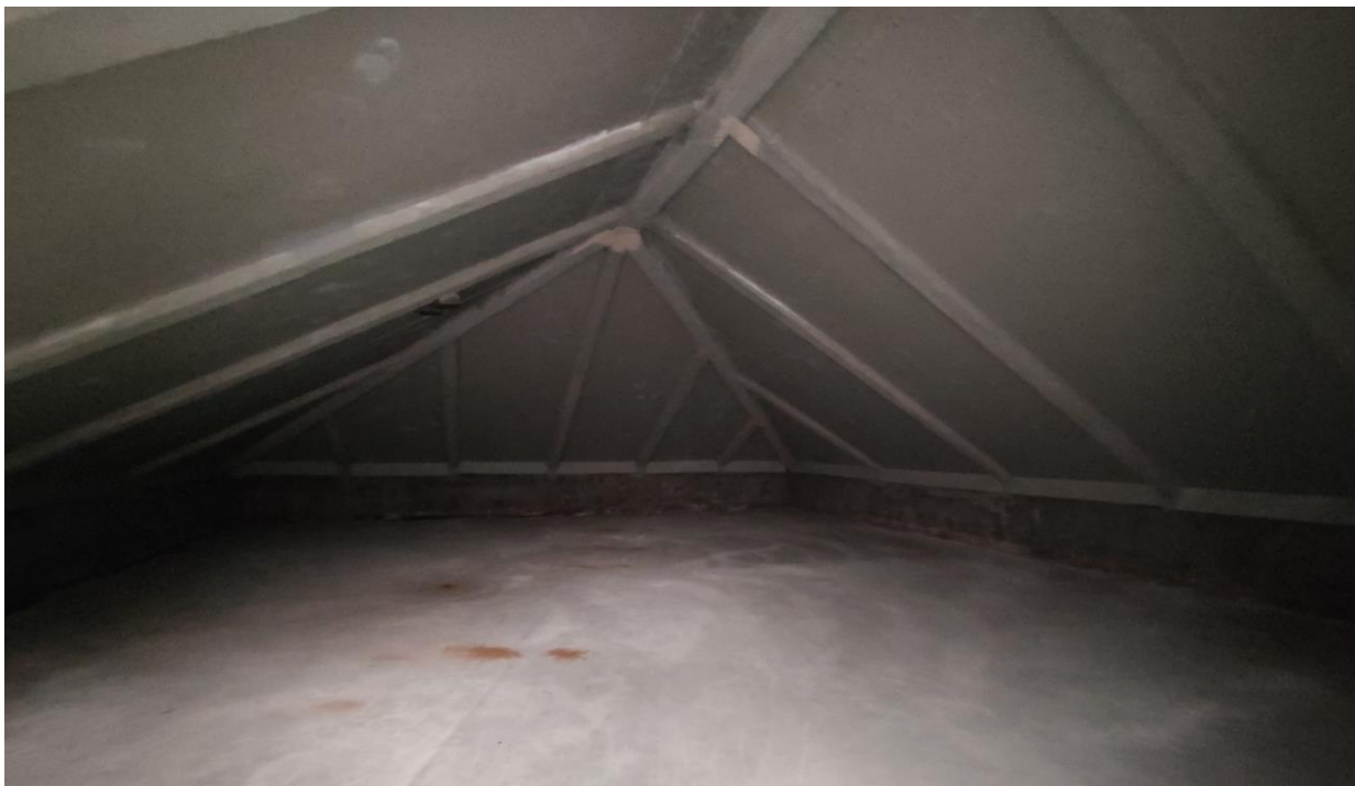
Фото 63. Объект культурного наследия регионального значения «Дачный дом», расположенный по адресу: г. Санкт-Петербург, проспект Энгельса, дом 4, корпус 2, литера А. Фрагмент пом. № 2-Н(19), мансарда.
