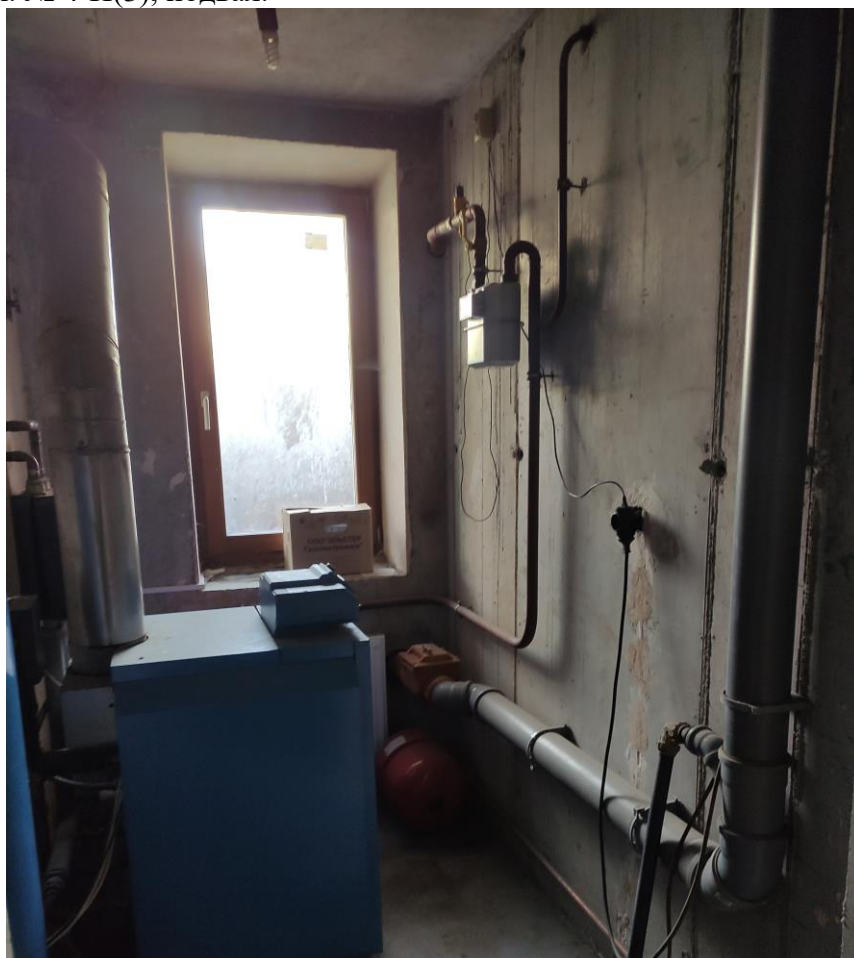
Фото 18. Объект культурного наследия регионального значения «Дачный дом», расположенный по адресу: г. Санкт-Петербург, проспект Энгельса, дом 4, корпус 2, литера А. Общий вид пом. № 4-Н(4), подвал.
