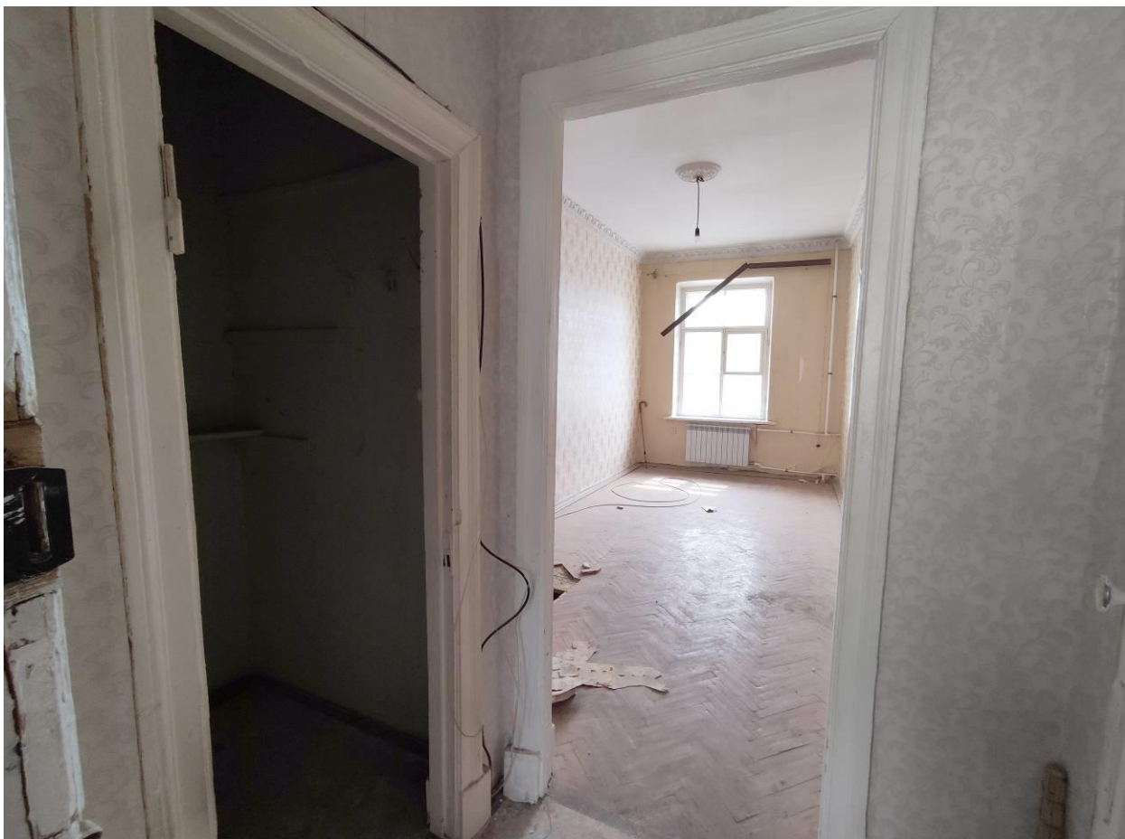
Фото 15. Интерьер квартиры, ч.п. 7. Вид на вход в ч.п. 3,4
