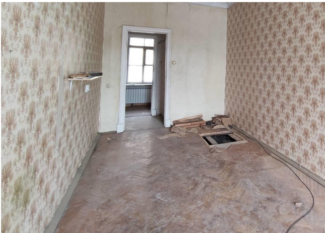
Фото 16. Интерьер квартиры, ч.п. 4. Вид на вход в ч.п. 2,7
