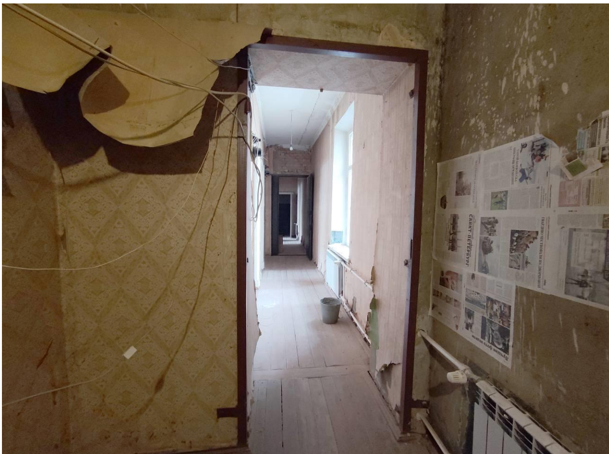
Фото 13. Интерьер квартиры, ч.п. 1. Вид на вход в ч.п. 7
