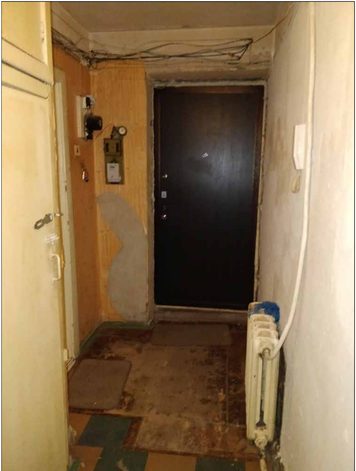
21.Выявленный объект культурного наследия «Дом Ц.А. Кавоса (А. И. Сулова)». Квартира № 5. Помещение № 1. Вход в квартиру. Вид от входа в помещение № 10. 19.08.2021 г.
