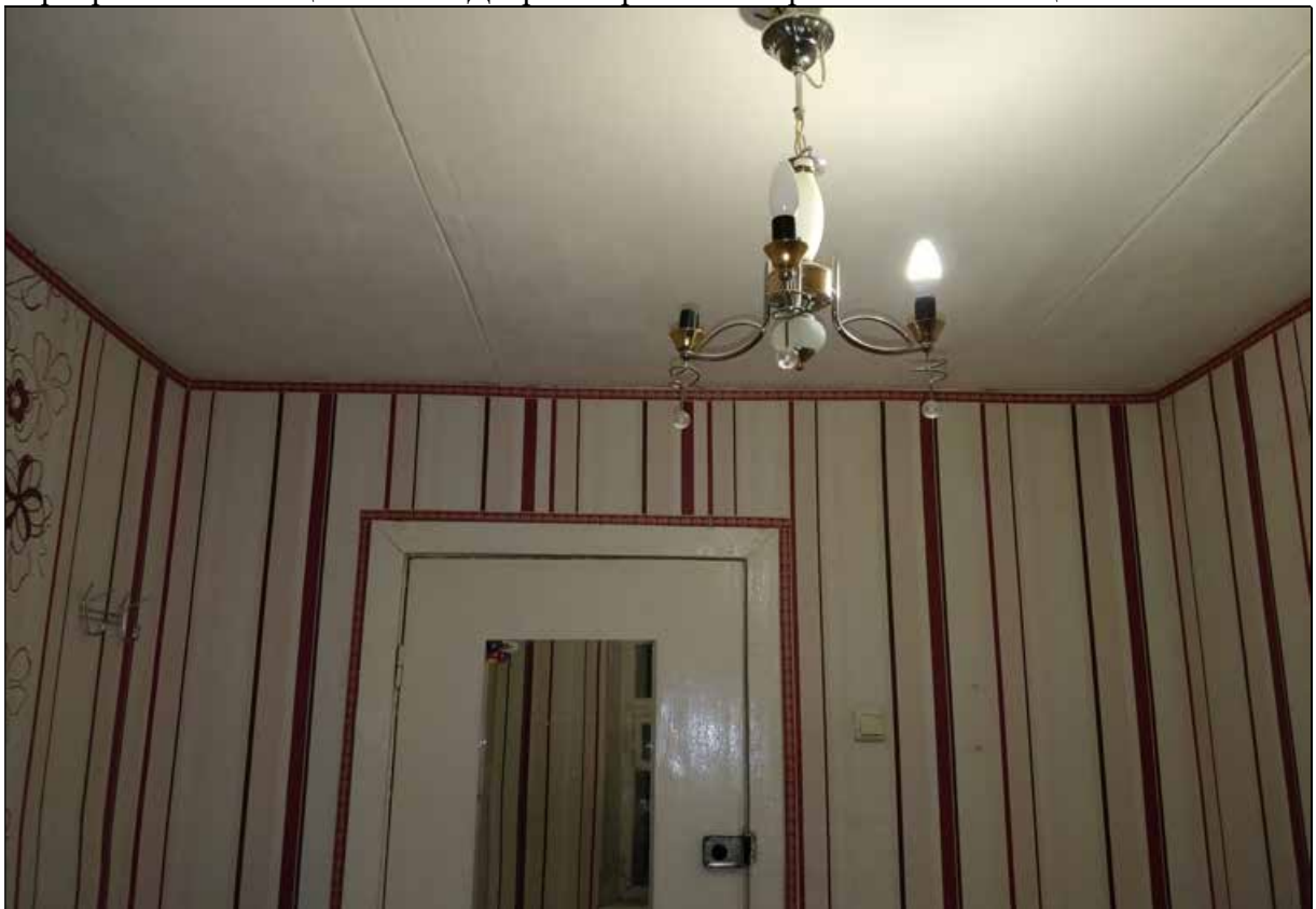
29. Выявленный объект культурного наследия «Дом Ц.А. Кавоса (А. И. Сулова)». Квартира № 5. Помещение № 8. Потолок. 19.08.2021 г.
