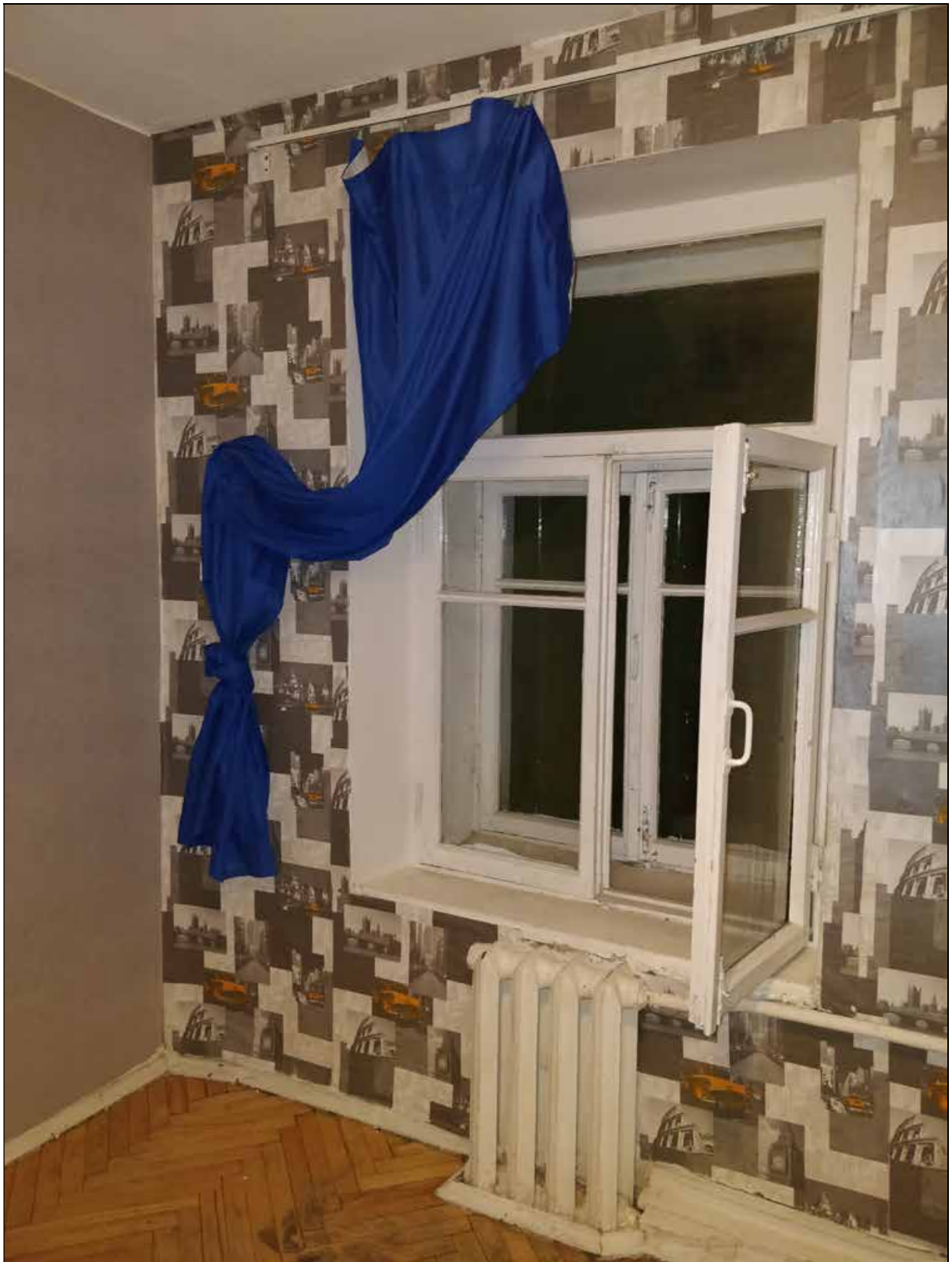
36. Выявленный объект культурного наследия «Дом Ц.А. Кавоса (А. И. Сулова)». Квартира № 5. Помещение № 10. Оконный проем в юго-восточной части помещения. 19.08.2021 г.
