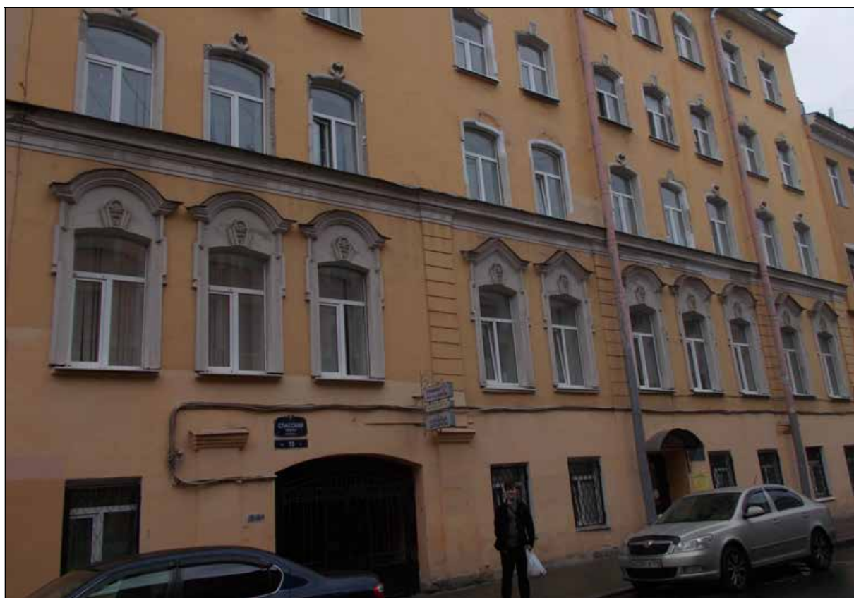
3. Выявленный объект культурного наследия «Дом Ц.А. Кавоса (А. И. Сулова)». Фрагмент лицевого фасада. Оконные проемы 1-го, 2-го и 3-го этажей. Вид от дома № 9 по Спасскому переулку. 19.08.2021 г.
