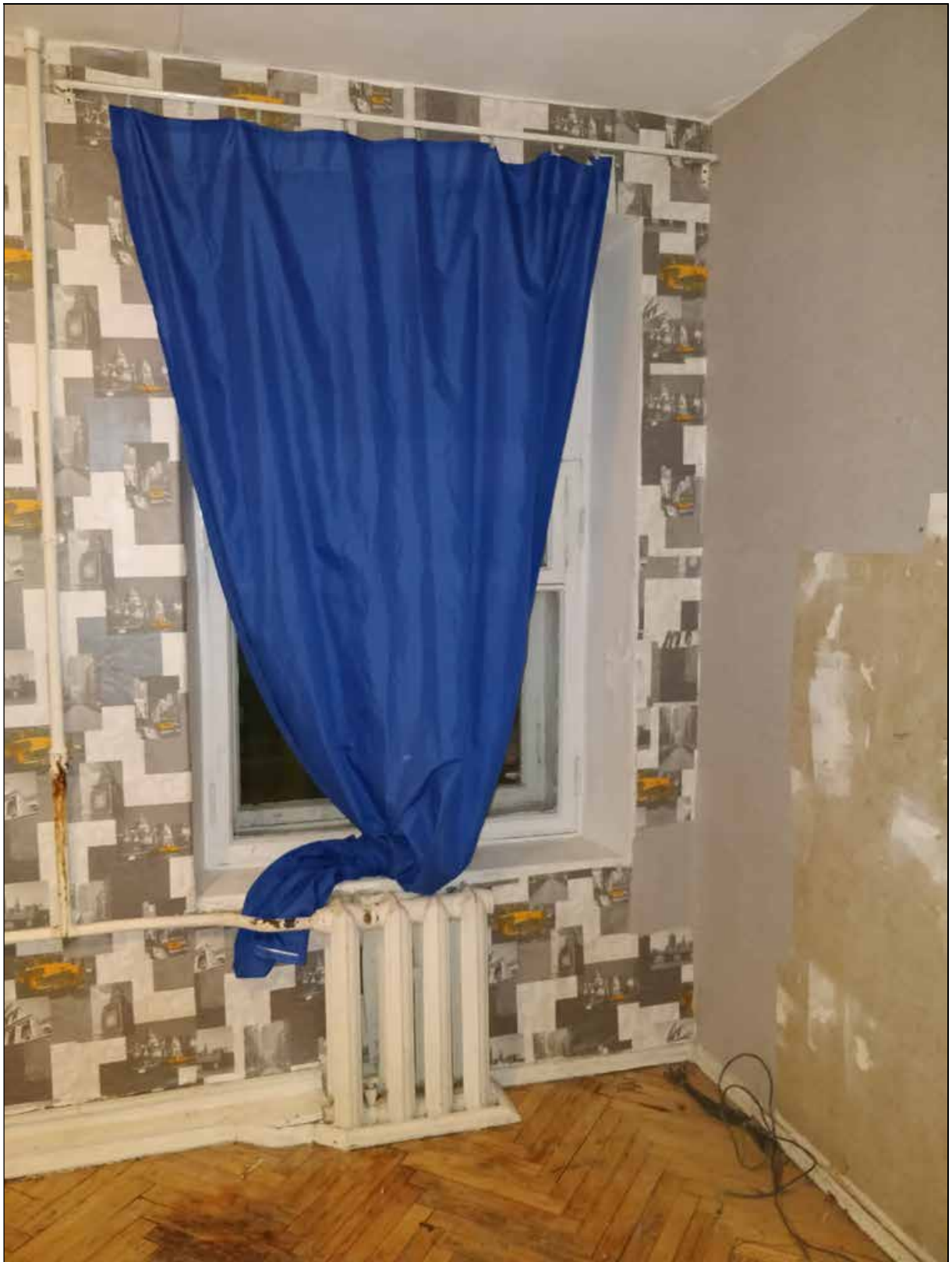
37. Выявленный объект культурного наследия «Дом Ц.А. Кавоса (А. И. Сулова)». Квартира № 5. Помещение № 10. Оконный проем в юго-западной части помещения. 19.08.2021 г.
