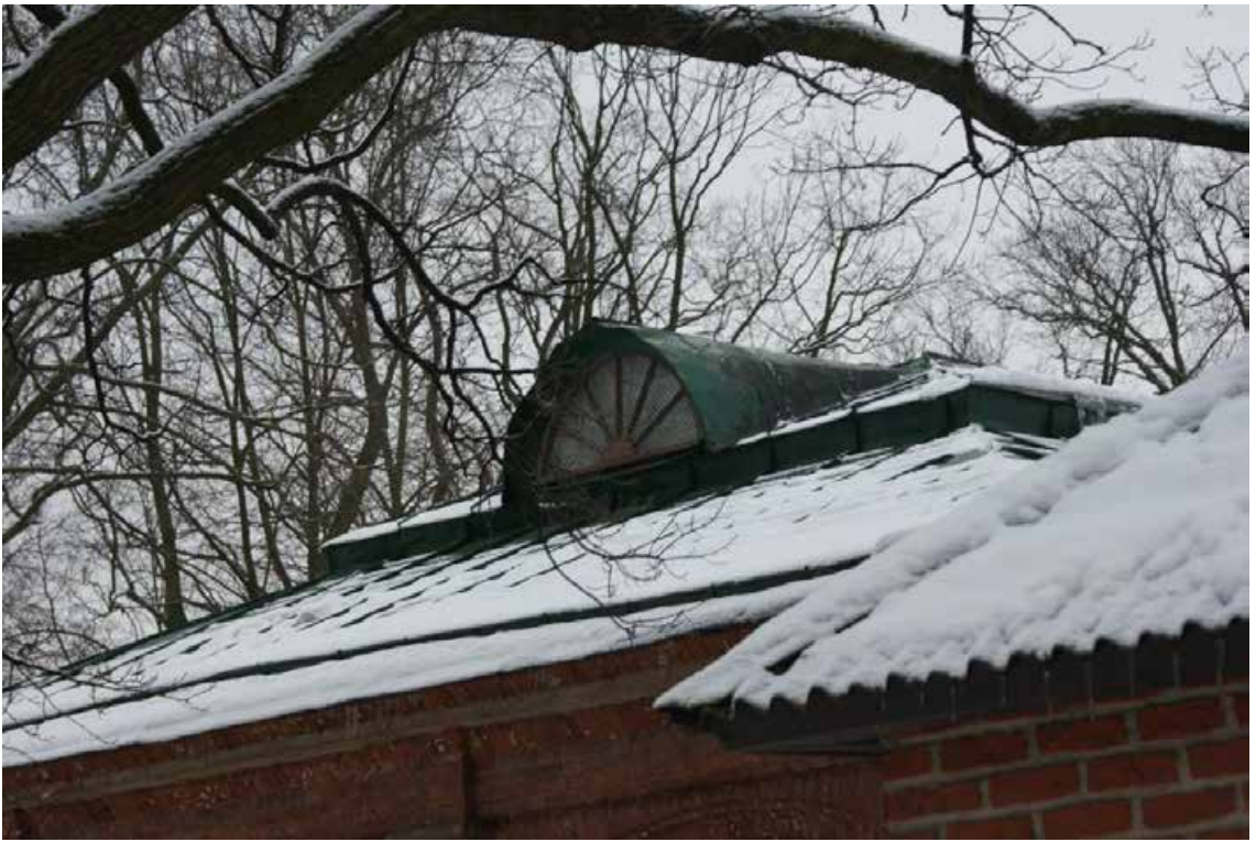
Фото 19. Объект культурного наследия «Футляр домика». Северо-восточный фрагмент фасада. Слуховое окно. Съемка 24.01.2022 г. Трушковский В.Э.
