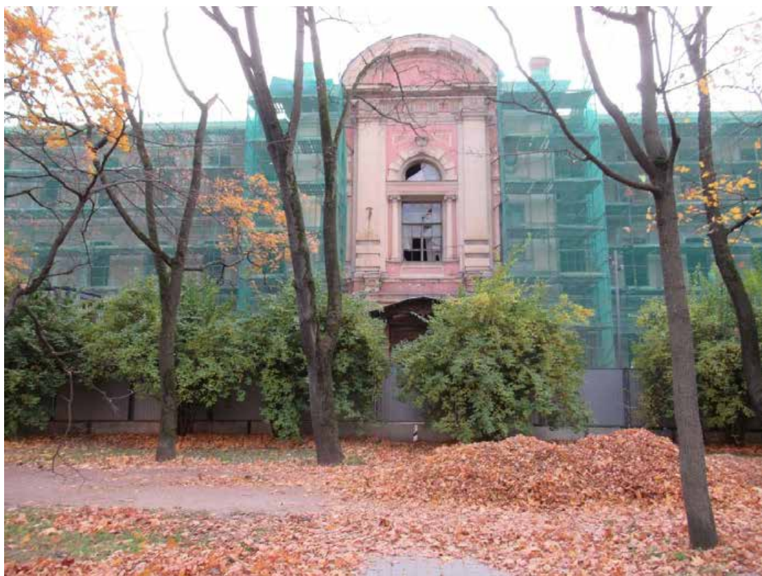
11. ОКН «Здание богадельни и школы Ф.М. Садовникова и С.Г. Герасимова», расположенный по адресу: г. Санкт-Петербург, Каменноостровский проспект, дом 66, лит. А. Восточный фасад. Дата фотофиксации: 15.10.2021.
