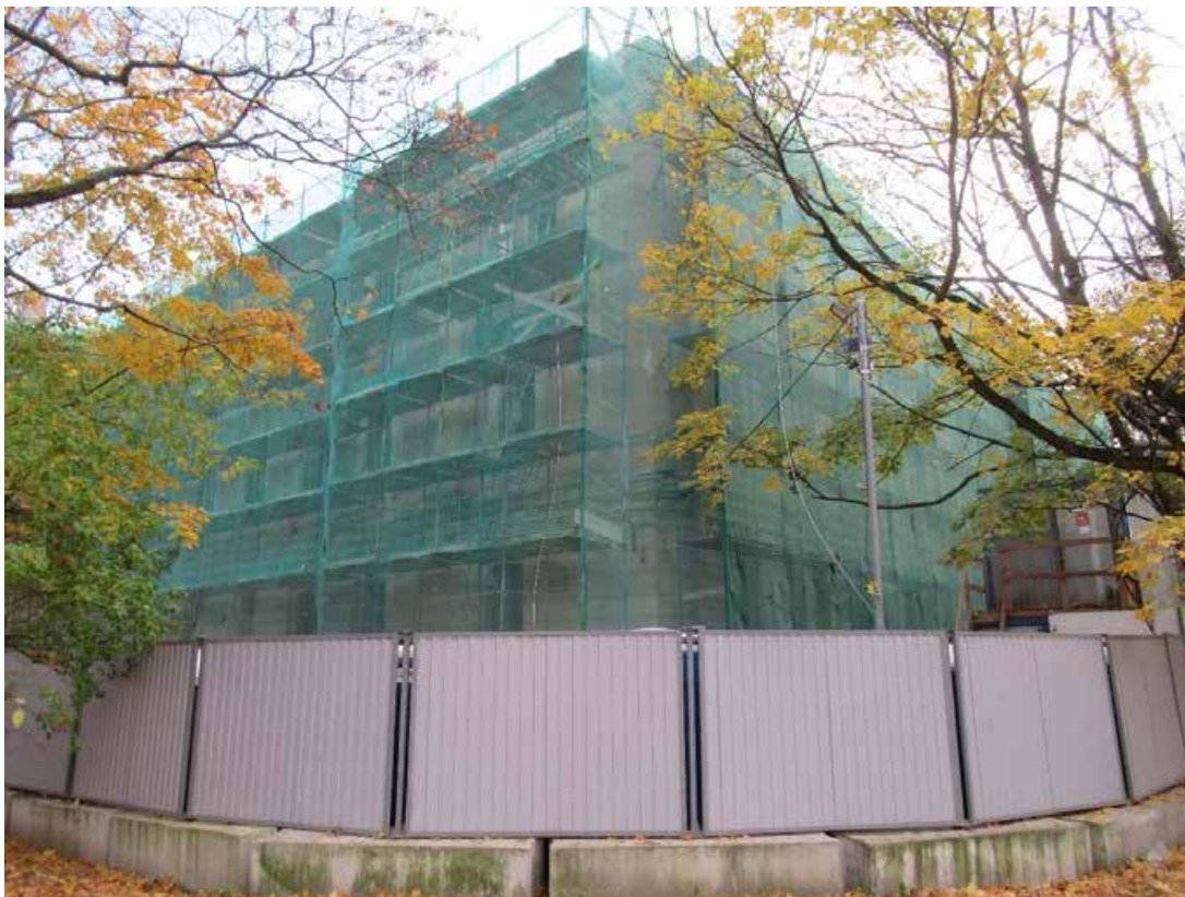
13. ОКН «Здание богадельни и школы Ф.М. Садовникова и С.Г. Герасимова», расположенный по адресу: г. Санкт-Петербург, Каменноостровский проспект, дом 66, лит. А. Восточный и северный фасады. Угол. Дата фотофиксации: 15.10.2021.
