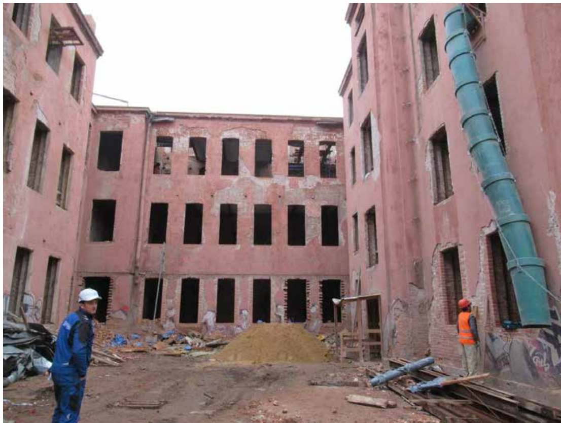
17. ОКН «Здание богадельни и школы Ф.М. Садовникова и С.Г. Герасимова», расположенный по адресу: г. Санкт-Петербург, Каменноостровский проспект, дом 66, лит. А. Дворовый фасад. Дата фотофиксации: 15.10.2021.
